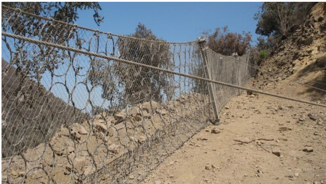
Barreras contra las caídas de rocas, sistema complejo de paneles en cable y red metálica de doble torsión para la contención de bloques desprendidos.
