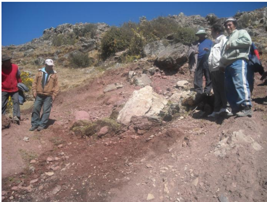
Fig. 7: Erosión de ladera del cerro Yanamancha producto del afloramiento de agua.
