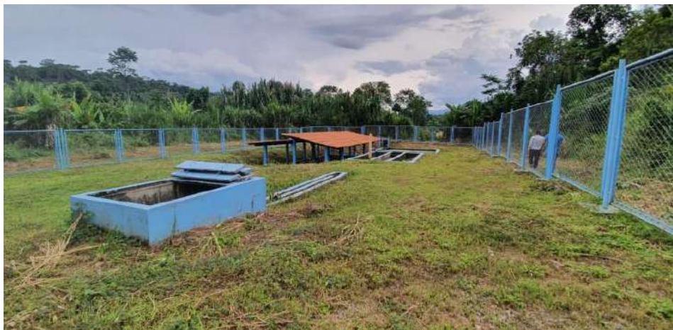
IMAGEN N°20. PLANTA DE TRATAMIENTO DE AGUAS RESIDUALES
