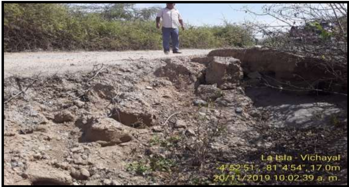
Imagen N° 09 : Dique Erosiona por efectos de Lluvias fuertes
