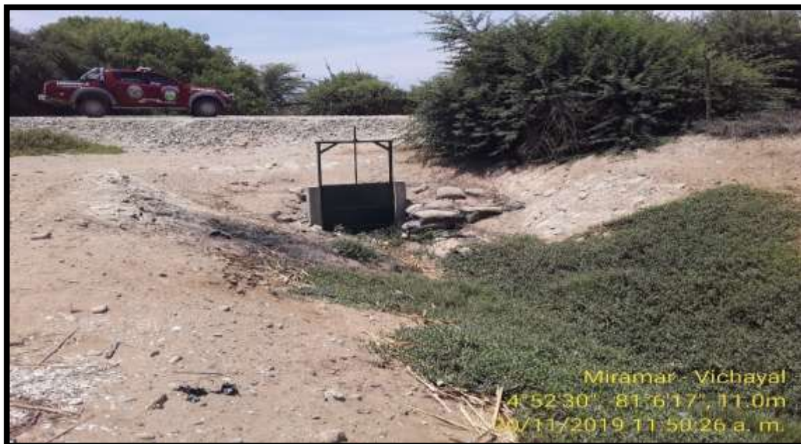
Imagen N° 34: Compuerta centro poblado Miramar
