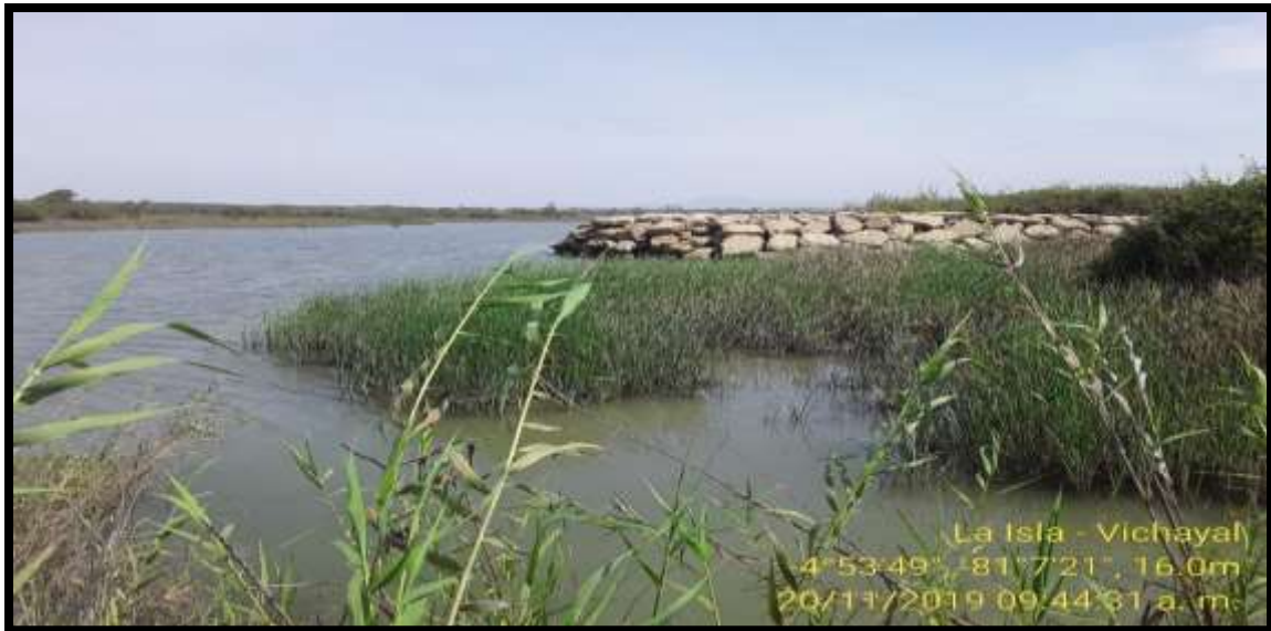
Imagen N°05: Espigón empotrado en dique margen izquierda del río
