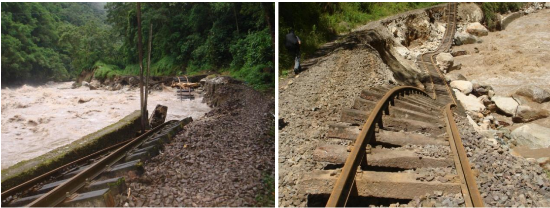
Foto A y B; Vista de la socavación y derrumbe de algunos tramos del ferrocarril.
