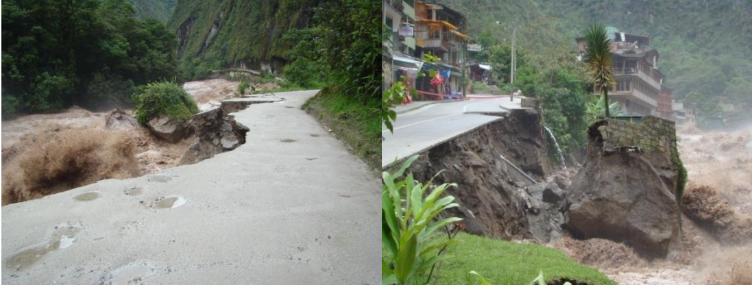
Foto A y B; Vista de la socavación y derrumbe de algunos tramos de la carretera hacia la ciudadela de Machupicchu.
