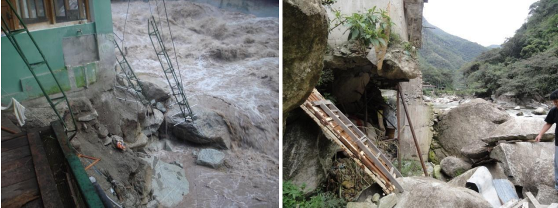
Foto A y B; Vista de la socavación del talud donde se ubica el Puesto de control del SERNANP y posteriores de viviendas de la Av. Imperio de los Incas.
