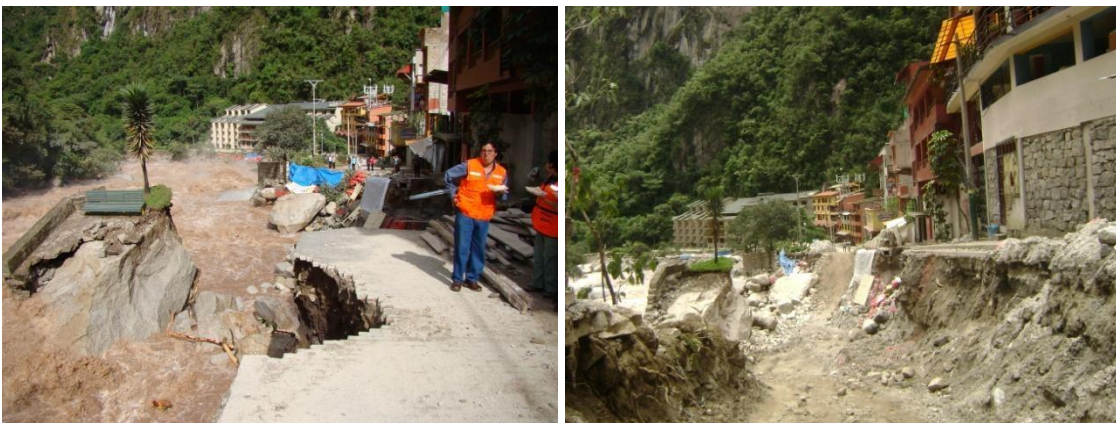
Foto A y B Vista de la socavación de la margen derecha del río Vilcanota.
