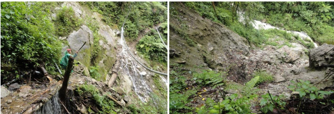
Ilustración 21. Vista del deslizamiento Antiguo Encatuyor
