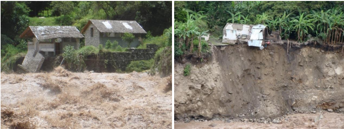
Foto A y B; Vista de la socavación y derrumbe de algunos sectores de las márgenes del río Vilcanota.
