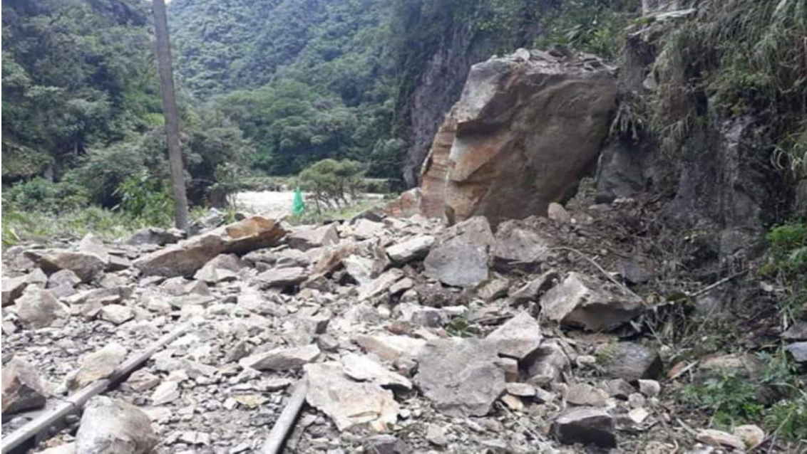
Ilustración 20. Derrumbe a consecuencia de las lluvias intensas que bloquean la vía férrea
