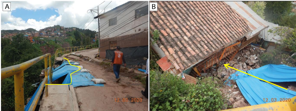
Figura 11. En A: Vista de un derrumbe en la Av. Los Pinos, en B: Vista de la vivienda afectada por el derrumbe.
