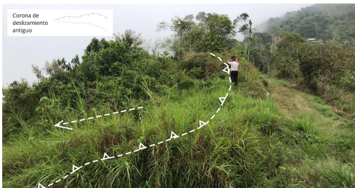
Figura 7. Escarpe principal de deslizamiento que afecta torre de alta tensión en San Emilio, cubierto por vegetación.
