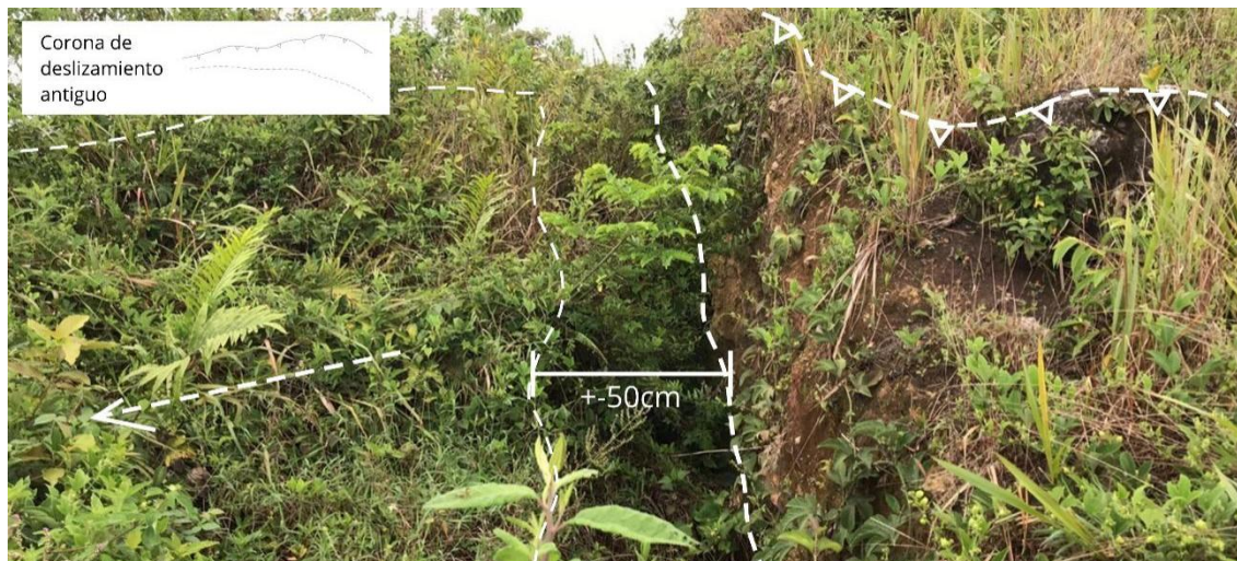
Figura 8. Separación del cuerpo deslizado visible en el escarpe principal de deslizamiento que afecta torre de alta tensión en San Emilio.
