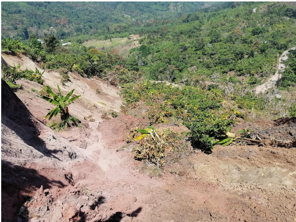
Fotografía 9: Vista ladera debajo de la masa deslizada que aún puede alcanzar la vía, por lo que debe ser retirada.
