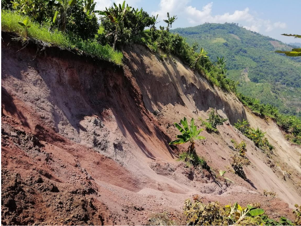
Fotografía 10: Escarpa principal. Nótese el elevado grado de meteorización de limoarcillitas rojas que han dado paso a suelos residuales.
