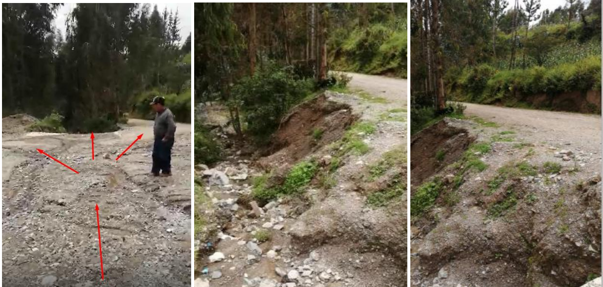
FOTO N° 07. LA DIRECCIÓN DEL FLUJO (PARTE BAJA DE LA QUEBRADA), SE DESBORDA A AMBAS MÁRGENES DEL CAUCE, AFECTANDO A LA CARRETERA DE CHILCAS
