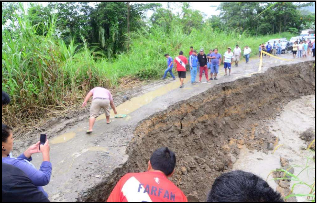
DESBORDE DEL RIO MARINTARI, AFECTADO LA VIA DISTRICTAL SANTA ROSA- PALMA PAMPA.
