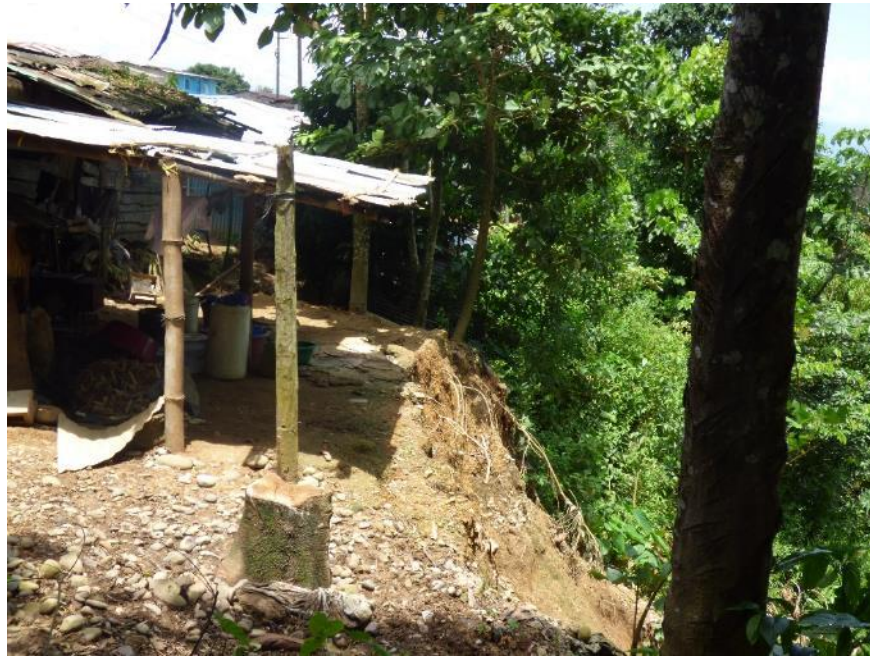
Fotografía 9. Viviendas del caserío Antonio Raymondi Las Vegas ubicadas muy próximas a las cárcavas, se puede observar la inclinación de los árboles que indican la inestabilidad del terreno debido a estos procesos. Vista al oeste
