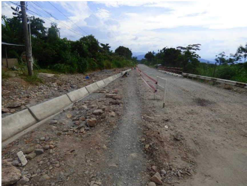
Fotografía 8. Carretera Federico Basadre, vía nacional que atraviesa el caserío Antonio Raymondi Las Vegas que fue afectada por las cárcavas, cuya rehabilitación se venía realizando durante la inspección en campo. Vista al oeste
