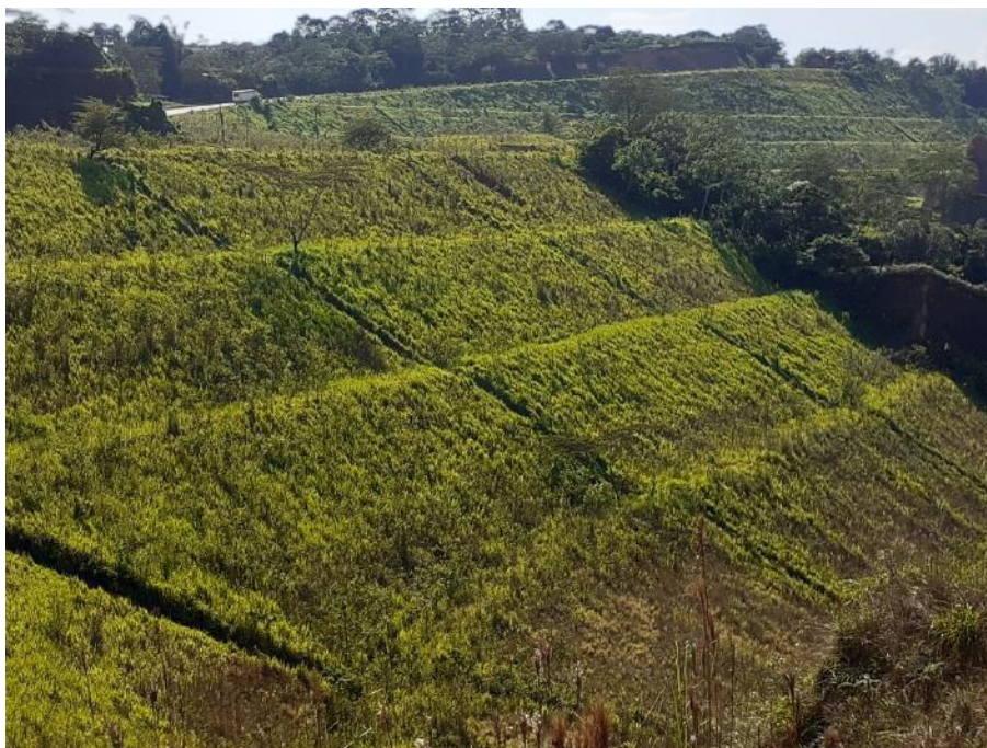
Fotografía 10. Estabilización de las cárcavas ubicadas en el sector Belén. Estos mismos trabajos se deben realizar del caserío Antonio Raymondi Las Vegas. Vista al noroeste
