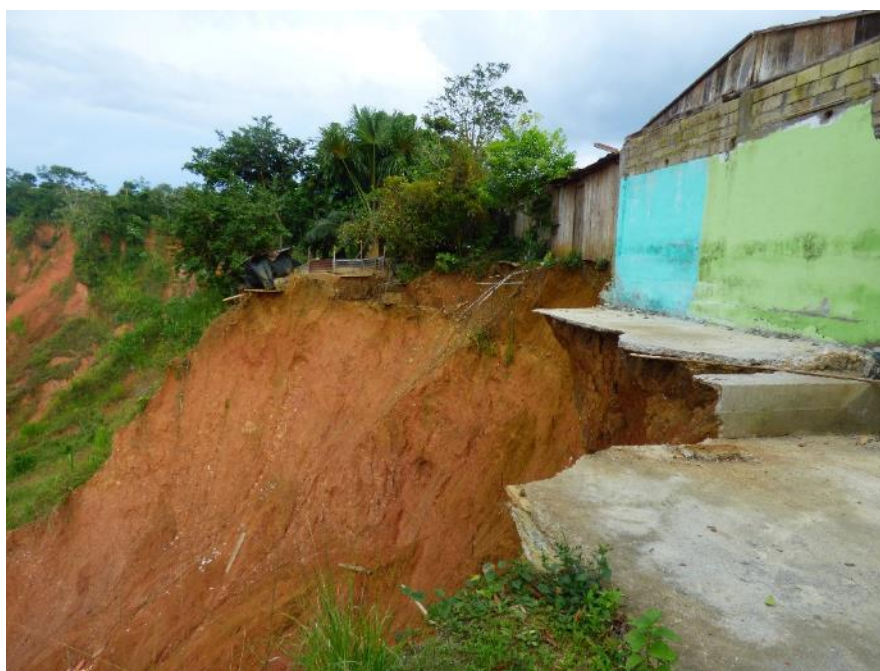
Fotografía 6. Viviendas e institución educativa destruidas y afectadas por el avance retrogresivo de las cárcavas. Vista al sureste.
