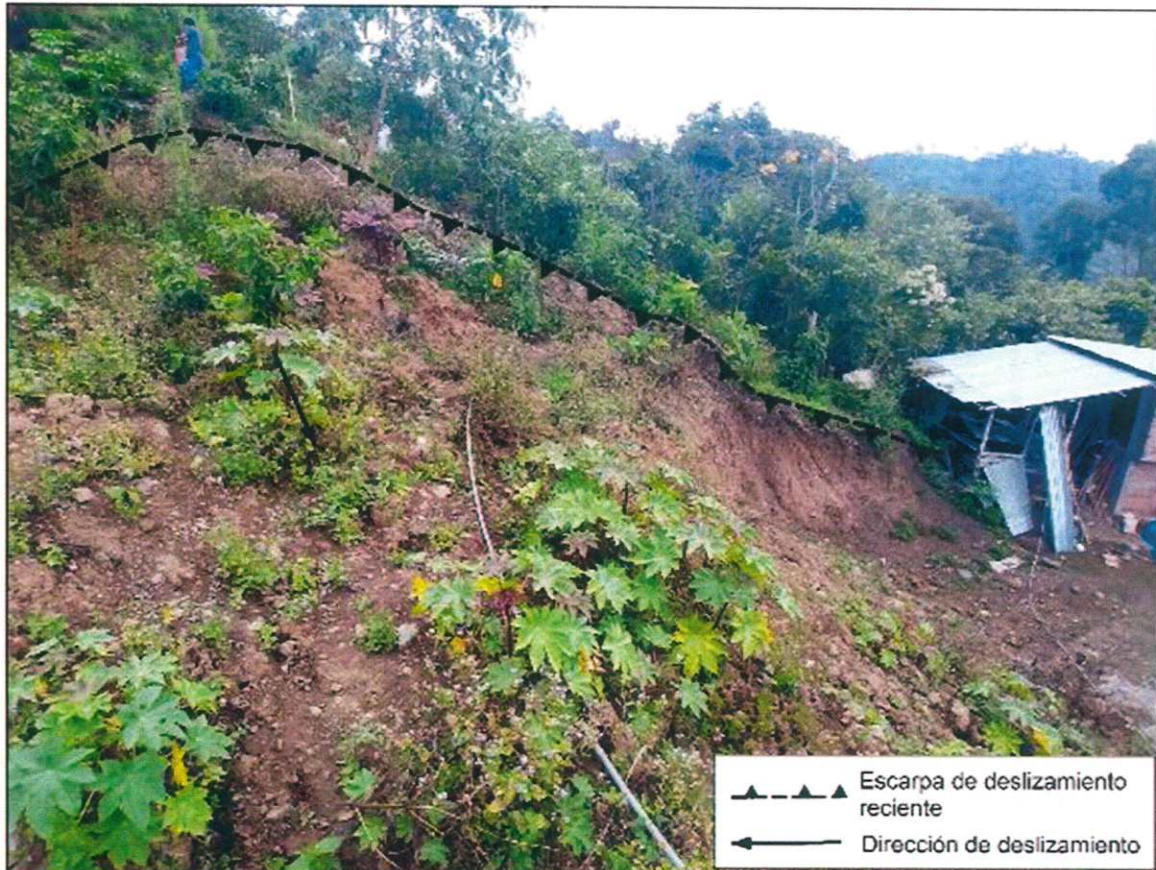
Figura 04: Vista de los materiales de piedemonte coluvio-deluvial. Nótese que estos materiales se encuentran inconsolidados y son susceptibles a desplazamientos.
