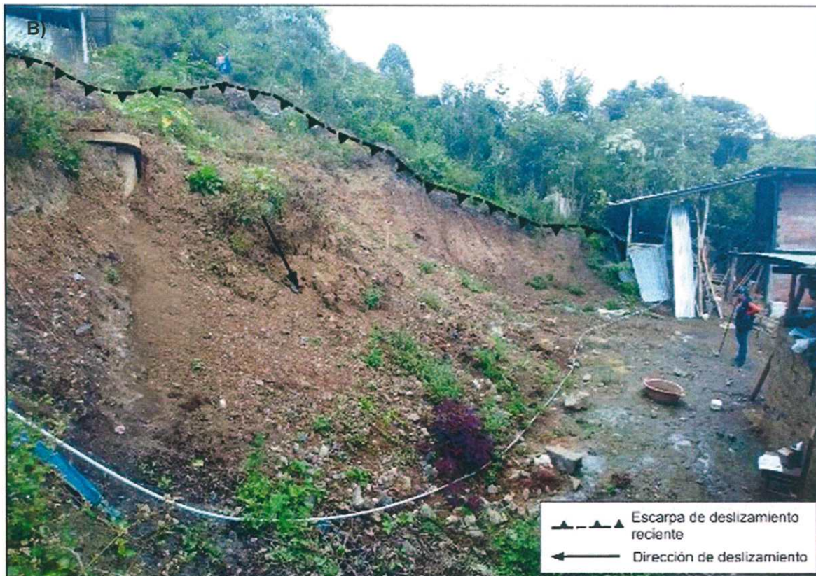
Figura 08: A) Vista del escarpe principal del deslizamiento en un sector del caserío La Tranca que ha ocasionado el colapso parcial de una vivienda. B) Escarpe de deslizamiento, adviértase que pendiente abajo se encuentran varias viviendas que podrían resultar gravemente dañadas.
