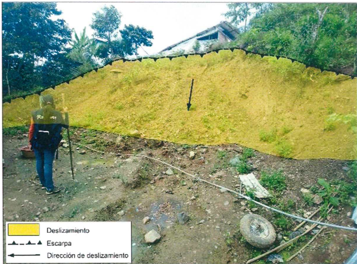
Figura 10: Vista de la forma semicircular del deslizamiento activo, así como de la corona y cuerpo del mismo.
