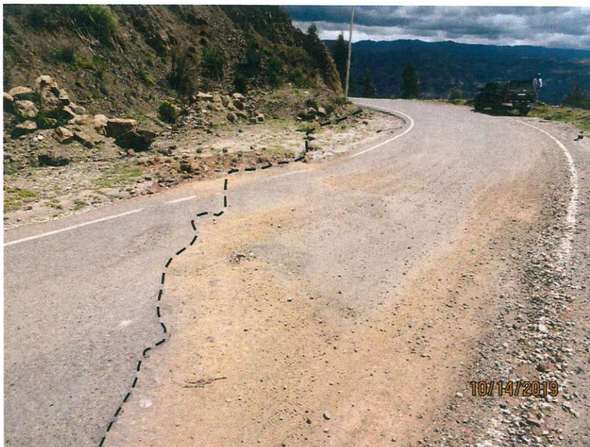
Figura 13. Vista tomada con dirección noreste, se observa tramo de carretera Yanac – Pasacancha, afectado por grieta con una longitud de 30 m.
