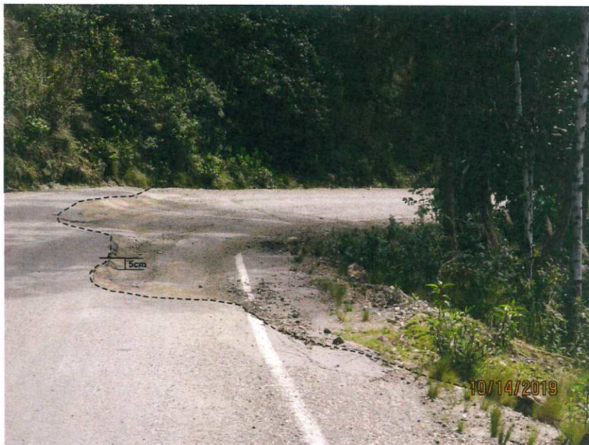
Figura 10. Se observa grietas en la plataforma de carretera asfaltada Yanac - Pasacancha, que presenta una longitud de 124 m y un salto vertical de 5 cm, afecta terraplén de carretera.
