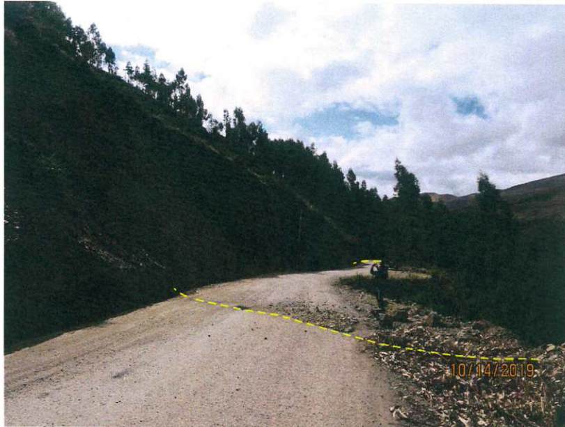
Figura 9. Se observa en la plataforma de la vía Yanac - Pasacancha la presencia de grietas, también se observa en el talud superior material coluvial susceptible a la ocurrencia de derrumbe.
