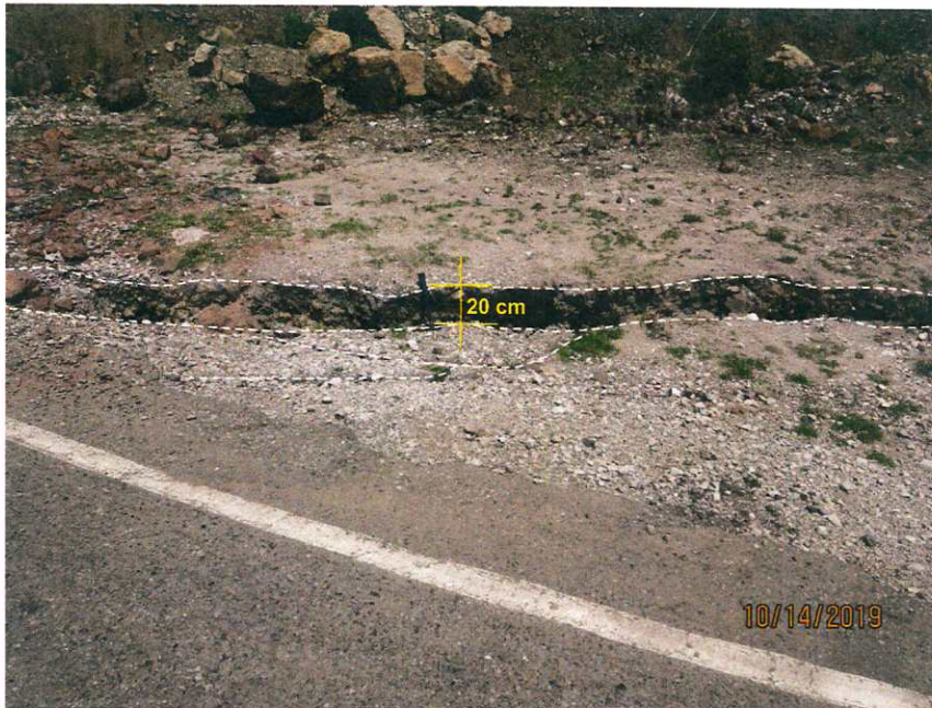
Figura 12 Vista tomada en la coordenada 211086 E - 9049236 S con dirección noroeste, hacia el talud superior de la carretera Yanac – Pasacancha, se observa grieta con una longitud de 030 m, salto vertical de 20 cm. Y profundidad aproximado 2m.
