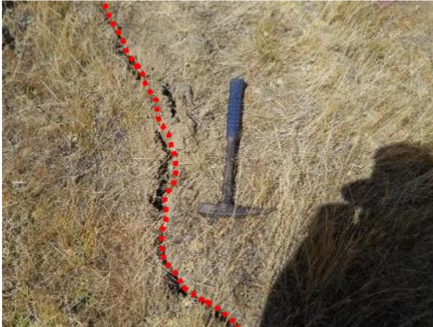
Figura N° 12.- Sector Gonchus, área inestable con grietas con ancho promedio de 3 cm – 5 cm, longitud visible de 17 m y rumbo N15°E. Constituyen el primer sistema de grietas que aflora en superficie.
