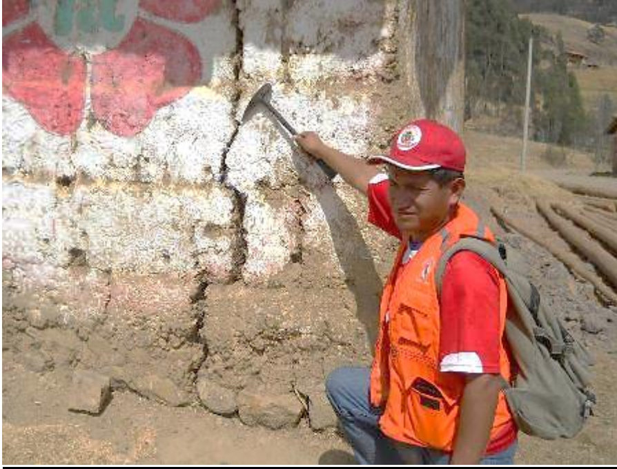
Fotografía N° 03.- Sector Gonchus, grietas en las paredes de las viviendas, con apertura promedio de 5 cm – 10 cm, longitud visible de 1.5 m – 2.5 m, y rumbo N10°E.
