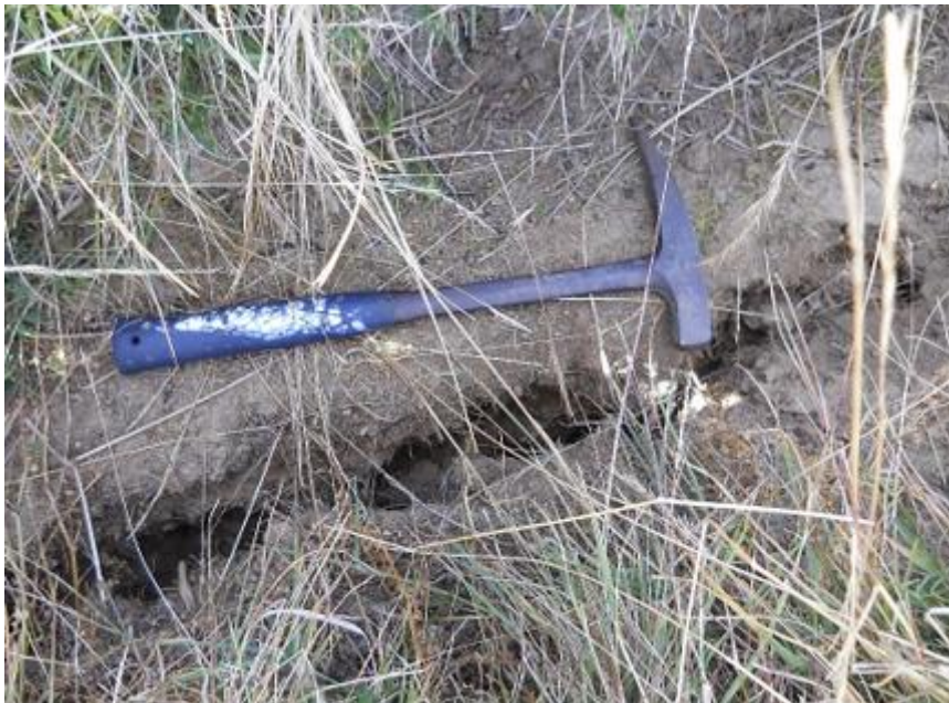
Figura N° 13.- Sector Gonchus, grietas con apertura promedio de 3 cm – 10 cm, longitud visible de 15 m y rumbo N55°E. Constituyen el segundo sistema de grietas que aflora en superficie, transversal al primer sistema.
