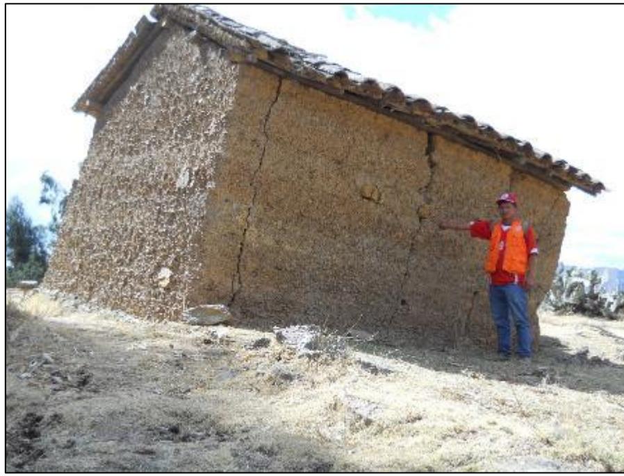
Fotografía N° 10.- Sector Chacapa, área inestable. Vivienda de adobe y techo de madera con tejas, presenta grietas en las paredes y acentuada inclinación, lo cual determina su condición de no habitabilidad. Las grietas, subverticales, presentan aperturas que varían entre 5 cm – 15 cm.
