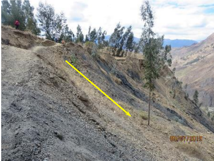
Figura N° 22.- Zona deforestada para ganar terrenos de cultivo, y con malas prácticas de riego (por gravedad), que originan el aumento de la inestabilidad del substrato rocoso. En la vista se observa que la zona se ha deslizado y presenta una pendiente superior a 45° (abrupta).
