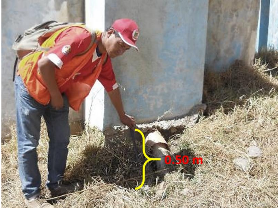
Figura N° 14.- Sector Gonchus, pozo séptico del centro poblado Rayán, obra de material noble construida por la municipalidad distrital de Yauya en 2012. Actualmente presenta un asentamiento promedio de 0.50 m.
