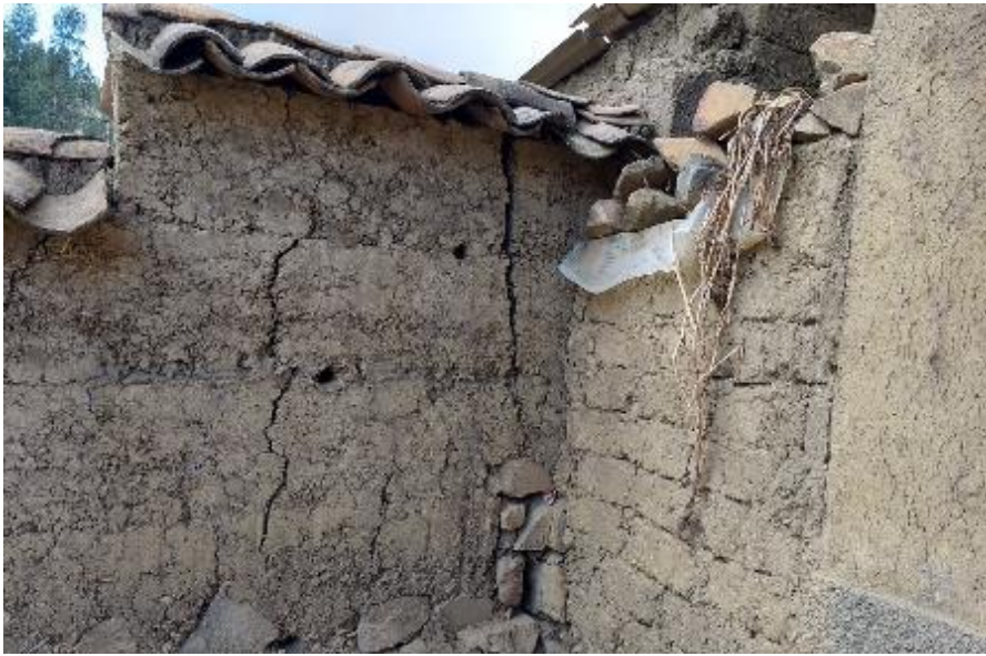
Fotografía N° 13.- Sector Yauya, parte posterior de una vivienda del distrito de Yauya, se observan grietas subverticales, desde el piso hasta el techo, con apertura promedio de 4 cm – 10 cm, longitud visible de 2.00 m. Vivienda seriamente dañada, con paredes inclinadas.
