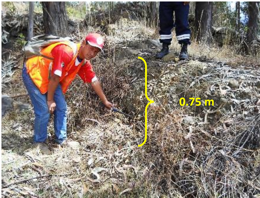
Figura N° 15.- Sector Gonchus, parte lateral izquierda del área inestable. En la vista se observa una zona de con un asentamiento promedio de 0.75 m.
