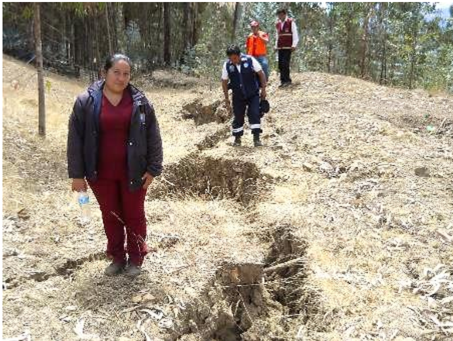
Fotografía N° 07.- Sector Chacapa, grieta con apertura promedio de 80 cm – 90 cm, profundidad de 1.70 m, longitud visible en superficie de 50 m, rumbo N35°W. Los pobladores de Chacapa manifestaron que la grieta se había formado 15 días antes de la inspección geológica.
