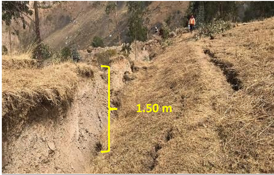
Figura N° 18.- Sector Chacapa, área inestable con presencia de grietas con aperturas de 75 cm en promedio (ver zona derecha de la vista), y “saltos” del terreno con desniveles de 1.50 m.
