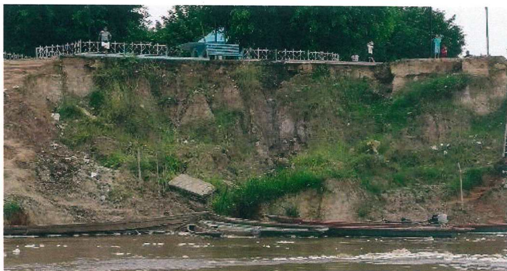
Fotografía 9: Vista frontal de la ribera erosionada, en el sector de la plaza de armas de la localidad de Shucushyacu.
