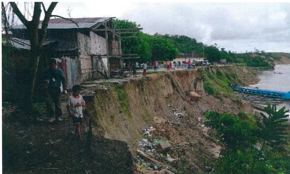
Fotografía 13: Vista hacia aguas arriba. El proceso erosivo afecta severamente la seguridad física de viviendas.
