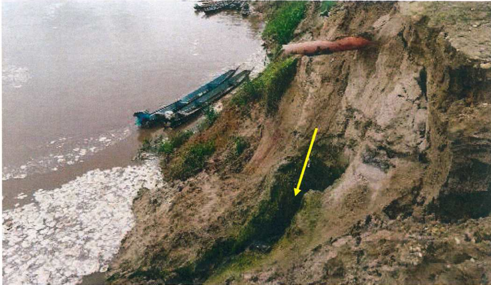
Figura 10: Detalle de tubería destruida. La descarga de aguas superficiales directamente hacia el talud genera surcos y cárcavas de erosión en el terreno arenoso.
