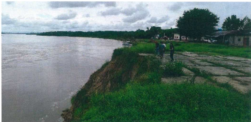
Fotografía 7: Vista hacia aguas abajo. Plataforma de concreto afectada por erosión fluvial.
