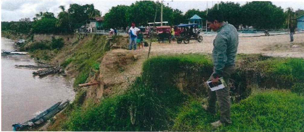
Fotografía 11: Vista hacia aguas abajo. Tuberías destruidas.
