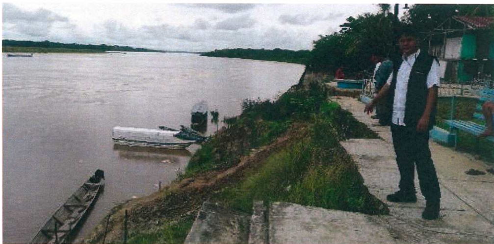
Fotografía 12: Parte de la infraestructura de la plaza de armas ha colapsado.
