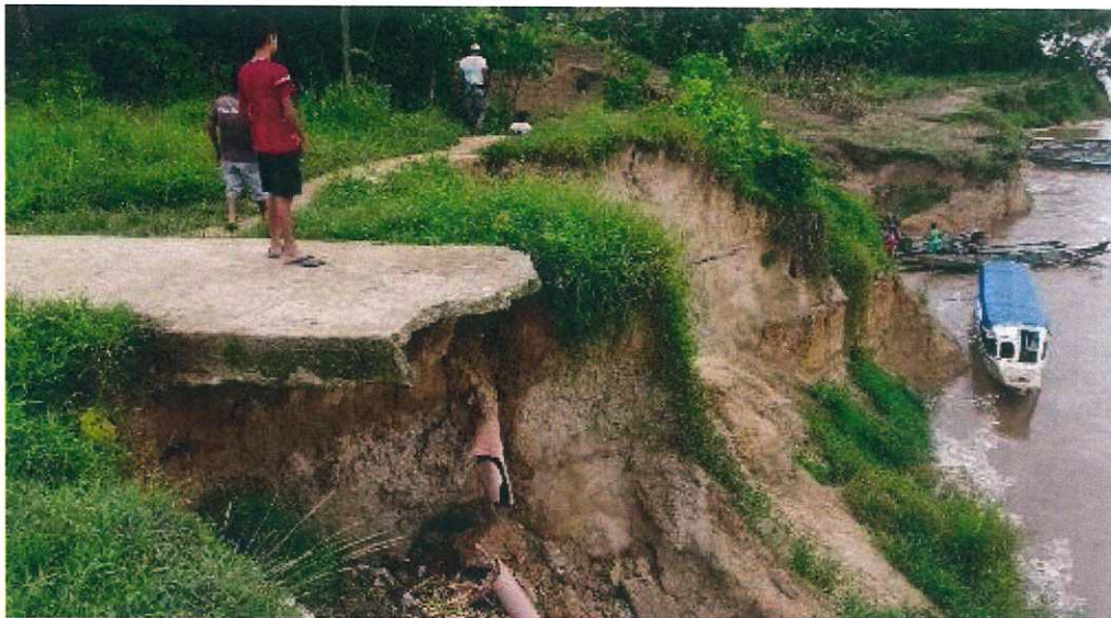
Fotografía 6: Vereda de concreto colapsada producto de la erosión fluvial.
