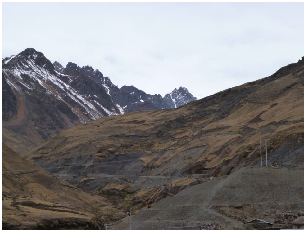
Fotografía 8.49 Derrumbes y deslizamientos en el talud superior e inferior de la carretera, compromete secuencia de pizarras negras, produce pérdida de plataforma de la carretera, Km. 104+900 de la Interoceánica.
