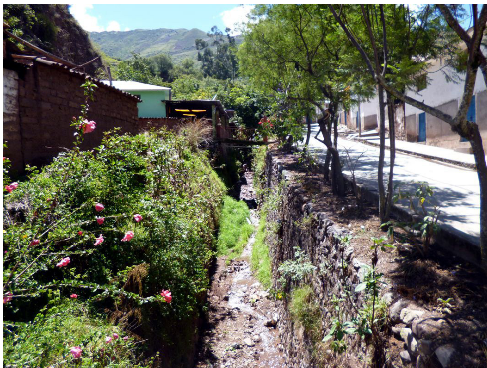
Fotografía 8.66 Torrentera sin nombre que pasa por el poblado de Limatambo, encausada con muros de roca.
