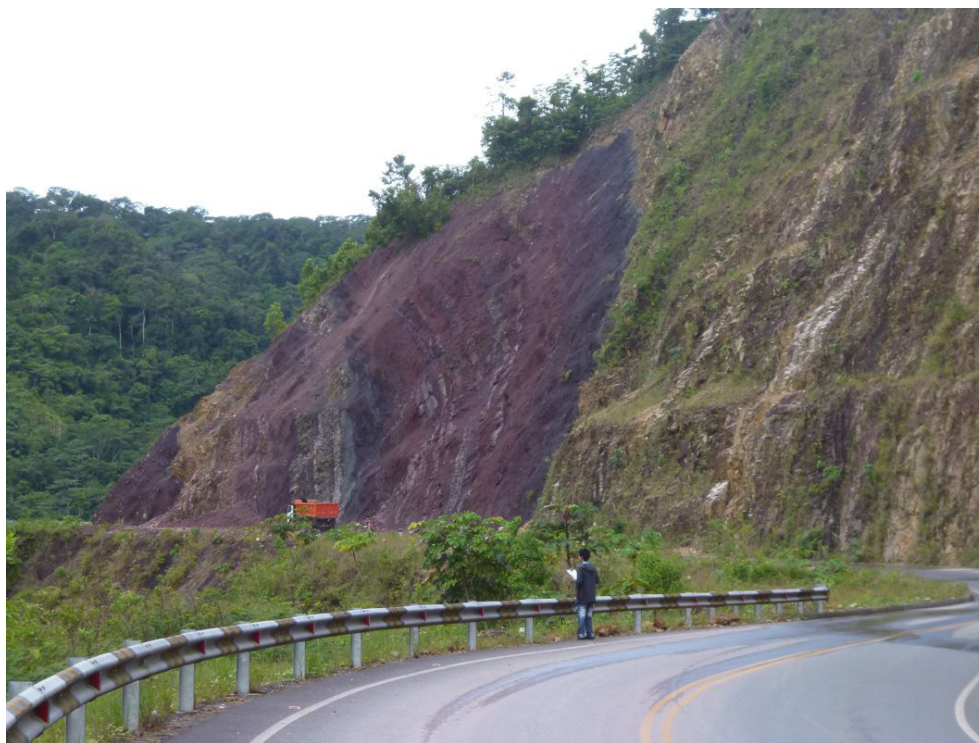
Fotografía 8.45 Derrumbe en talud superior de la carretera compromete secuencia de areniscas y conglomerados, sector del puente Media Luna.
