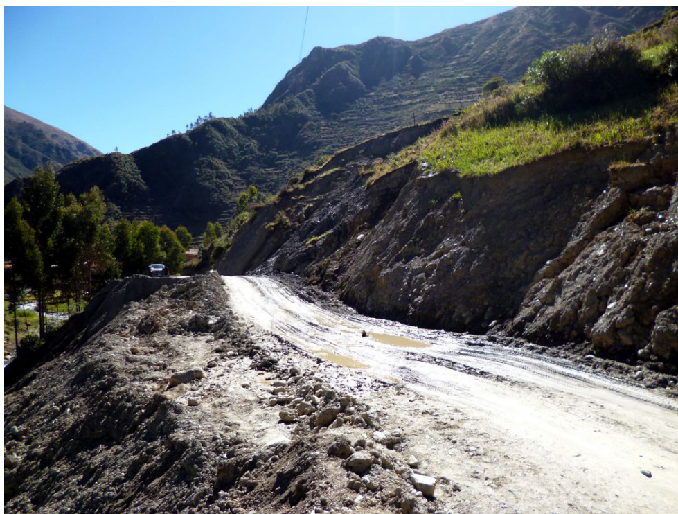
Fotografía 8.80 Asentamientos en la carretera producidos por reactivación de deslizamiento flujo en el sector de Huyloc.
