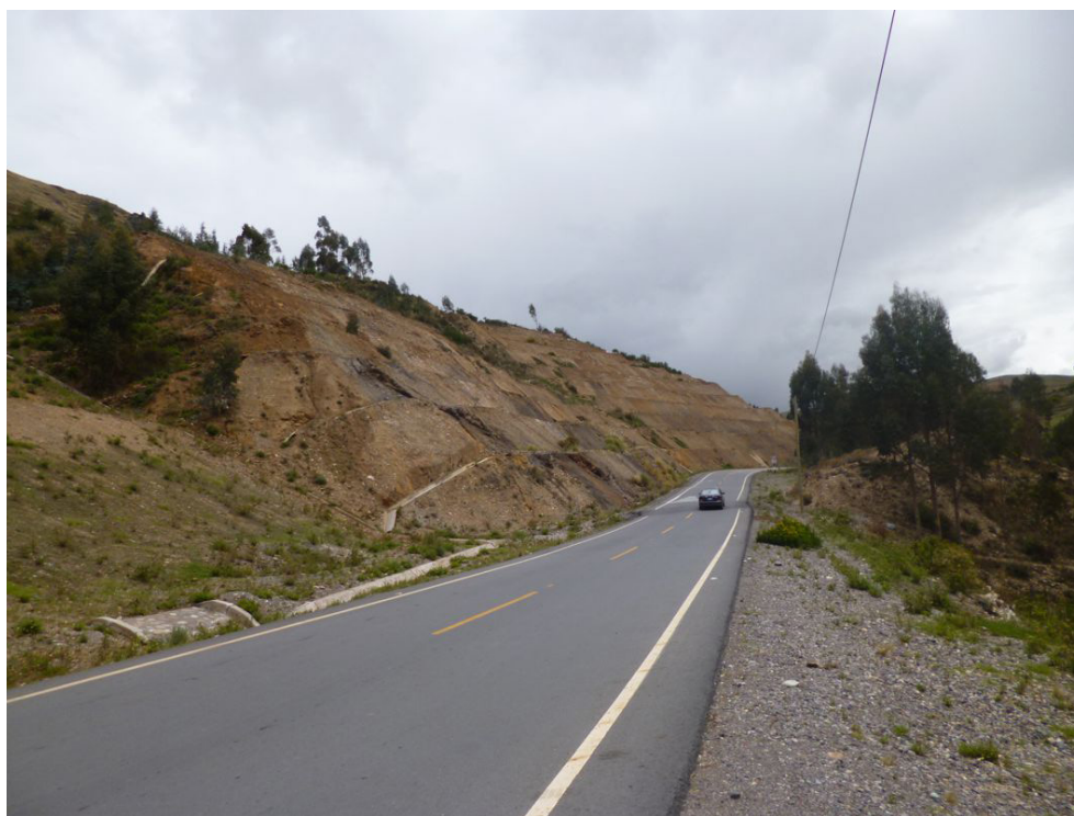
Fotografía 8.53 Talud de corte con baquetas que buscan estabilizar la zona afectada por el deslizamiento de Huayllopampa.
