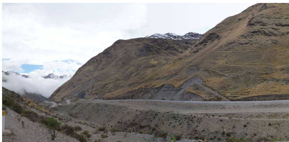
Fotografía 8.48 Talud superior inestable por trabajos de ampliación de la carretera Interoceánica, compromete sustrato de pizarras, filitas y depósitos coluviales, a la altura del Km. 109+900.
