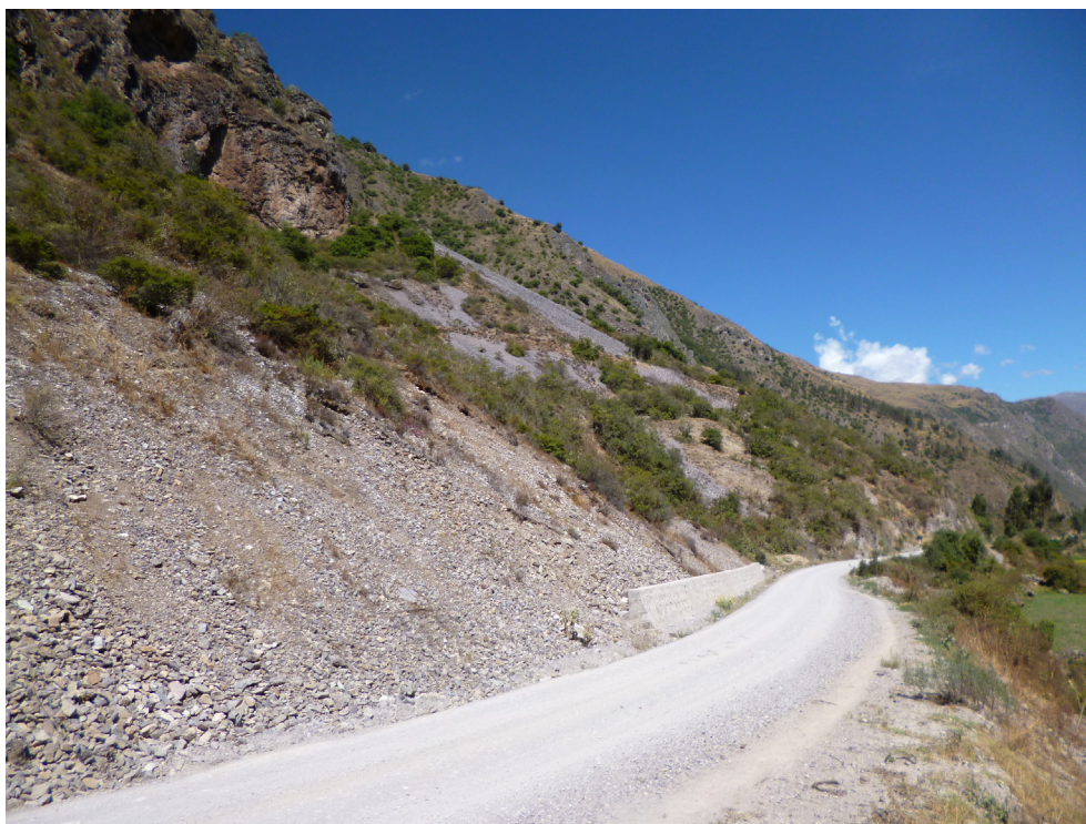
Fotografía 5.12 Talud de detritos en el talud superior de la carretera Ollantaytambo-Ocobamba, a la altura del Km. 7+800.
