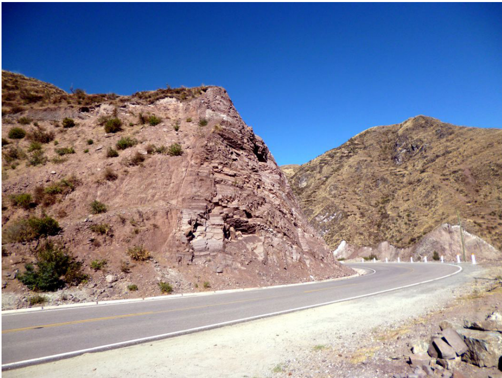
Fotografía 8.100 Km. 24 de la carretera Acomayo-Pitumarca, con taludes de corte subverticales en capas rojas. Las caídas de material están controladas por la estratificación de las capas de roca, la familia de fracturas y la dirección del trazo de la carretera.
