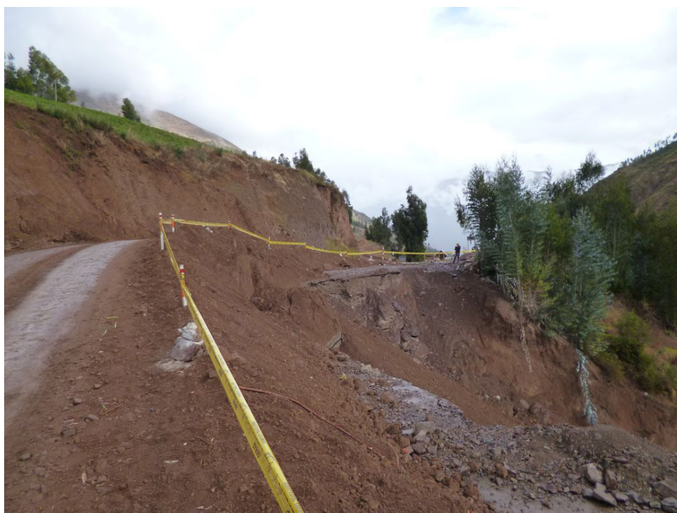
Fotografía 8.31 Deslizamiento que cortó toda la plataforma de la carretera en el Km. 3+630 de la carretera Calca-Yanatile, substrato de areniscas, limolita roja e ignimbritas.
