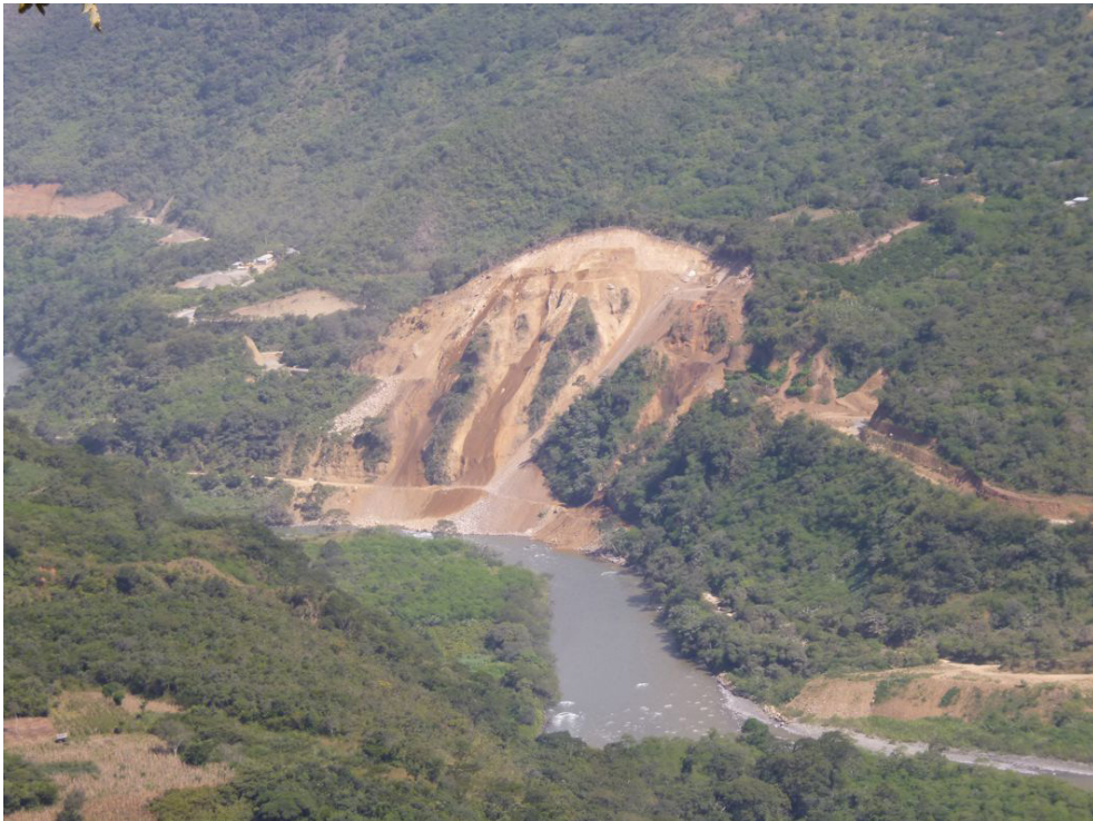
Fotografía 8.25 Derrumbe en talud superior de carretera, cortó el tránsito hacia Echarati. Se vienen realizando trabajos de banqueteo en el talud de corte.
