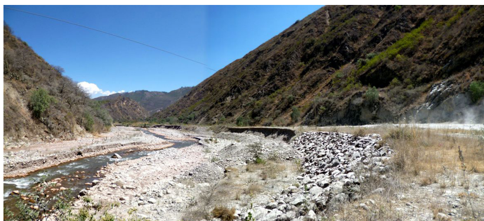
Fotografía 8.65 Erosión fluvial en la margen derecha del río Colorado, afectó la carretera Abancay-Cusco.
