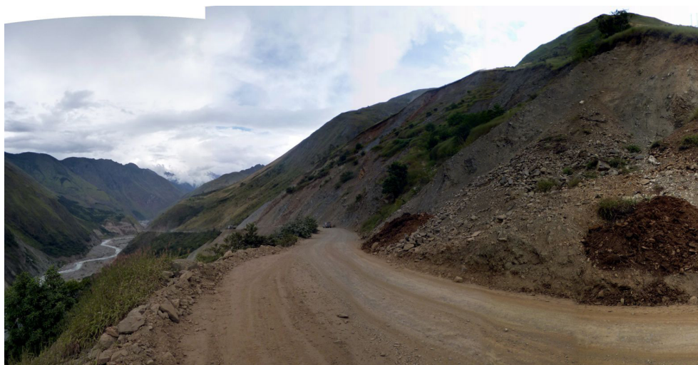
Fotografía 8.11 Derrumbe activo de Cocalmayo produce la obstrucción de la carretera; también hay asentamientos en la plataforma de carretera.
