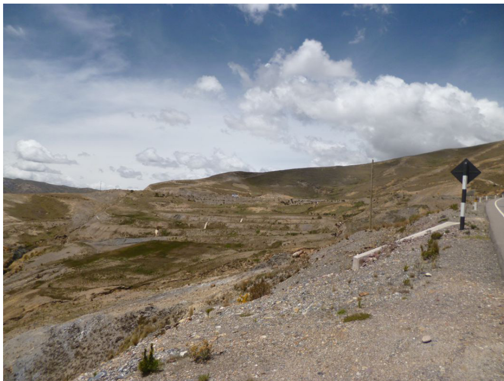
Fotografía 8.57 Deslizamiento que produce asentamientos en la plataforma de la carretera Interoceánica en el cerro Josjhuarina.
