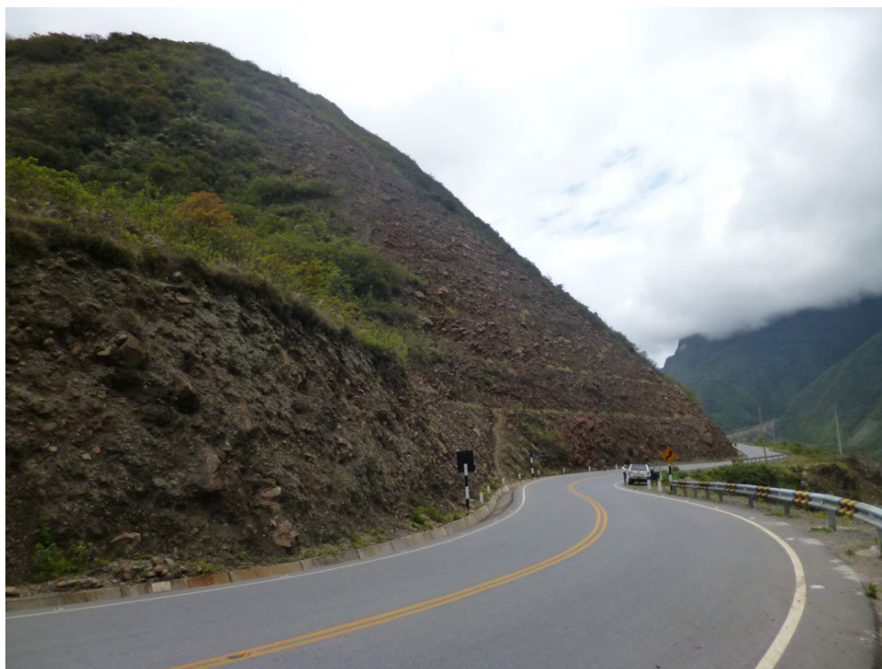
Fotografía 8.41 Km. 143+500 de la carretera Interoceánica, altura del talud de corte de hasta 250 m, se han cortado varias banquetas para estabilizar la zona; hay caída de cantos de roca.
