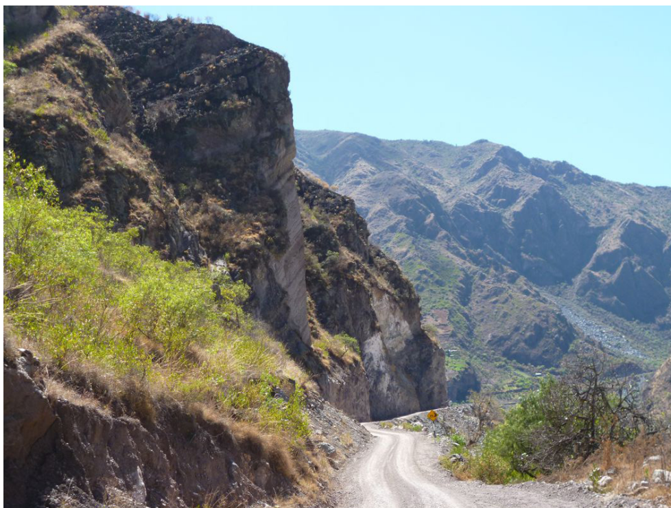
Fotografía 8.97 Talud de corte vertical de casi 40 m de altura, muy inestable, desde donde se produce la caída de bloques de roca y suelo.
