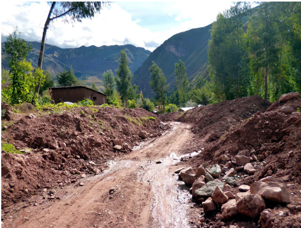
Fotografía 8.34 Flujo de detritos que discurre por la calle en el sector de Huaynapata en Coya.
