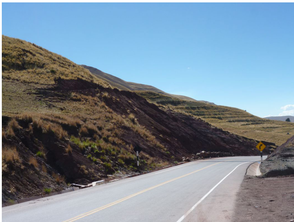
Fotografía 8.101 Derrumbe en el talud superior entre el Km. 14+300 y el 15+900 de la carretera Sicuani-El Descanso-Espinar.
