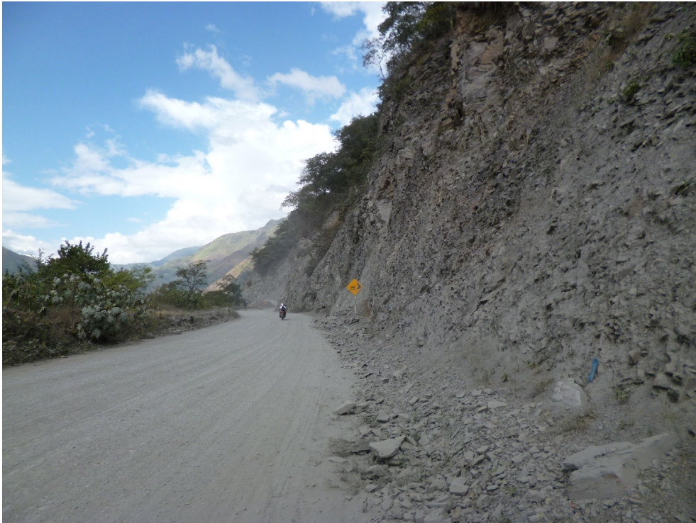
Fotografía 8.21 Km. 130+900 de la carretera a Santa Ana-Quillabamba, tramo sin asfaltar, material caído del talud superior se acumula al pie y obstruye la carretera.
