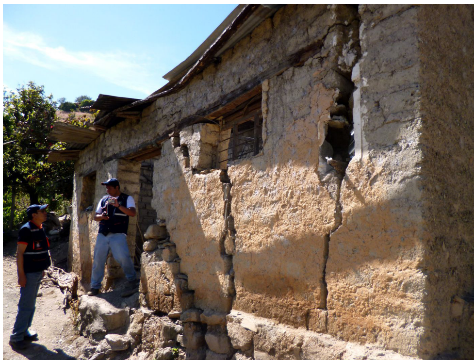
Fotografía 8.13 Vivienda agrietada en el sector de Sullucuyoc.
