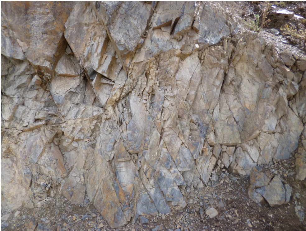
Fotografía 3.20 Lutitas del Grupo Cabanillas, en el talud superior de corte de la carretera Paucartambo-Ccarhuayo-Ocongate, con más de 3 familias de fracturas, sector cerro Ujayoc, distrito Paucartambo.
