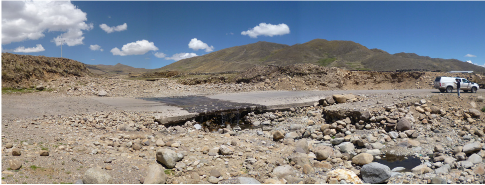
Fotografía 8.2 Quebrada Ccanco Ccala corta la carretera a Velille. En la foto se puede observar la socavación que se produce actualmente en el badén.
