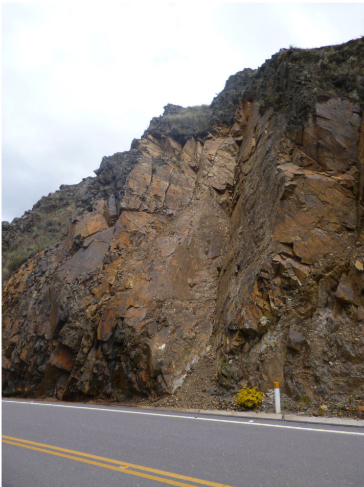
Fotografía 8.56 Caída de bloque de roca por mecanismo de falla en cuña, Km. 52+400 de la carretera Interoceánica.
