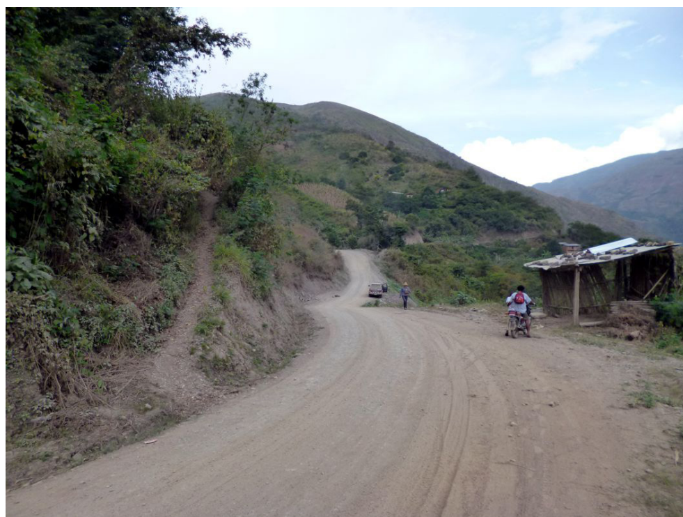
Fotografía 8.18 Asentamiento de casi un metro en la plataforma de la carretera que lleva a Yanatile.
