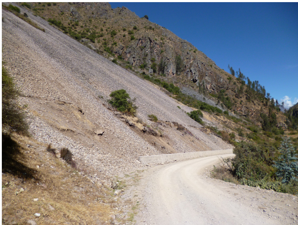
Fotografía 8.81 Derrumbes en el talud superior de la carretera Ollantaytambo-Ocobamba, compromete conos de talus.
