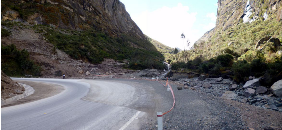
Fotografía 8.74 Efectos del huaico de la quebrada Tanjac, erosionó varios tramos de la carretera que conduce a Quillabamba.
