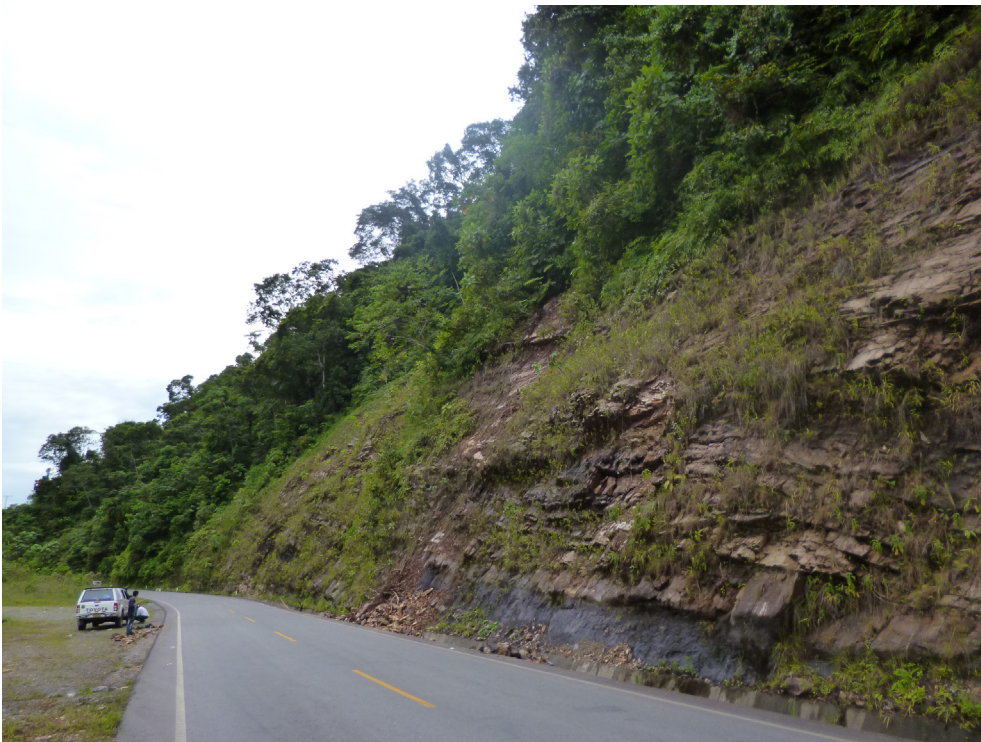
Fotografía 3.17 Rocas de la Formación Chonta con buzamiento en contra de la pendiente del talud de corte. Carretera Interoceánica Km. 243+100, sector San José, distrito Camanti, provincia Quispicanchi.
