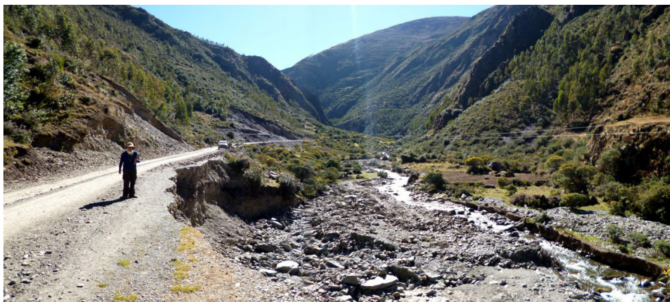
Fotografía 8.77 Erosión fluvial en la margen derecha del río Patacancha afecta el talud inferior de carretera.
