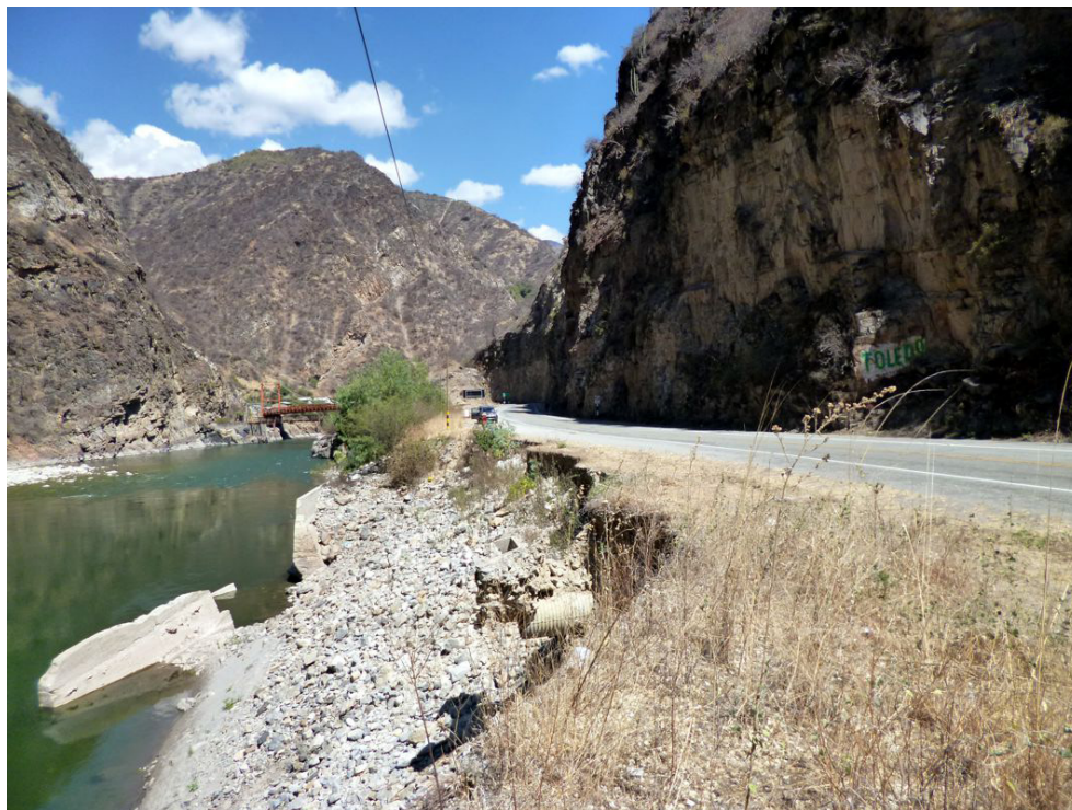
Fotografía 8.68 Erosión fluvial en el talud inferior de carretera, margen derecha del río Apurímac, cerca al puente Cunyac.
