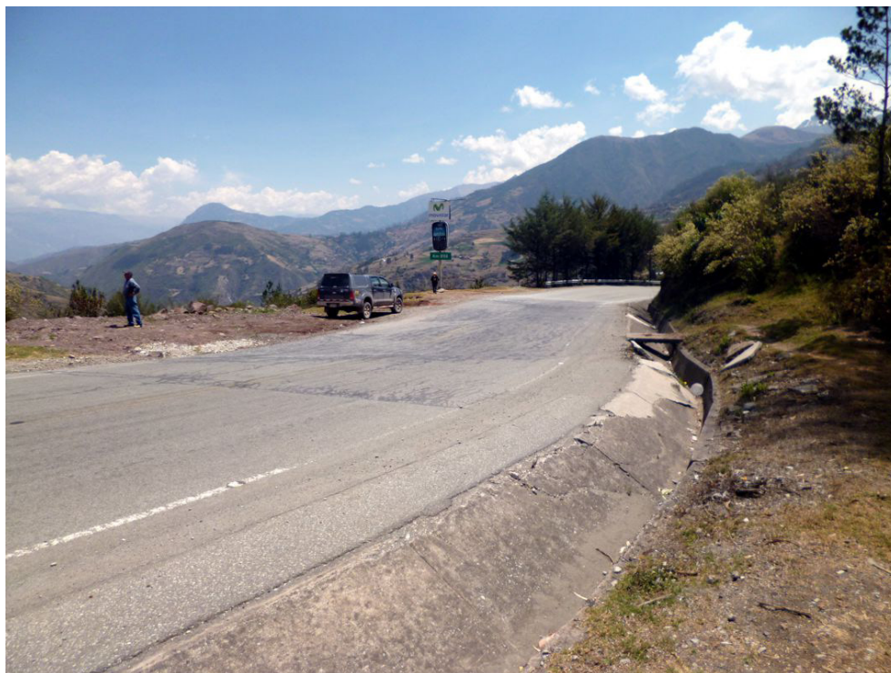
Fotografía 8.64 Asentamiento de plataforma y pérdida de asfalto en el Km. 898 de la vía Abancay-Cusco.
