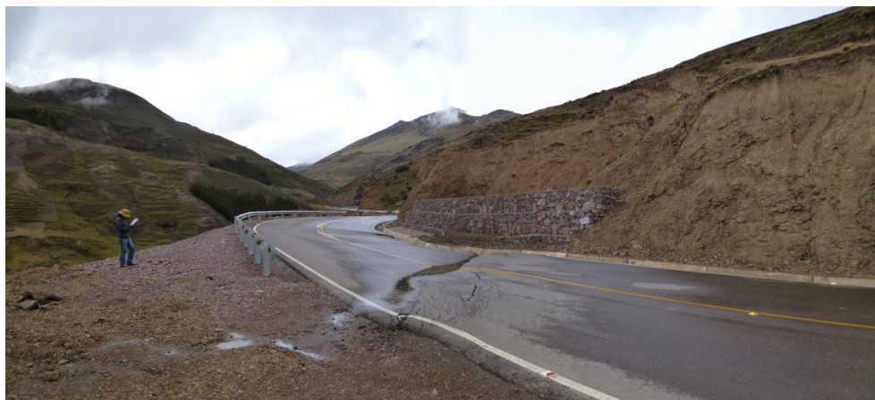
Fotografía 8.30 Asentamiento en plataforma de la carretera en el Km. 14+560 de la carretera Calca-Yanatile, substrato de filitas y pizarras.
