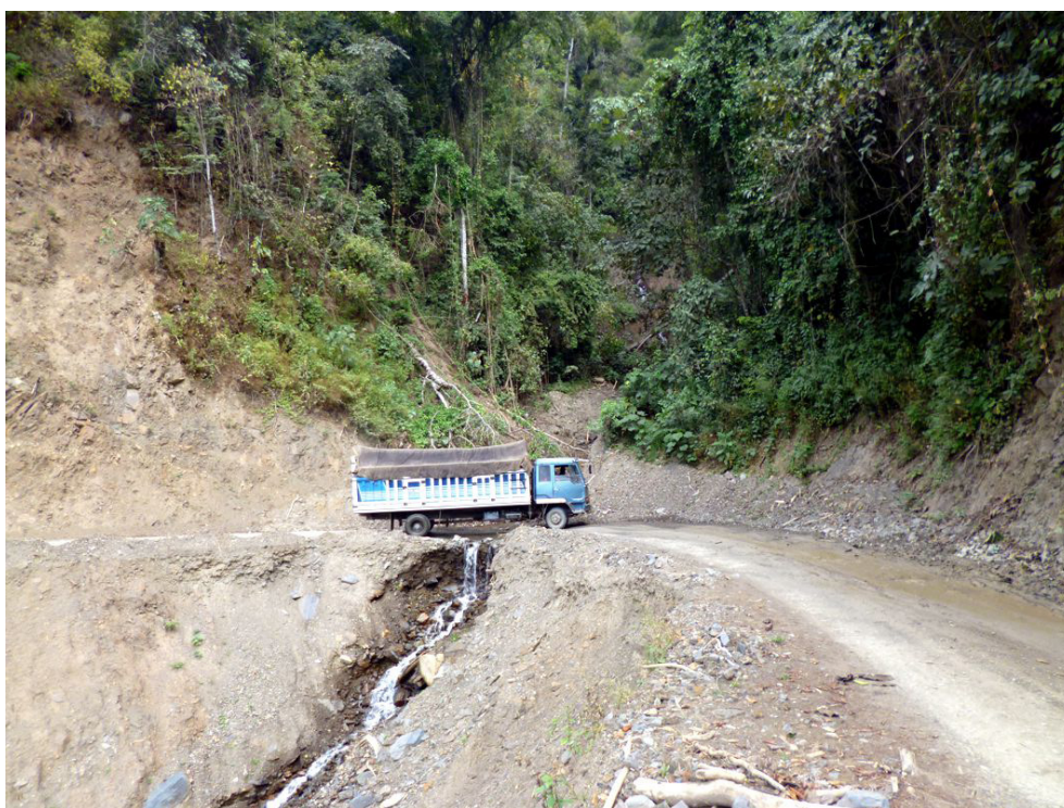
Fotografía 8.16 Flujo de detritos que corta la carretera a Ocobamba, cerca de Chinganilla.
