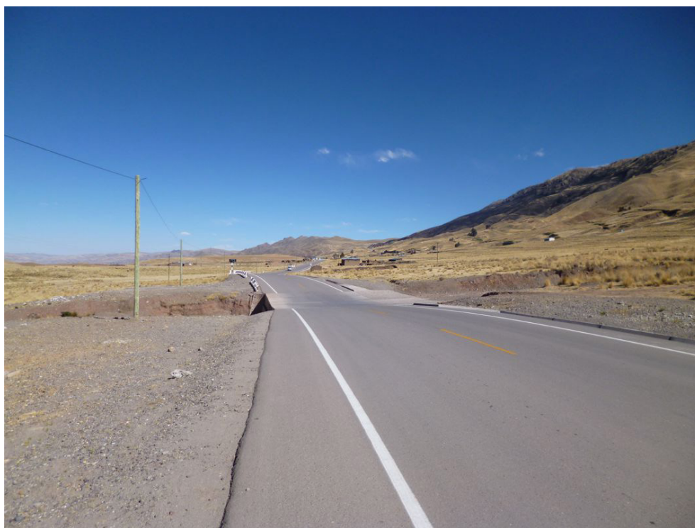
Fotografía 8.102 Huaico que corta la cruza la carretera por medio de badén, sector de Antaimarca.
