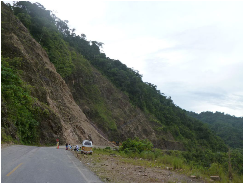
Fotografía 8.44 Derrumbe en talud superior de la carretera cerca del sector de Villanuvia, material caído bloquea el paso por varios días.
