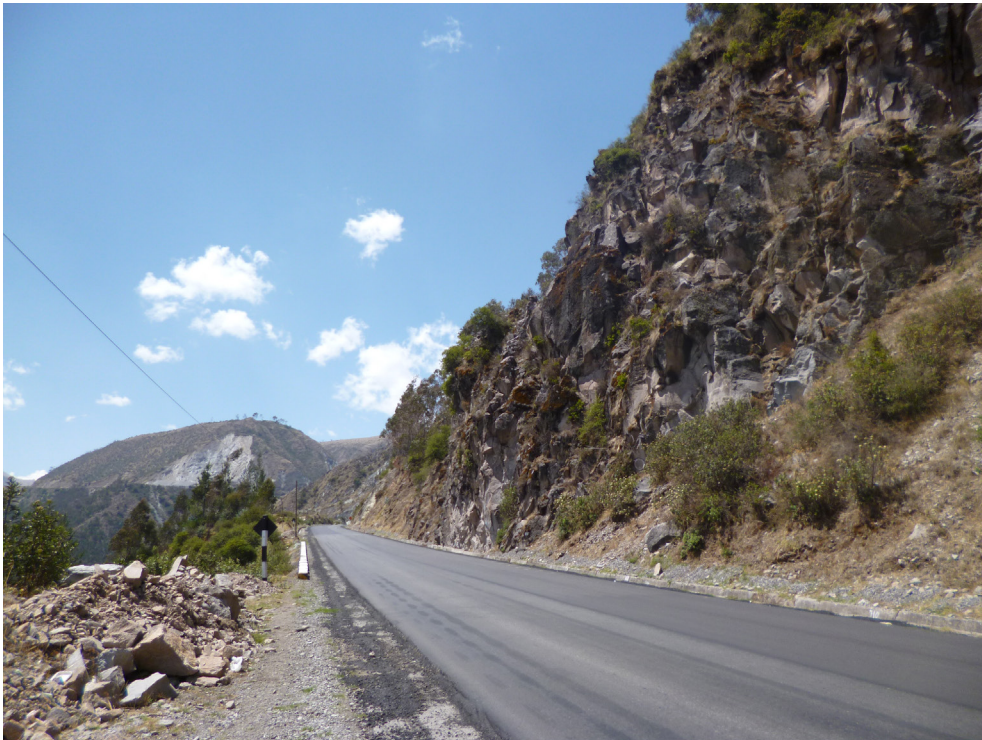
Fotografía 3.13 Shoshonitas en el talud superior de la carretera Cusco-Limatambo, sector de Ayaviri, distrito Limatambo.
