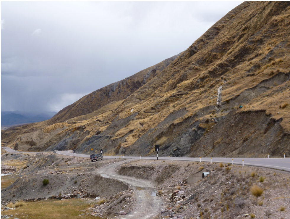
Fotografía 8.52 Taludes superiores inestables de la carretera Interoceánica. en el sector de Cotaña, se han colocado cunetas de coronación en la zona.
