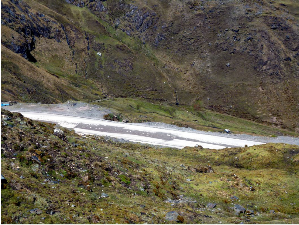
Fotografía 8.6 Asentamiento en la plataforma de la carretera, cerca del abra Málaga.
