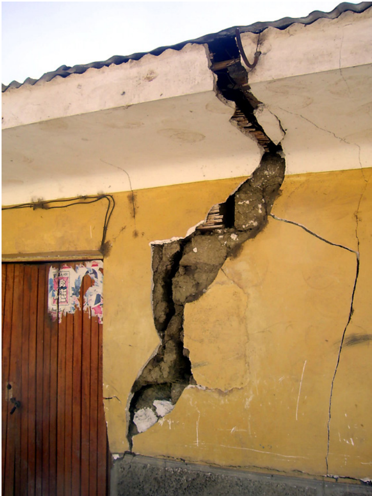
Fotografía 8.37 Agrietamientos en paredes de las Viviendas en la comunidad de Cuyo Chico.
