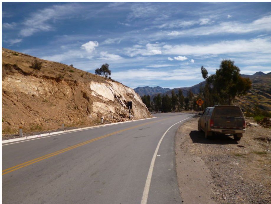
Fotografía 8.90 Talud superior de la carretera conformado de filitas y pizarras, bloques caen por falla planar.
