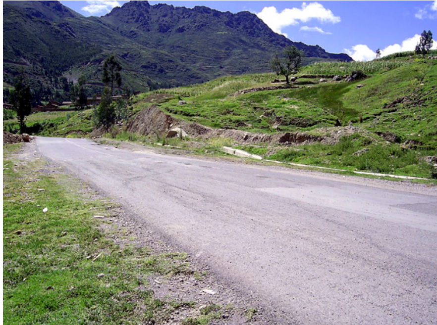
Fotografía 8.36 Asentamientos y pérdida de la plataforma entre el Km. 4+100 al km 4+900 de carretera de acceso a Pisac y Paucartambo.
