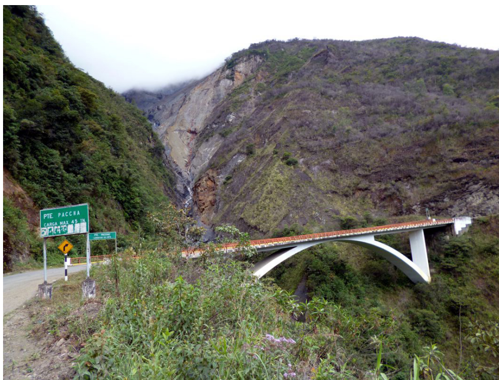
Fotografía 8.27 Quebrada con derrumbe activo en la cabecera de cuenca. El material caído es acarreado como huaico en el sector de Puente Paccha.
