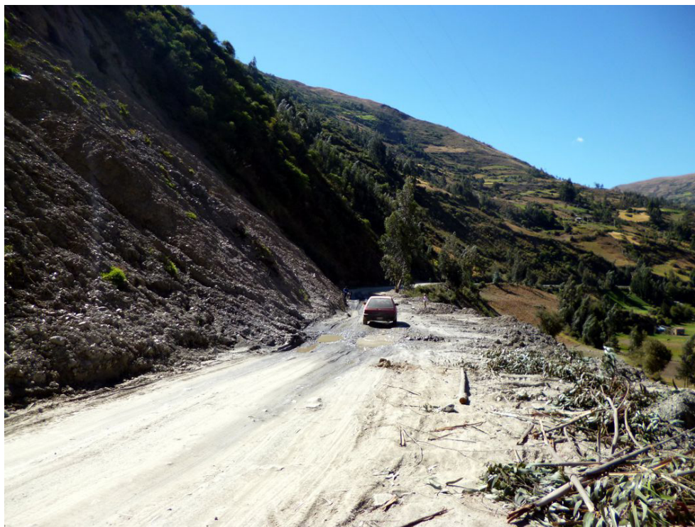
Fotografía 8.84 Derrumbe-flujo de detritos en el talud superior de la carretera que conduce de Paucartambo a Challabamba.
