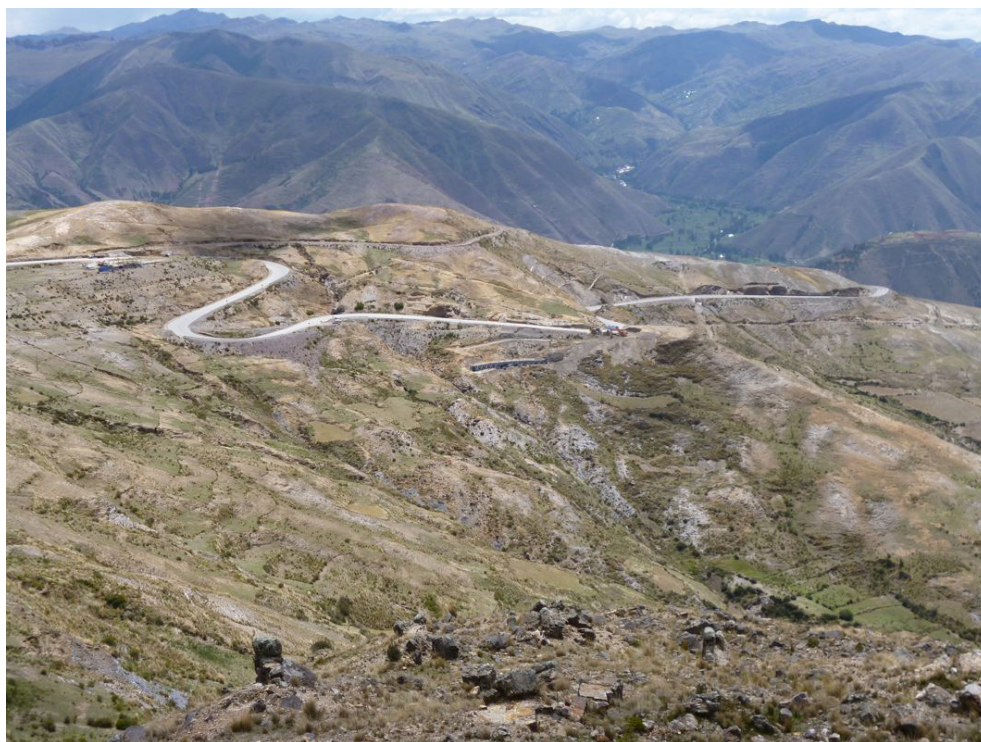
Fotografía 8.59 Asentamiento de la plataforma de la carretera Interoceánica en el km 10+380, se están realizando trabajos de estabilización.
