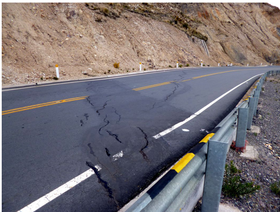
Fotografía 8.58 Plataforma de la carretera asfaltada, agrietada y con asentamientos en el sector de Chapiri, margen derecha de la quebrada Collpamayo.
