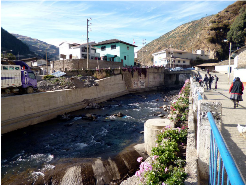
Fotografía 8.87 Vista aguas arriba de la quebrada Quencomayo, tramo encauzado con muros de concreto en la localidad de Paucartambo.
