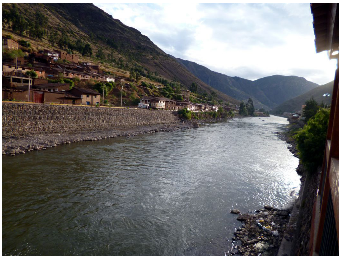
Fotografía 8.40 Tramo encauzado del río Vilcanota con gaviones.
