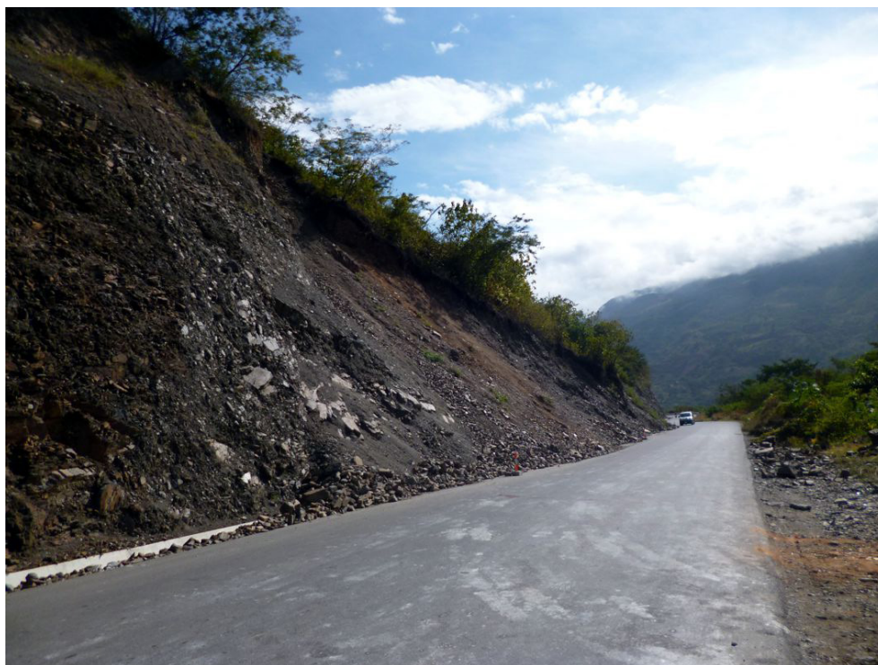
Fotografía 8.20 Derrumbes en el talud superior de la carretera, Km. 136+900, material caído obstruye la cuneta.
