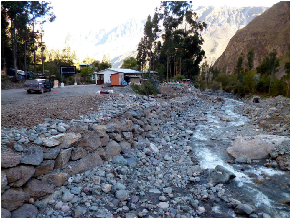
Fotografía 8.75 Erosión de las márgenes de la quebrada Tanjac en el sector de Phiri pudo afectar viviendas y tramo de carretera.
