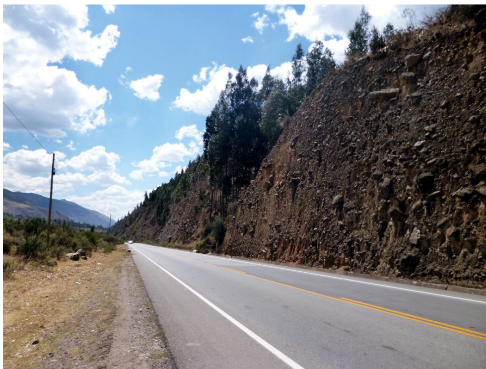
Fotografía 8.61 Talud superior subvertical de la carretera, entre el Km. 1048+800 al Km. 1049+100, se producen derrumbes y caídas de clastos.
