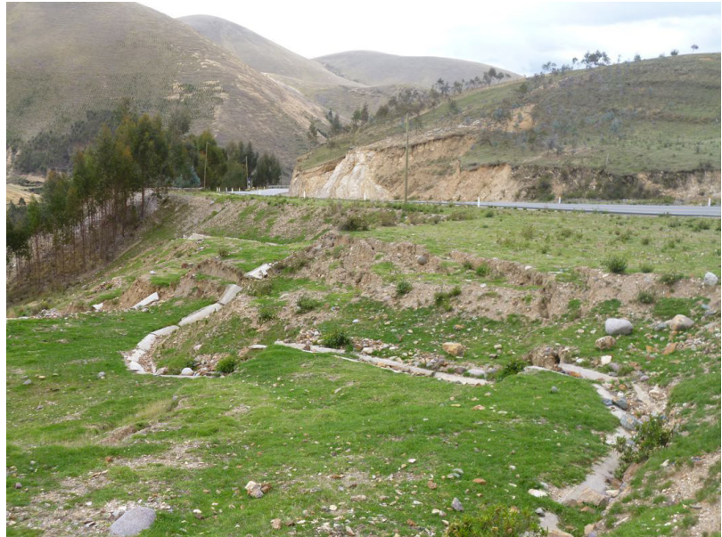
Fotografía 8.55 Deslizamiento en talud inferior de la carretera Interoceánica, sector de Jillicunca, cuneta se encuentra rota y desplazada.
