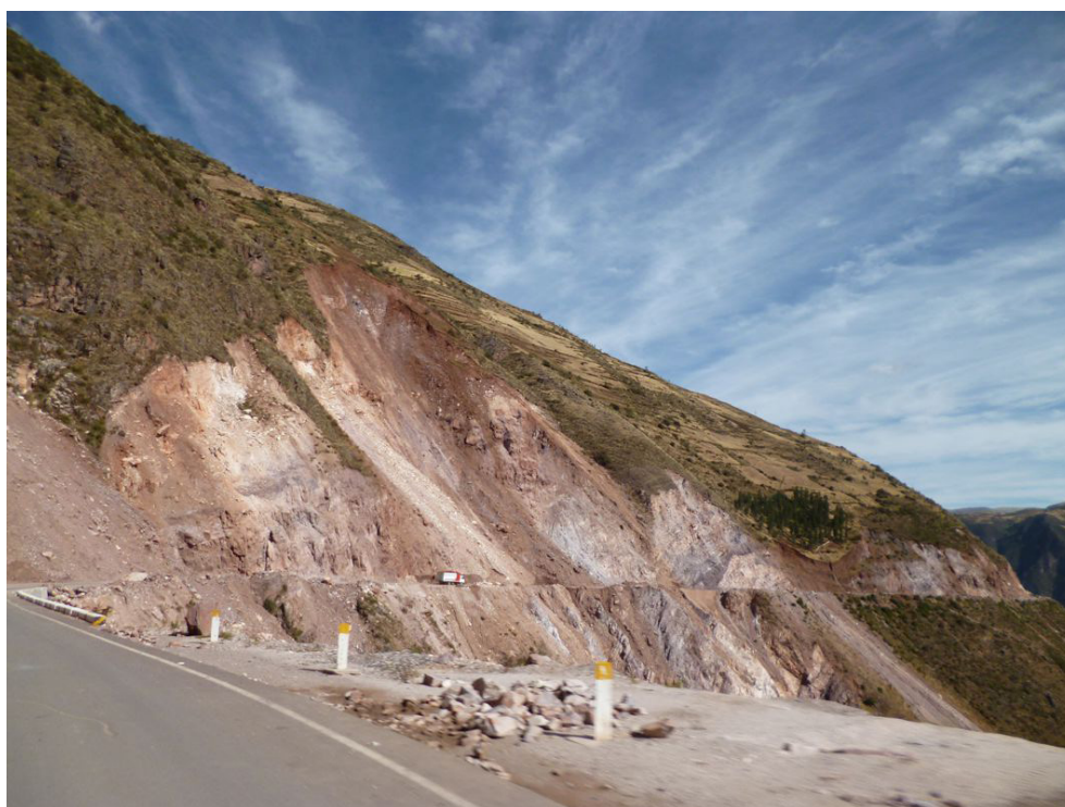
Fotografía 8.92 Taludes de más de 40 m de altura en la vía a Huancarani, material caído obstruye la vía.
