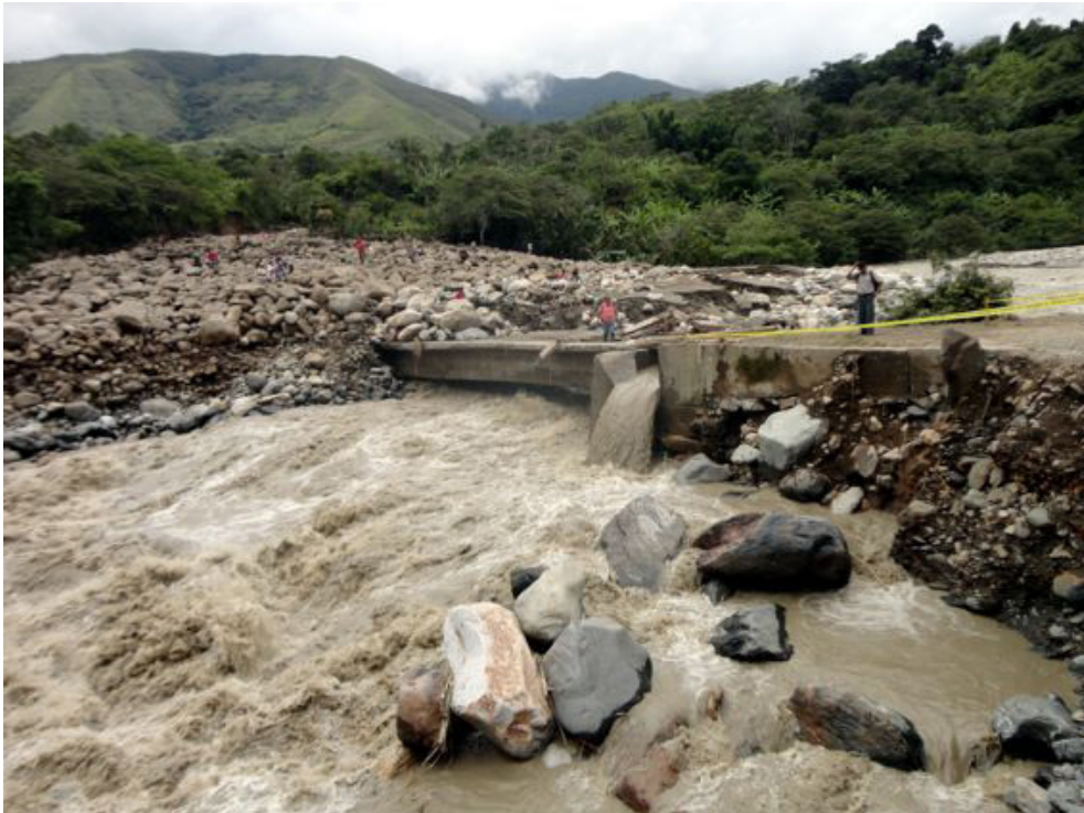
Fotografía 8.10 Puente que cruza el río Lúcumá, cubierto por el flujo de detritos de la quebrada Calquiña en Huyro.
