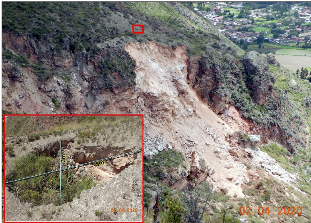
Figura 13. Zonas de Karstificación - Hundimiento en la zona posterior a la zona de arranque.
