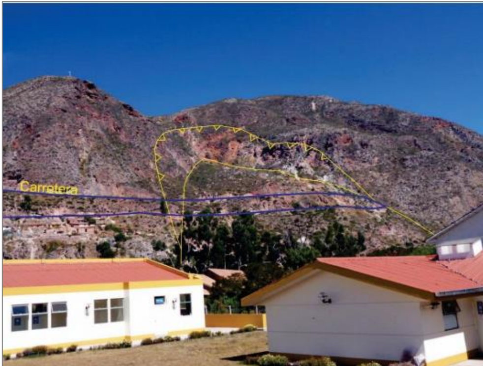
Figura 9. Deslizamiento que produce el asentamiento de la carretera que permite el acceso a Urubamba. Tomado de Vélchez et al 2015.
