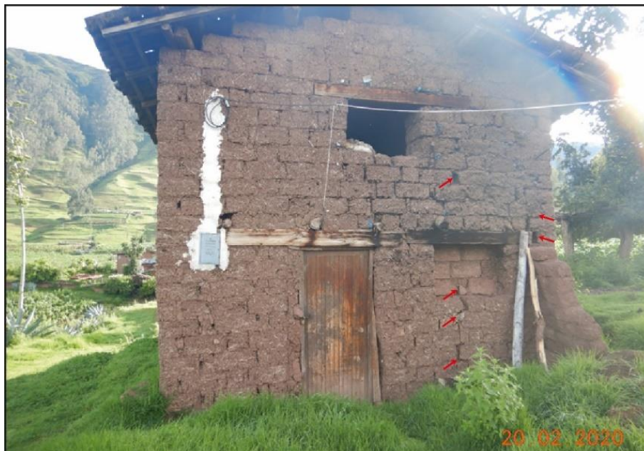
Figura 13. Agrietamientos en las paredes de vivienda ubicada en la margen izquierda de la quebrada Minaspatá Huayco, producto del asentamiento del terreno.
