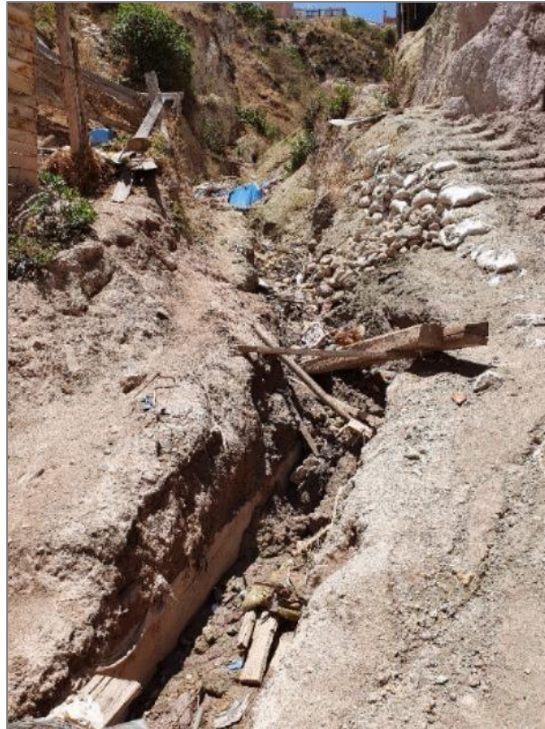
Fotografía 17. Zona baja de la cárcava, donde se acumula el material arrastrado por la escorrentía formada por las aguas pluviales, que erosionan y colmatan el canal de derivación sin revestir.
