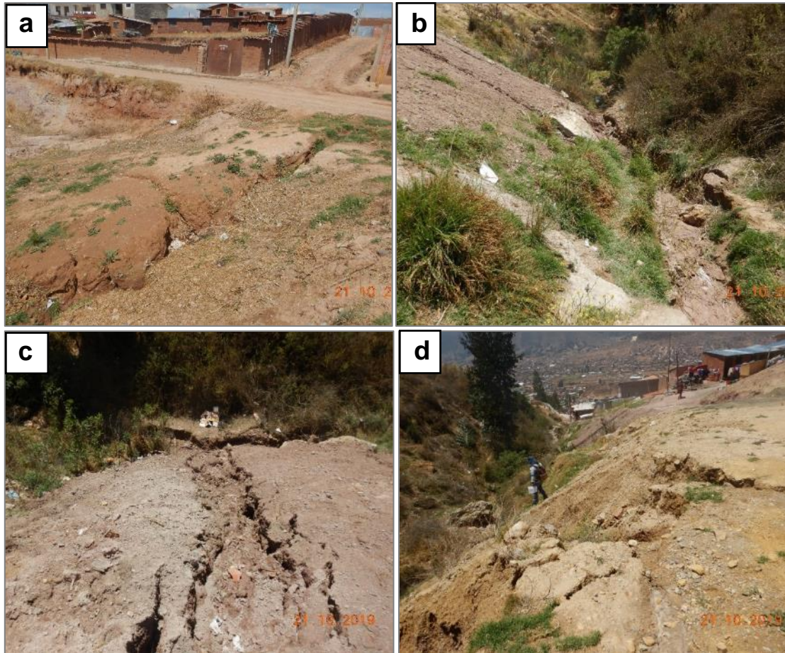
Figura 19. a) Canales de drenaje sin revestir. b y c) Erosión de laderas en surcos, originados en material de relleno, d) Derrumbes en la margen derecha de la cárcava.
