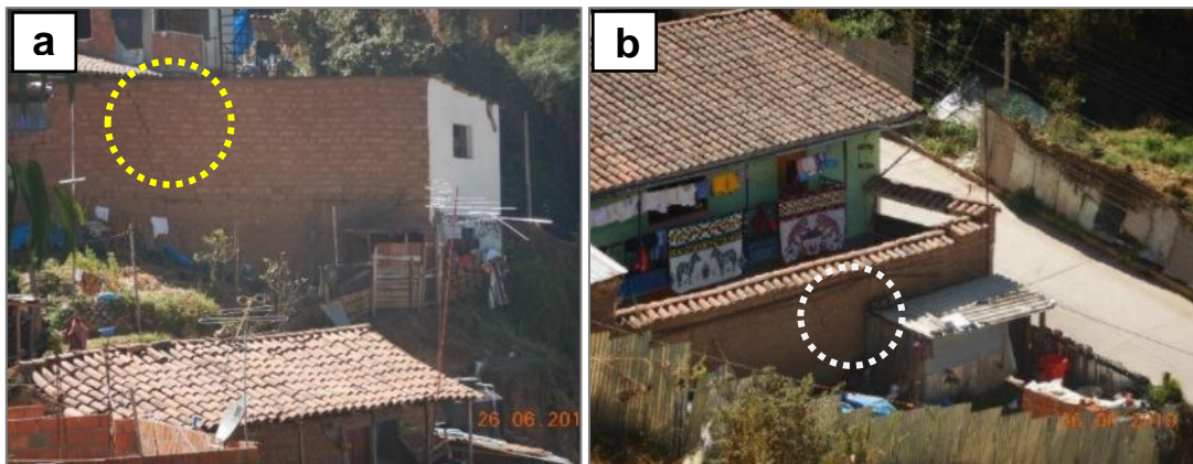
Figura 14. a, b) Vista de viviendas con paredes agrietadas producto del asentamiento del terreno.
