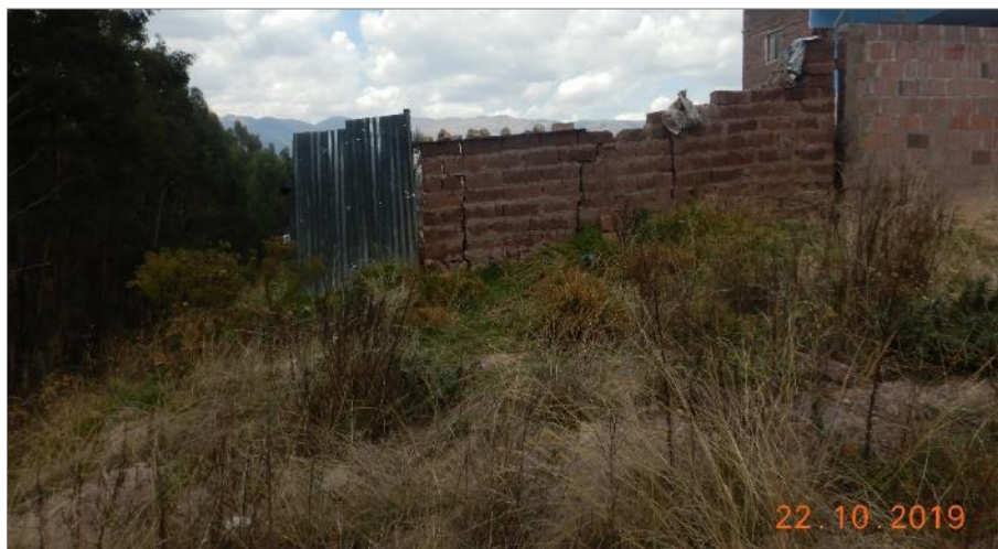
Fotografía 6. Vista de viviendas con paredes agrietadas producto del asentamiento del terreno.
