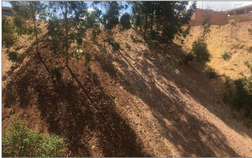
Fotografía 11. Material de relleno con pendiente entre 40-45°, ubicado a 20 m de la vivienda más cercana y con presencia de árboles inclinados.
