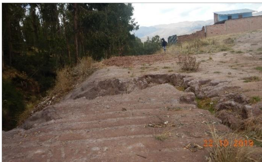
Fotografía 7. Erosión de ladera debido a la escorrentía superficial.
