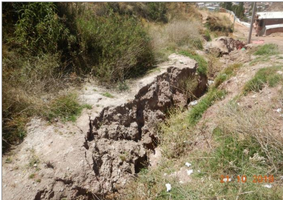
Fotografía 16. Erosión en la calle Inca Roca.
