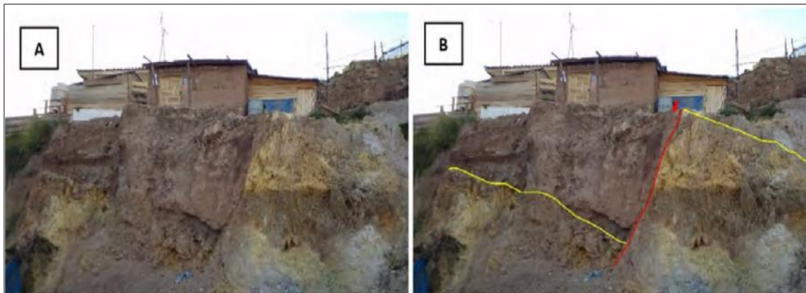
Figura 8. (A) Evidencia de falla en la zona de Alto Qosqo. (B) Fotografía interpretada donde la línea roja simboliza el escarpe de falla y las líneas amarillas son el tope del depósito cuaternario desplazado (Rosell, 2018).
