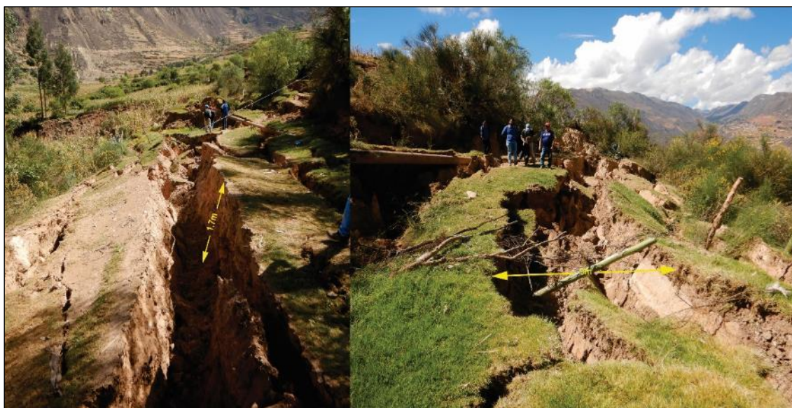
Figura 16. Se observa grietas transversales con aberturas de hasta 3 m y profundidades de 1.7 m; esta grieta se ubica en las coordendas UTM 8972893N, 277697E, a una altitud de 2835 m s.n.m.
