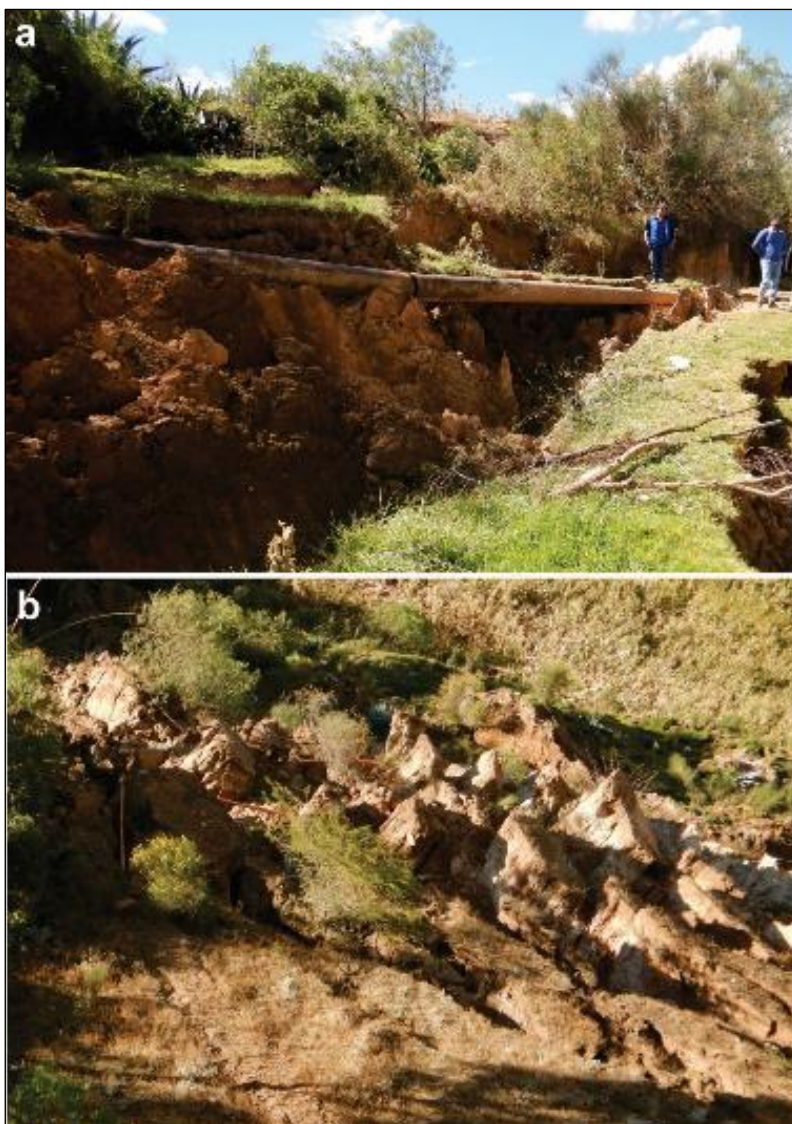
Figura 18. Vista con dirección al noreste, donde se puede observar: a) Afectación del canal matriz del centro poblado de San Pedro de Uchupata, b) se observa canal de riego destruido por el deslizamiento.
