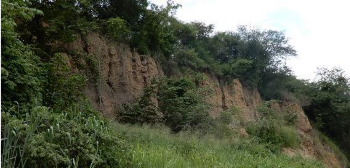
Figura 07. Corte de talud natural observados en el escarpe principal del deslizamiento vista de suroeste a noreste.
