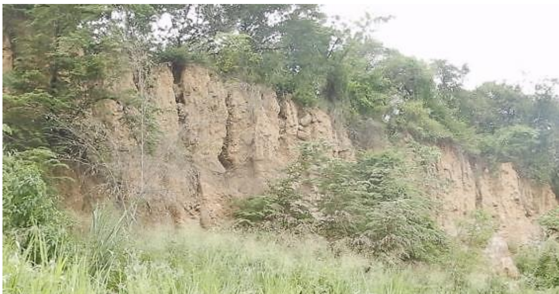
Figura 23. Erosión en las laderas y escarpes próximos al área urbana de La Florida.
