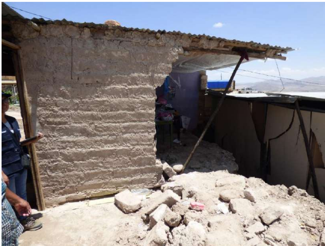
Fotografía 42: Colapso de muros en viviendas de la Asociación de Vivienda Sumac Wasi en la margen izquierda de la quebrada sin nombre.
