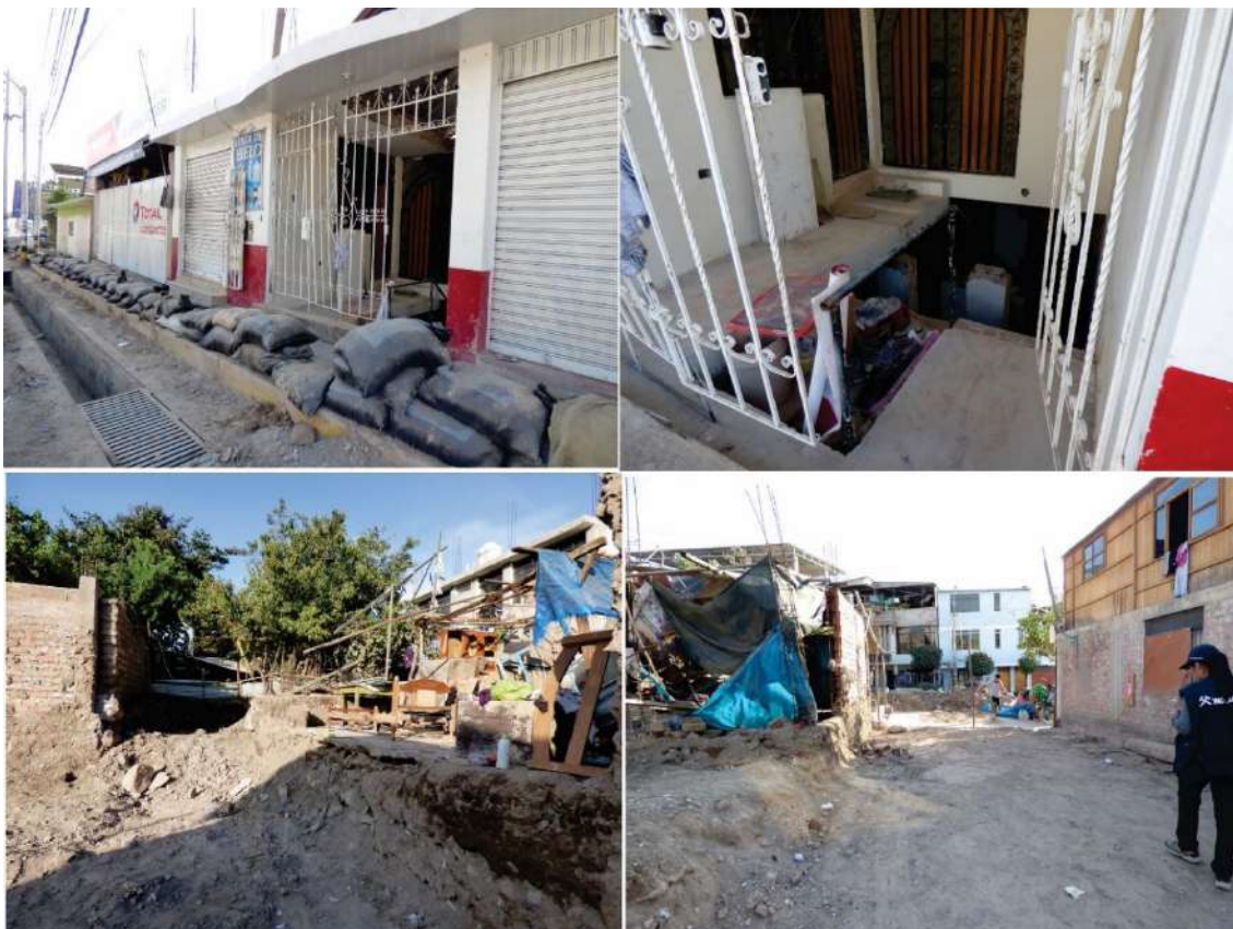
Figura 35: Vista de la vivienda de la Av. Andrés A. Cáceres por donde ingresó el flujo (arriba) y salió por la vivienda de lote D-26 de la calle Tupac Yupanqui (abajo).
