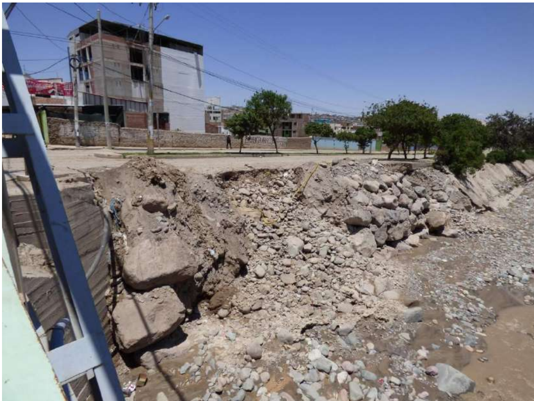
Fotografía 62: Vista aguas abajo del río Tumulaca, es posible observar la erosión en la margen izquierda que produjo la pérdida de parte de la vereda del malecón.
