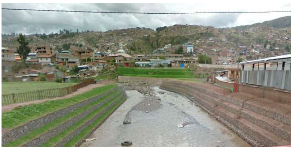
Fotografía 68: Vista donde se puede apreciar trabajos de encauzamiento de un río por medio de muro de gaviones.
