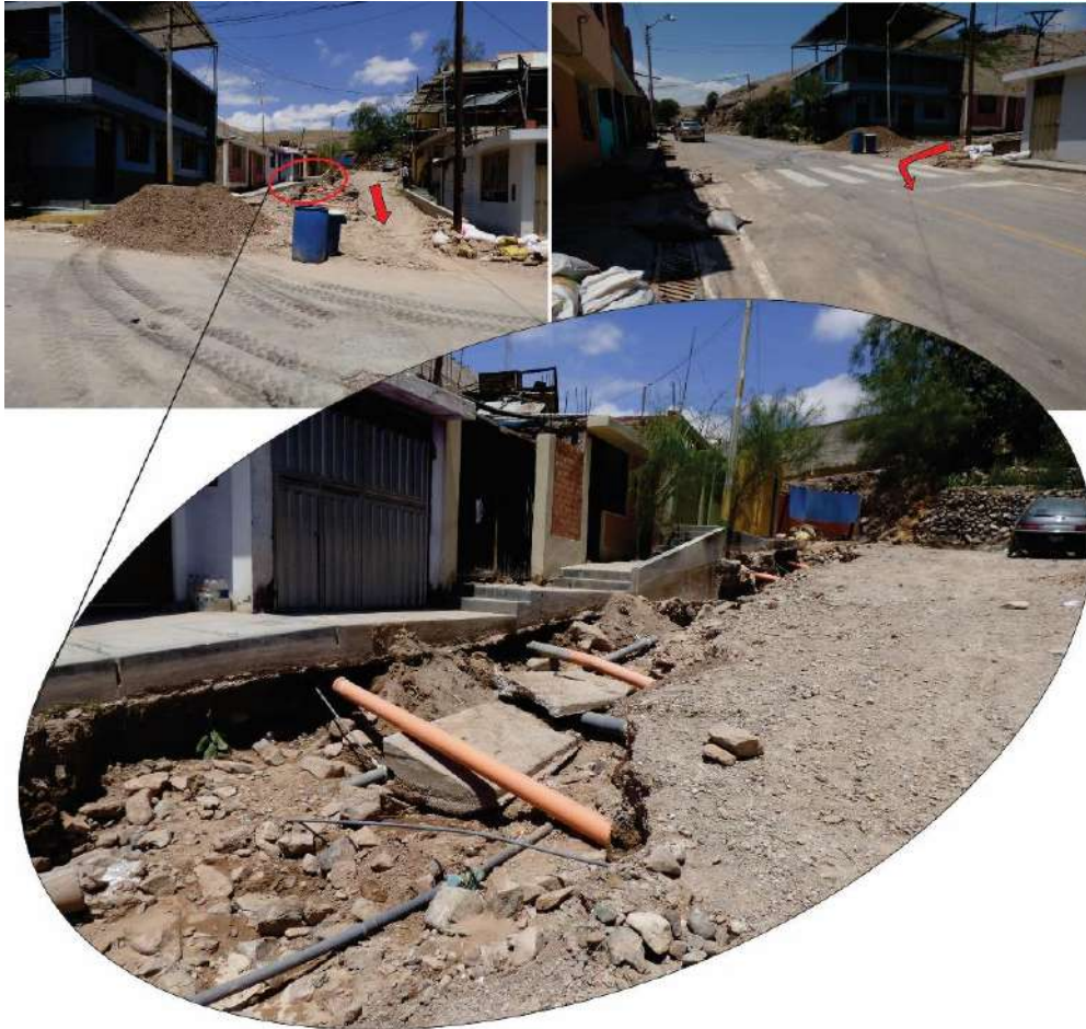
Figura 33: Vista de la socavación de la calle Los Ángeles producto del recorrido del flujo del 26 de febrero.
