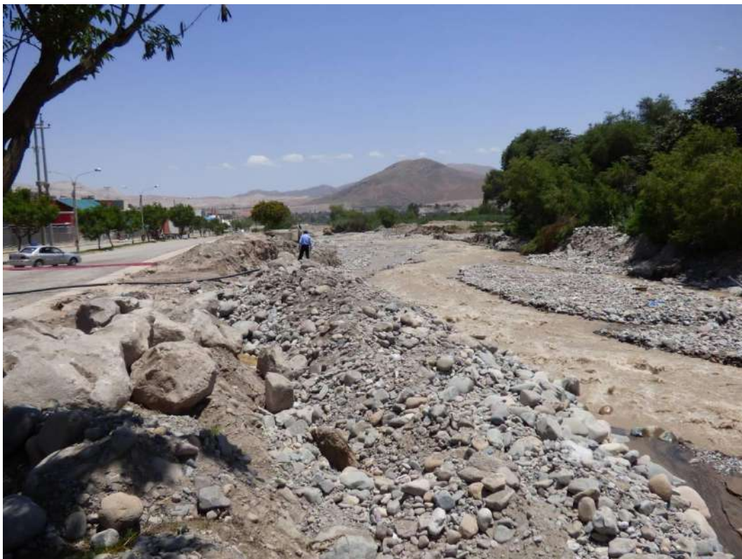
Fotografía 64: Vista aguas abajo del río Tumulaca a la altura del local principal del Gobierno Regional de Moquegua; es posible observar la erosión de la defensa ribereña de la margen izquierda.
