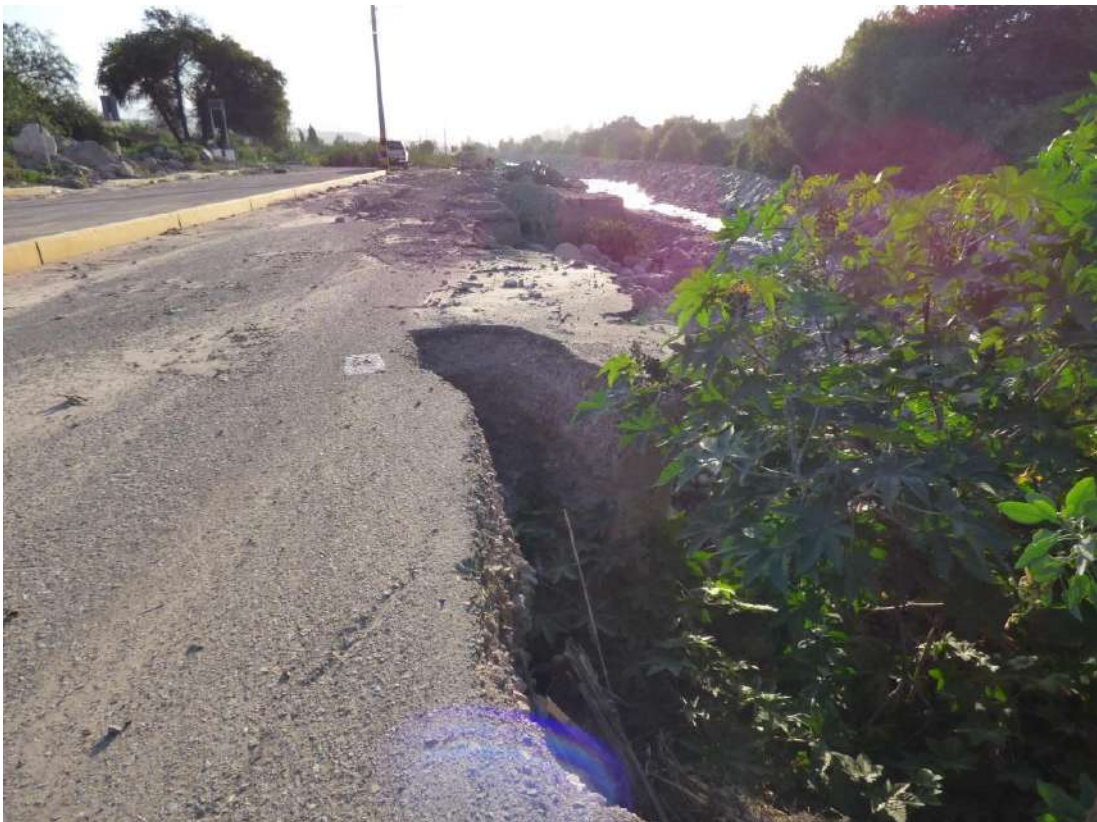
Fotografía 66: Vista hacia el suroeste de la pérdida de plataforma del malecón ribereño de Moquegua, en la margen izquierda del río Tumulaca.
