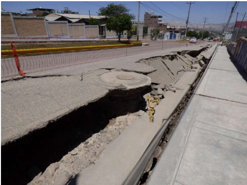
Fotografía 57: Vista suroeste, socavamiento de cuneta y 275 m de carpeta asfáltica de la Av. Andrés A. Cáceres, dejando los buzones de desagüe descubiertos.
