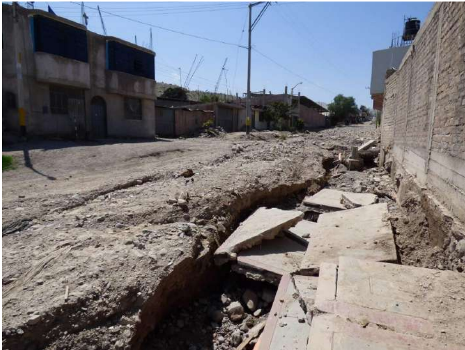
Fotografía 18: Vista aguas arriba de la quebrada Panteón en dirección al sureste, se observa que las viviendas se encuentran dentro del cauce de la quebrada, el cual no está definido; también se observa los efectos de socavamiento en la margen izquierda que puede afectar pared de concreto.
