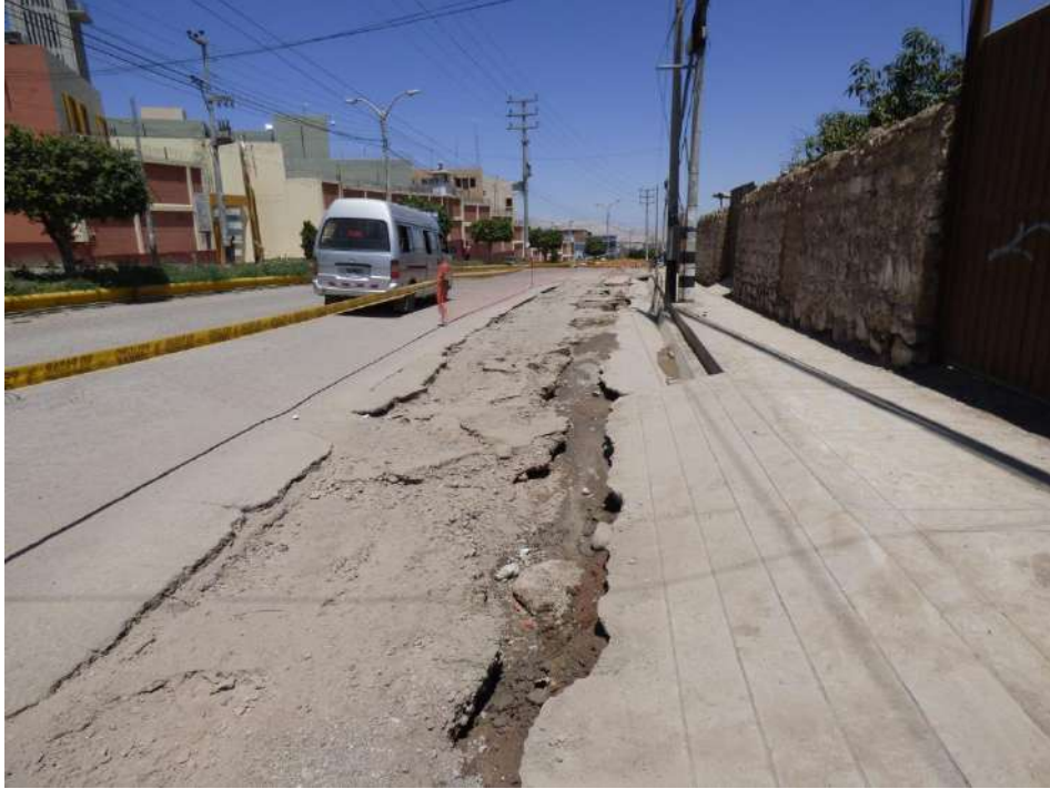
Fotografía 56: Socavamiento de la cuneta y de carpeta asfáltica frente al E.P Moquegua, en la Av. Andrés A. Cáceres.
