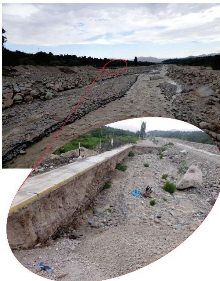
Figura 42: Vista con dirección al suroeste con erosión fluvial en ambas márgenes del río Tumulaca, donde el año 2019 destruyó parte de los muros de encauzamiento, removió bloques y material arrimado, en el círculo rojo se puede observar el detalle de la pérdida de la plataforma del malecón ribereño, en la margen izquierda del río.
