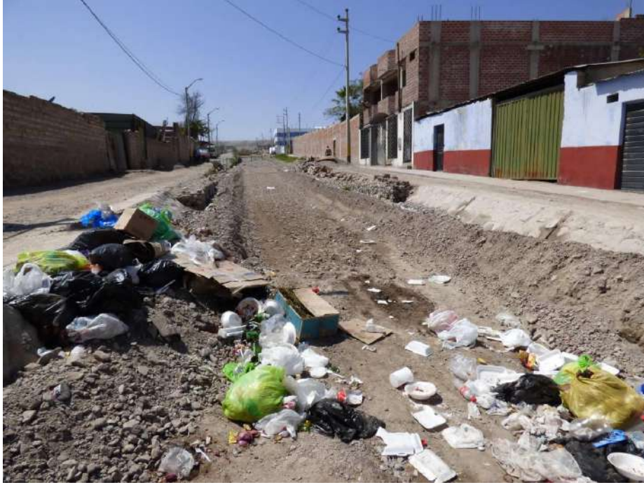
Fotografía 17: Vista con dirección al noroeste, se observa el cauce antropizado de la quebrada Panteón con muros de concreto y la construcción de viviendas; el cauce aparece colmatado con material gravo-arenoso; también se arroja basura en la zona.
