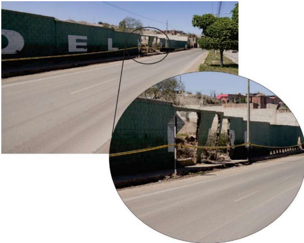
Figura 37: Colapso del muro del Cuartel Los Ángeles desde la Av. Andrés A. Cáceres.
