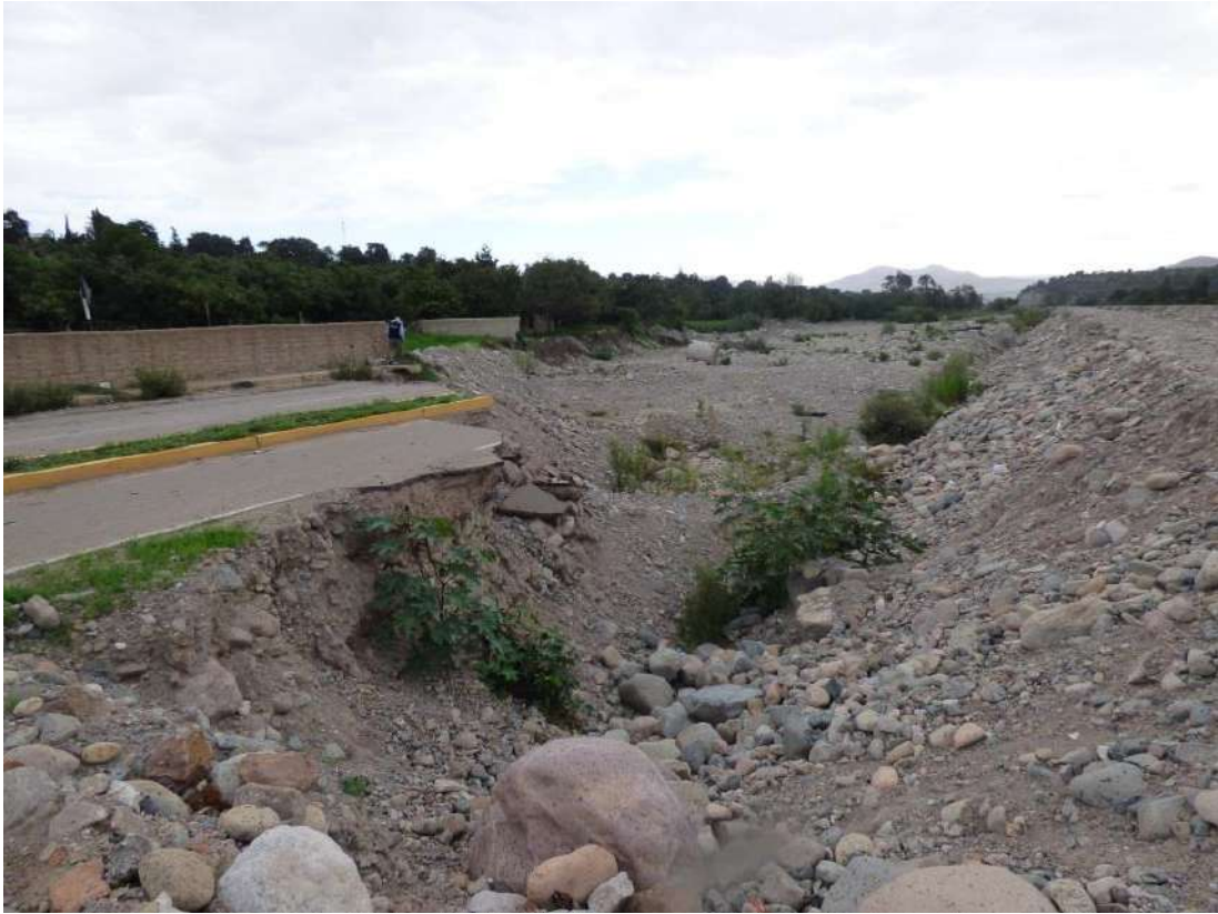
Fotografía 65: Erosión fluvial en la margen izquierda del río, se llevó un tramo de la plataforma del malecón ribereño, callejón San Juan, con vista al suroeste.
