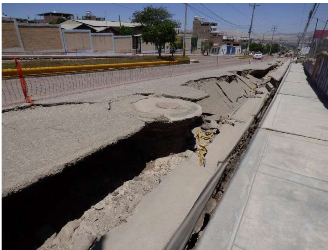
Fotografía 43: Con vista al suroeste, Av. Andrés Avelino Cáceres la cual fue afectada por los flujos que discurrieron por las calles perpendiculares a esta avenida, haciendo una especie de vía colectora de todos estos flujos que discurrieron por Samegua.
