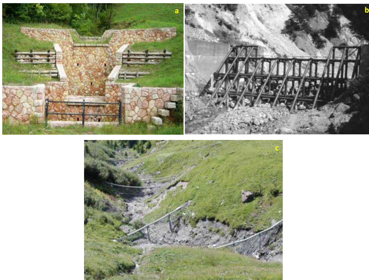
Figura 50: Presas tipo SABO de sedimentación escalonada para controlar la fuerza destructiva de los huaicos, a) de control; b) tipo rejilla; c) barras flexibles.
