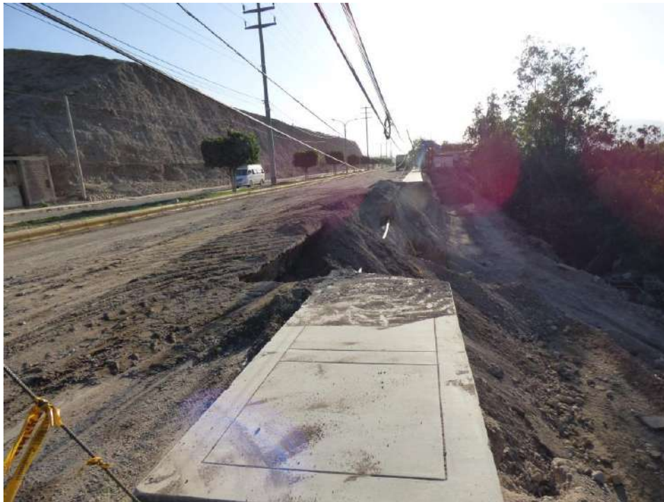
Fotografía 60: Vista al suroeste, el huaico socavó 28 m de vereda y carpeta asfáltica de la Av. Andrés A. Cáceres.
