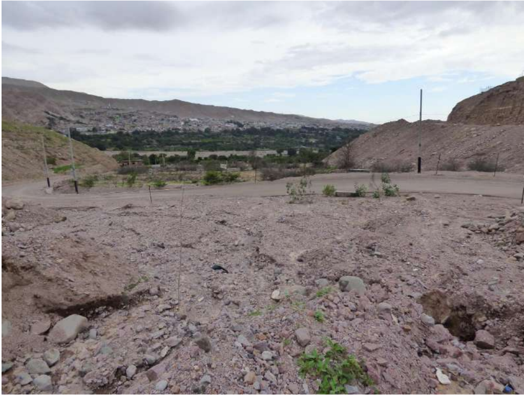
Fotografía 11: Vista con dirección al suroeste donde se puede observar el material gravo-arenoso acarreado por el flujo de detritos que bajo por quebrada seca; la carretera de acceso a la localidad Los Ángeles, fue socavada en sus extremos y en parte cubierta por material detrítico; también se afectaron terrenos de cultivo ubicados entre del cauce de la quebrada.
