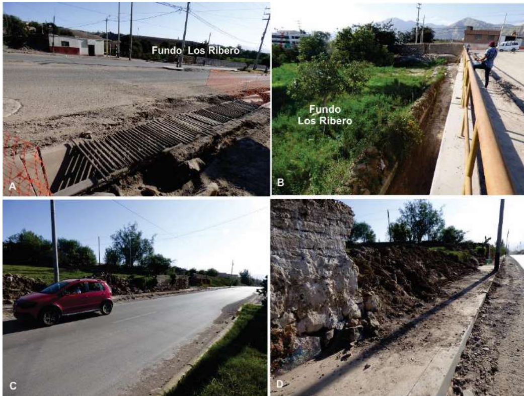
Figura 40: A y B) Huaico que afectó Fundo Los Ribero, así como cunetas y carpeta asfáltica de la Av. Andrés A. Cáceres. C y D) Debido al empuje del huaico colapso el muro perimétrico del Fundo, en la Av. Andrés A. Cáceres.
