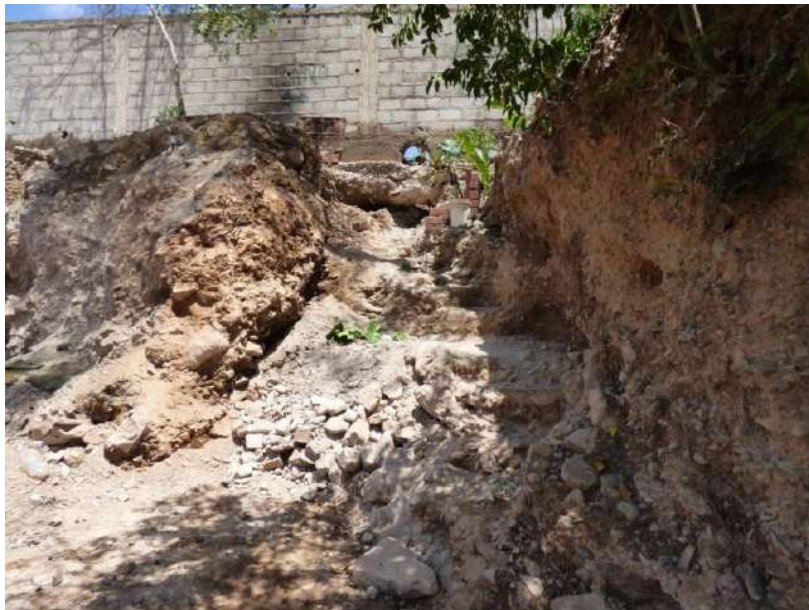
Fotografía 51: El 26 de febrero se tuvo que perforar la parte inferior del muro perimétrico del cuartel Los Ángeles, para que pueda discurrir el huaico y así evitar el anegamiento, porque no cuenta con desfogue, a su paso socavó hasta dejar descubierta las tuberías de agua y desagüe del pasaje Los Ángeles, el flujo alcanzó 1 m de altura. Esto afectó viviendas.
