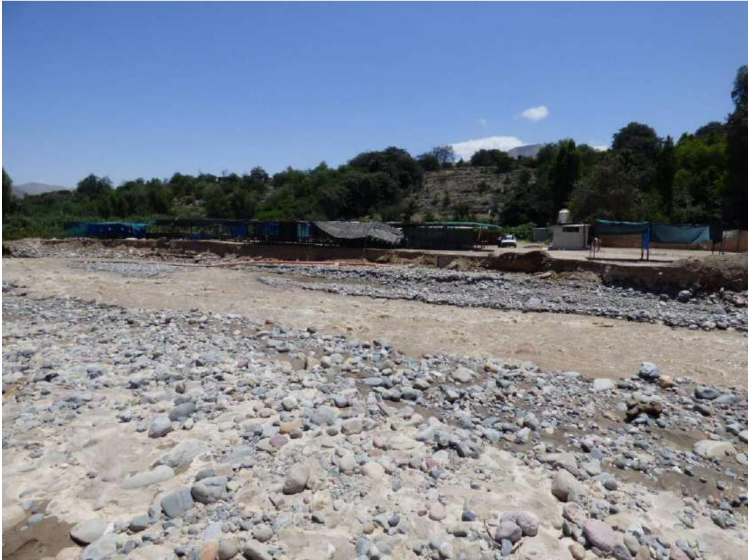
Fotografía 63: Vista aguas abajo del río Tumulaca, se puede observar la margen derecha afectada por erosión, produjo la pérdida de terrenos de un mercado, así también afectó tuberías de desagüe.
