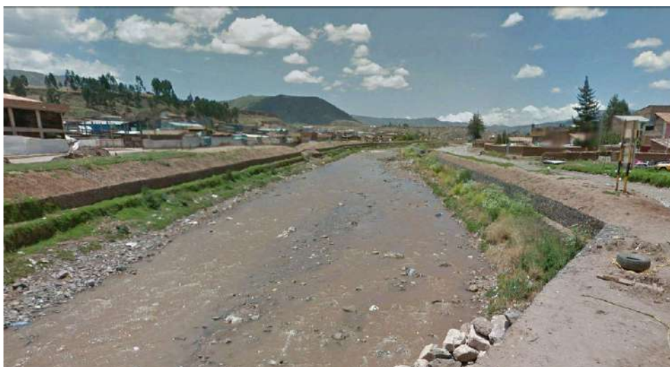
Fotografía 69: Otra vista de la aplicación del muro de gaviones como elemento de encauzamiento de río y protección ante desbordes y erosión fluvial.
