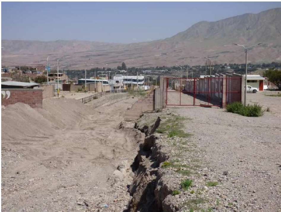
Fotografía 16: Vista con dirección al noroeste, se inicia el tramo encausado con gaviones de la quebrada Panteón, a la altura de la Universidad Privada; se colocó un muro de ladrillos transversal a la quebrada y un portón de metal, que fueron destruidos por los flujos de detritos que bajan por la quebrada.
