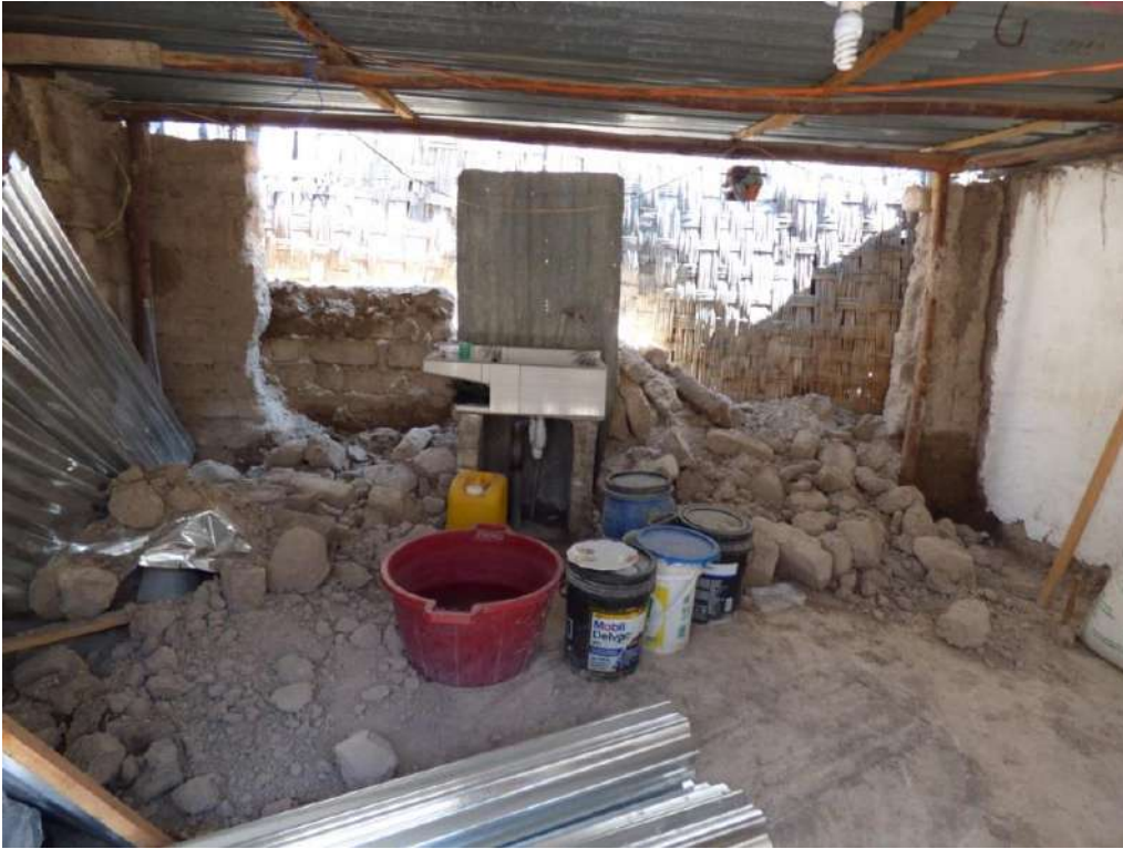
Fotografía 40: Muros colapsados por los huaicos que discurrieron de las laderas del mirador Cristo Blanco en viviendas de la Asociación 10 de Mayo.
