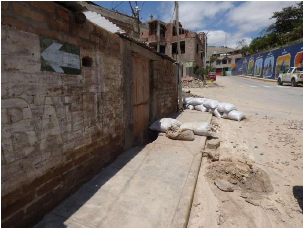
Fotografía 52: Vista de la marca del flujo alcanzó 50 cm de altura en la calle Tupac Yupanqui.
