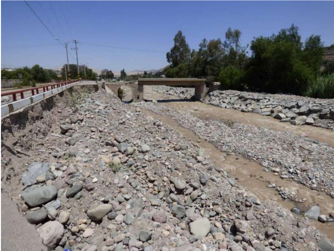
Fotografía 61: Vista aguas abajo del río Tumulaca, se puede observar la erosión en la margen izquierda, que produjo la pérdida de la mitad de la plataforma de la pista Malecón Ribereño. es posible observar el estrechamiento del cauce del río con la construcción de puentes.
