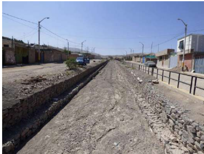
Fotografía 8: Vista con dirección al noroeste, se puede observar el tramo encauzado de la quebrada Panteón por medio de gaviones; así también, el cauce es ocupado por viviendas.
