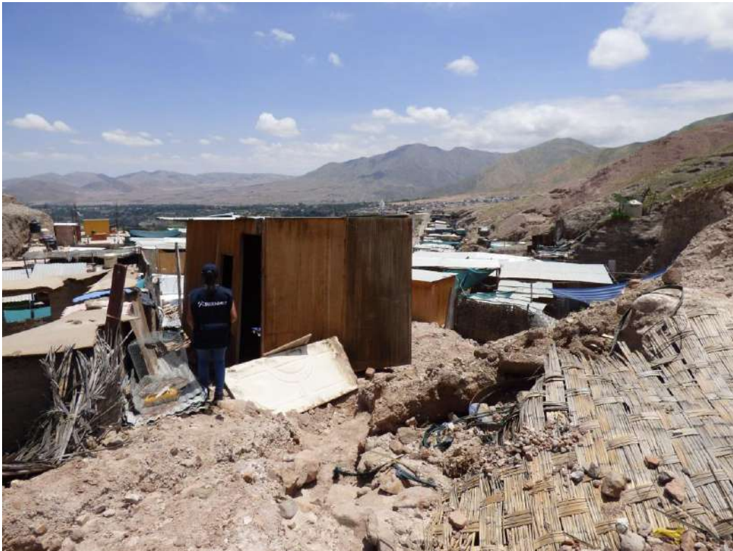
Fotografía 41 Viviendas de la Asociación de Vivienda Sumac Wasi, se encuentra en el mismo cauce de quebrada seca sin nombre, por donde discurrió un huaico el 26 de febrero.
