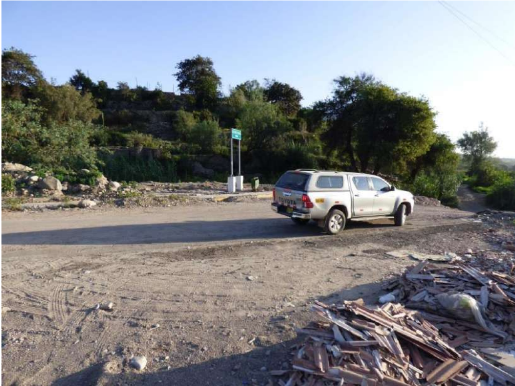
Fotografía 67: Erosión fluvial en la margen izquierda del río Tumulaca, sector pasaje El Pedregal.
