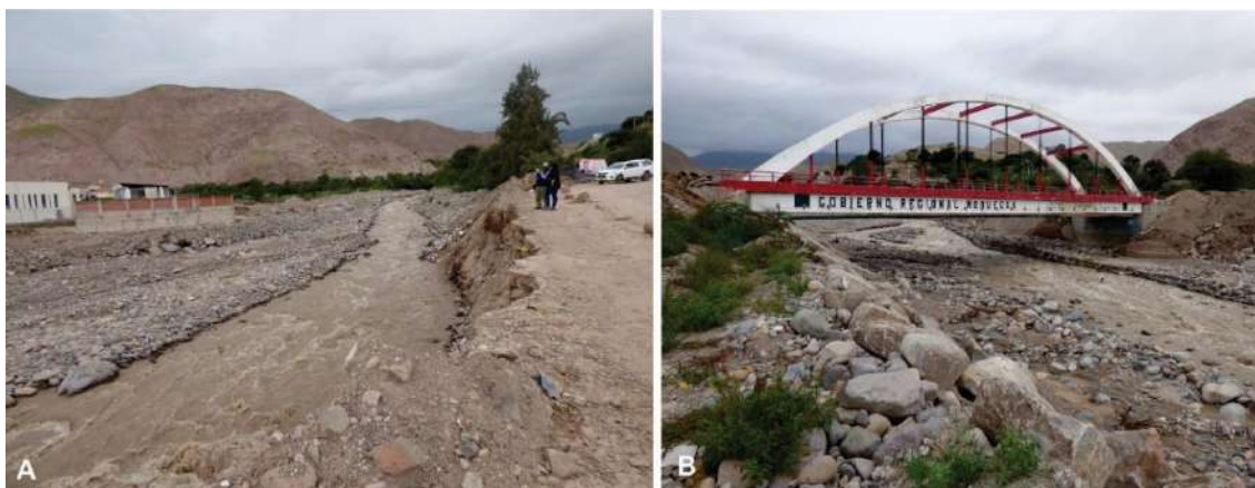
Figura 41: Vista con dirección al noreste, se observa erosión fluvial en la margen izquierda del río Tumulaca, afectó pista del malecón (A) y estribos del puente de acceso a la Residencial Country Club (B).
