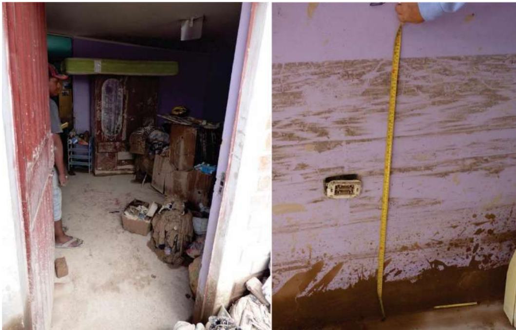
Figura 31: Vivienda ubicada en el cruce de la calle Tahuantinsuyo y San Pedro, el flujo de lodo alcanzó 0.96 m de altura.
