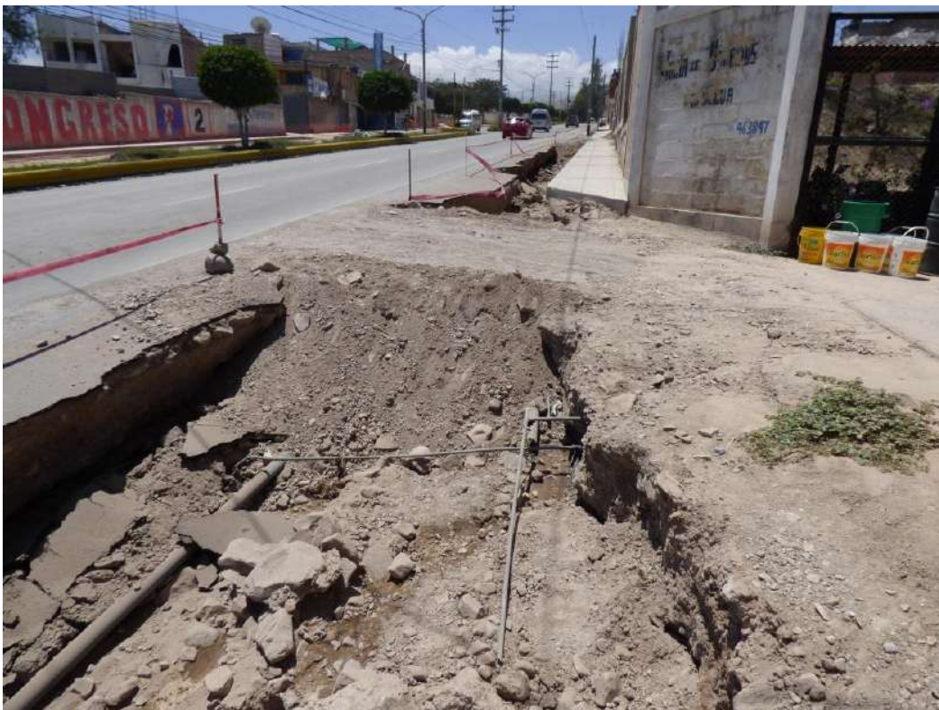
Fotografía 58: Vista Noreste, socavamiento de vereda y carpeta asfáltica, la energía del flujo generó una zanja, dejando descubiertas las tuberías de agua, en ambos lados de la Av. Andrés A. Cáceres.
