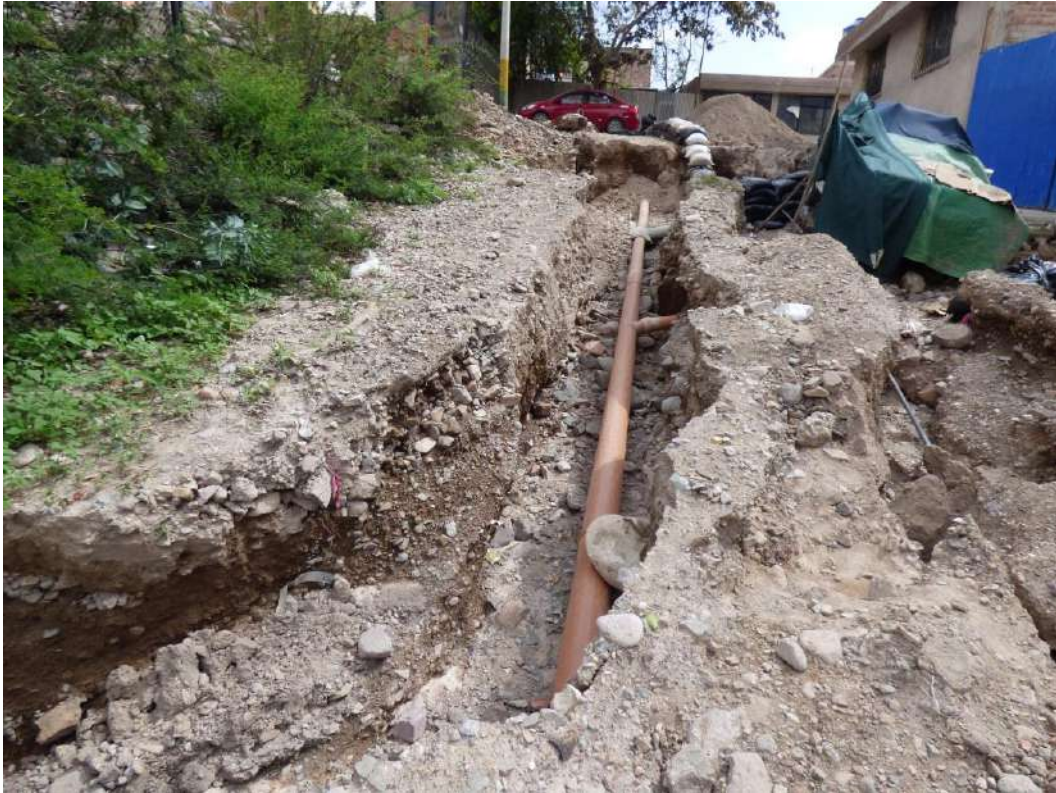
Fotografía 44: Redes de agua potable colapsaron por el paso del flujo que discurrió por una margen del estadio Maracaná.
