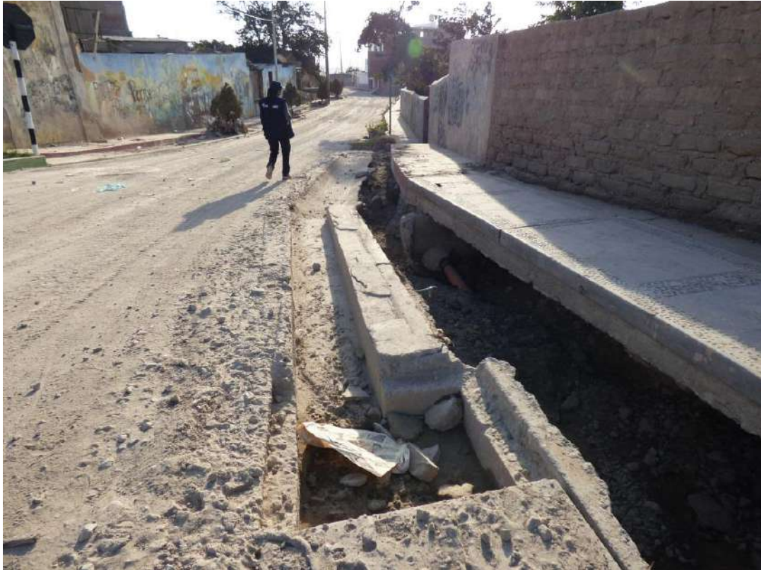
Fotografía 54: El flujo socavó las veredas de la calle Antigua Samegua.
