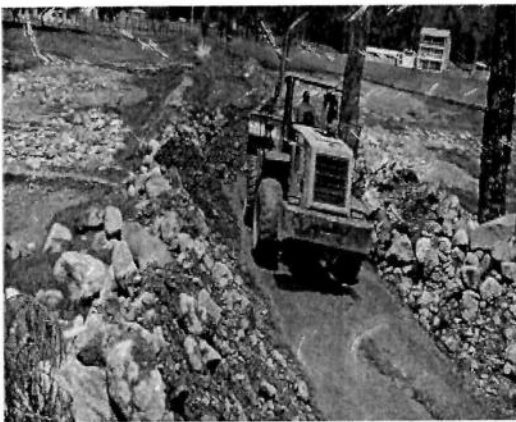
FOTO 05: Se Aprecia la descolmatación de los materiales traídos en las avenidas y que producen el desborde de la Quebrada Salacc.
