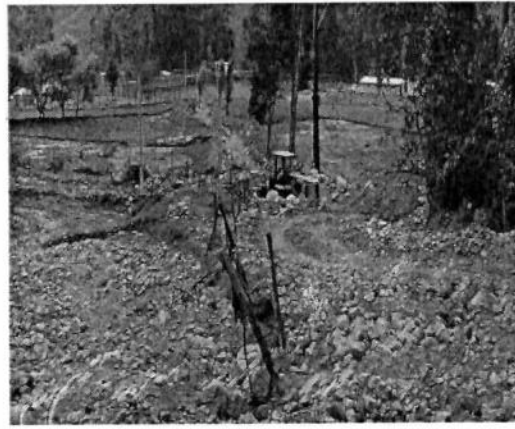
FOTO 02: Se Aprecia los materiales traídos en las avenidas ingresando a terrenos de Cultivo de los Pobladores, y la obstaculización de la carretera de ingreso al Pueblo.
