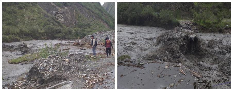
Imagen N° 23: Afectación del puente Chacas en el centro poblado de San Miguel de Opayaco.
