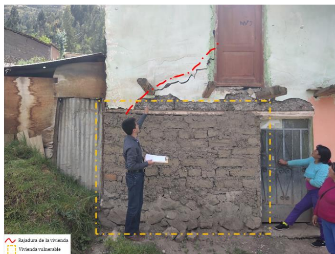
Imagen N° 13: Viviendas afectadas en el Anexo de Huarcon
