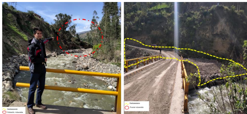
Imagen N° 22: Afectación de las viviendas por la erosión fluvial y afectación del puente Santa Rosa en el centro poblado de San Miguel de Opayaco.
