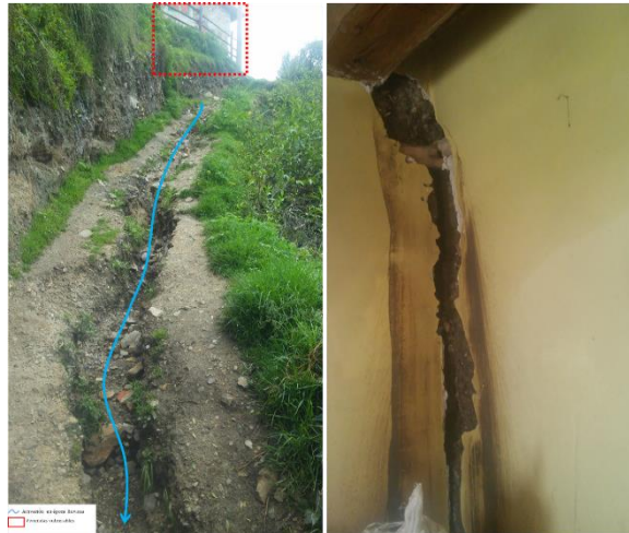
Imagen N° 20: Formación de surcos en época lluviosa y afectación de la vivienda.
