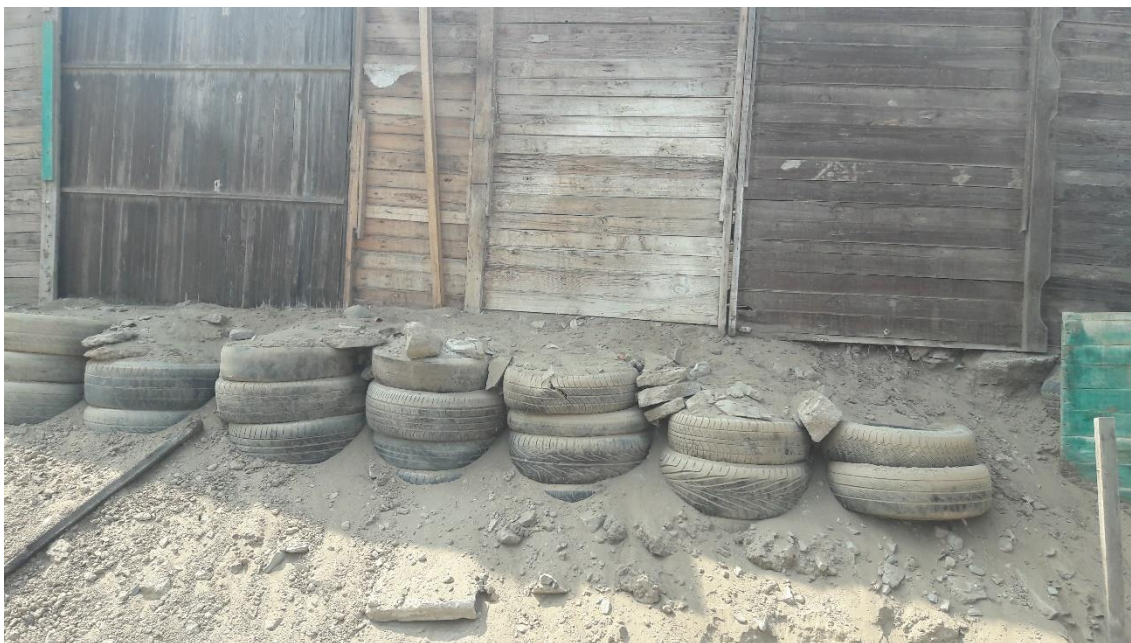
Viviendas de material precario, no tienen cimentación
