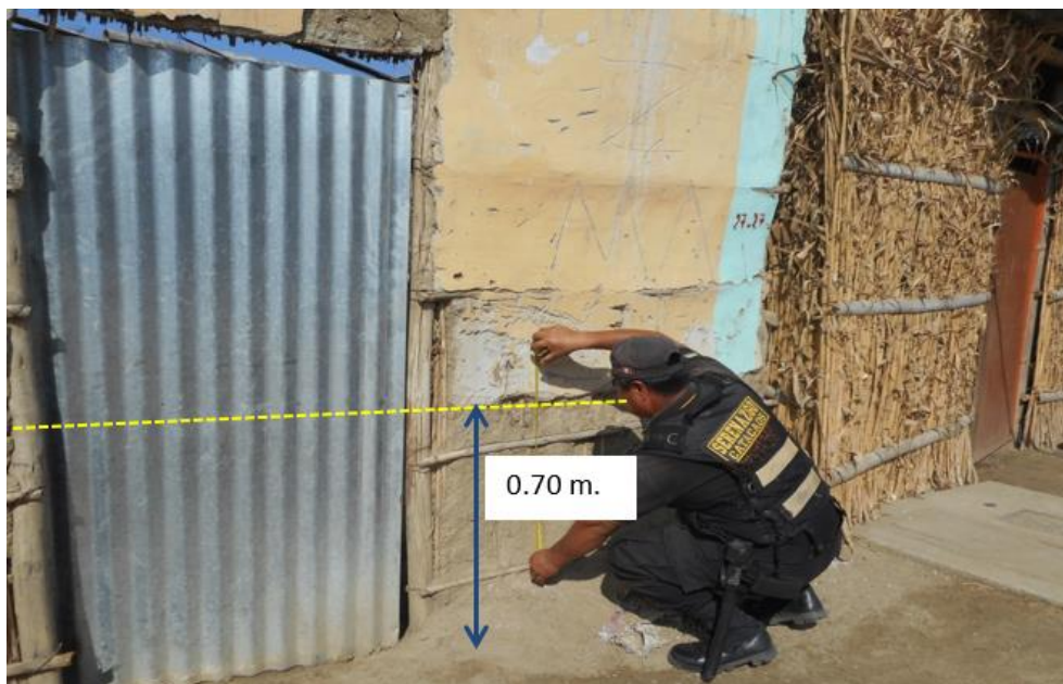
Figura 19: En algunos sectores como Rinconada, el nivel de agua llegó a 0,70 m., en algunas viviendas aún se evidencia la marca.
