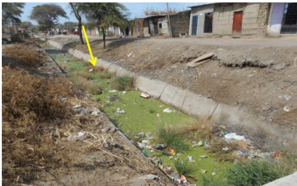
Figura 26: Estancamiento de agua en los drenes, debido a la falta de mantenimiento, esto podría ocasionar proliferación de enfermedades. Esto se observó en el sector Villa Hermosa.
