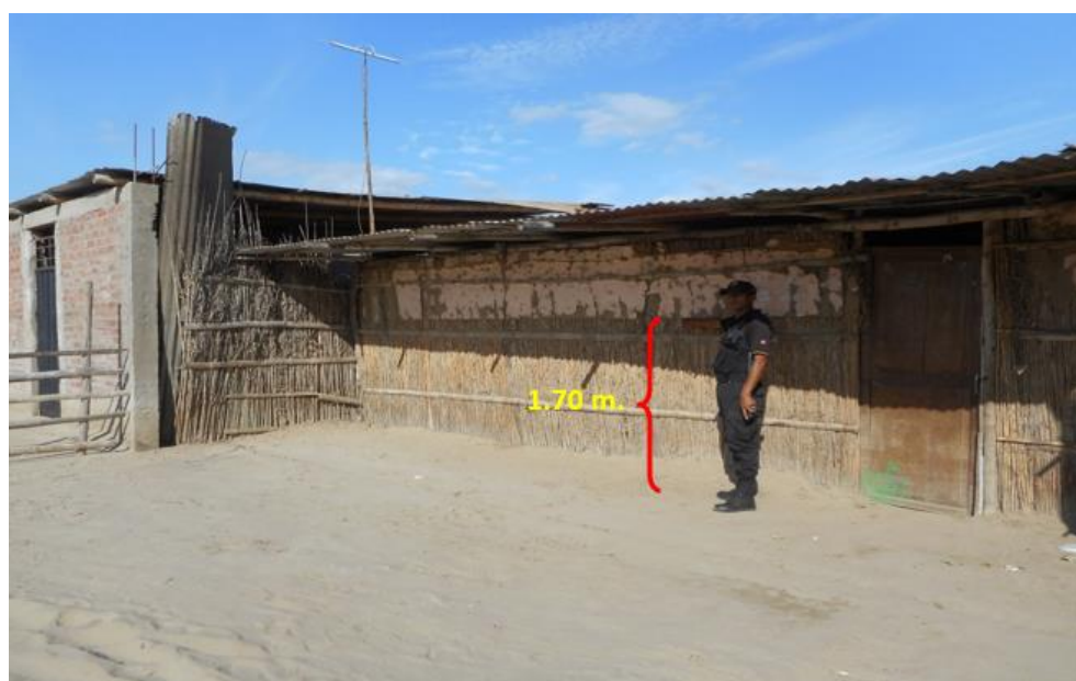
Figura 18: Inundación fluvial en el sector de Viduque, altura de inundación de 1.70 m.
