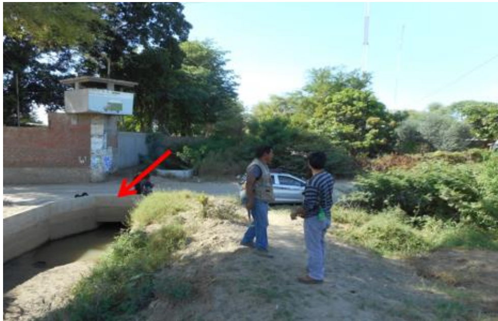
Figura 23: Canal que divide La Legua y San Jacinto, tiene una profundidad de 1.50 m. y un ancho de 2.30 m., en época de lluvias extraordinarias supera su capacidad y se desborda, afectando áreas agrícolas y algunas viviendas del sector.
