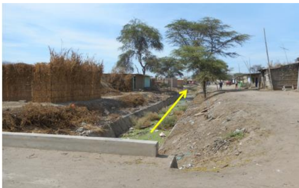
Figura 24: Zona de inundación pluvial, en el sector de Nuevo Catacaos e incluso, a la fecha de exploración, aún existía agua estancada del evento Fenómeno del Niño del 2017. La línea amarilla señala la dirección del flujo.
