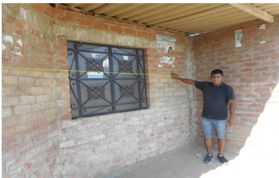
Figura 20: En algunas viviendas aún queda la marca del nivel de agua que llegó a medir 1.70 m. (línea amarilla), esto en el sector de Pedregal Chico.
