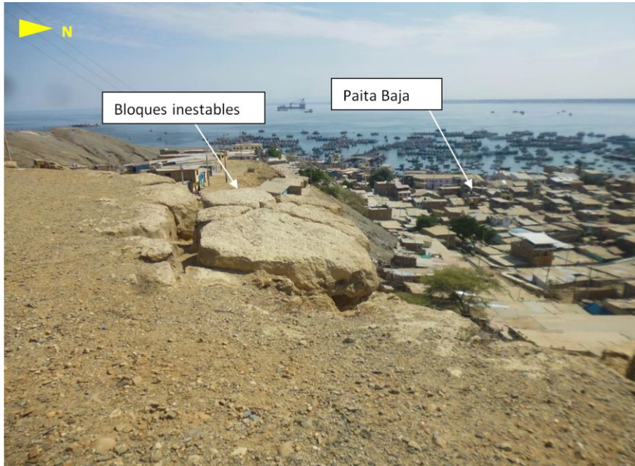
Figura 23: Bloques sueltos, estos podrían desprenderse (procesos gravitacionales) y afectar las viviendas que se asientan en Paita Baja.
