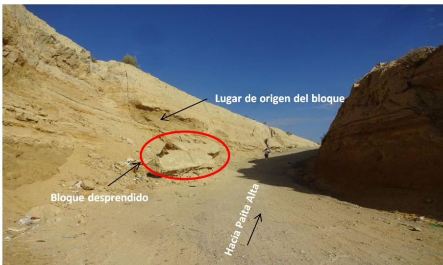
Figura 24: Caída de rocas en vía de acceso al cerro Llorón.
