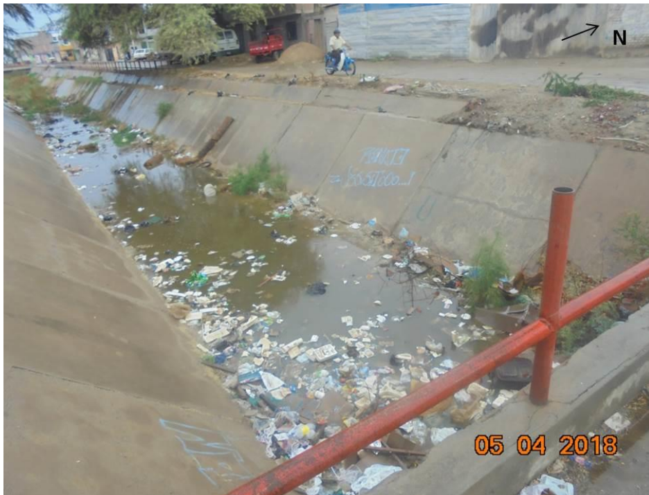
Figura 32: Acumulación de desechos antrópicos en el cauce del dren Almirante.
