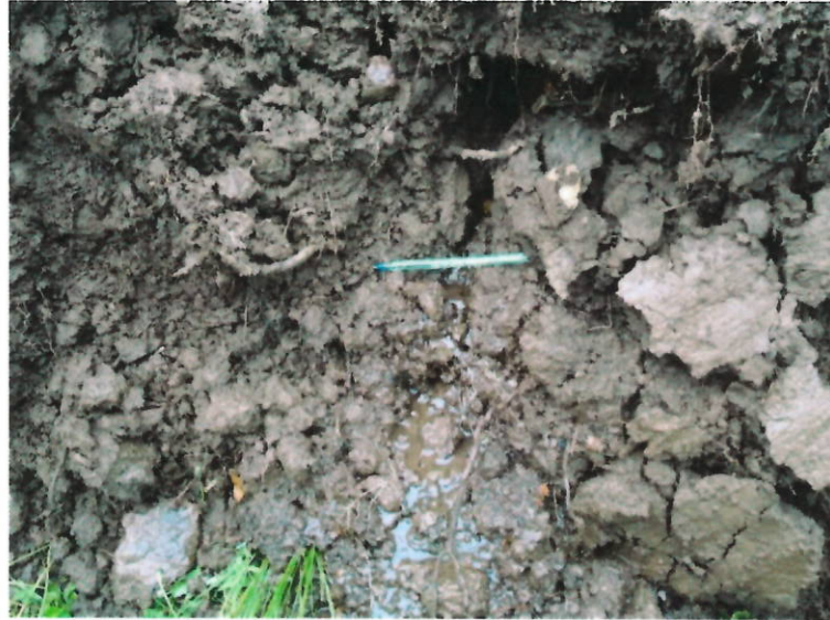
Fotografía 5. Agrietamiento por el que surge agua en forma de manantial.
