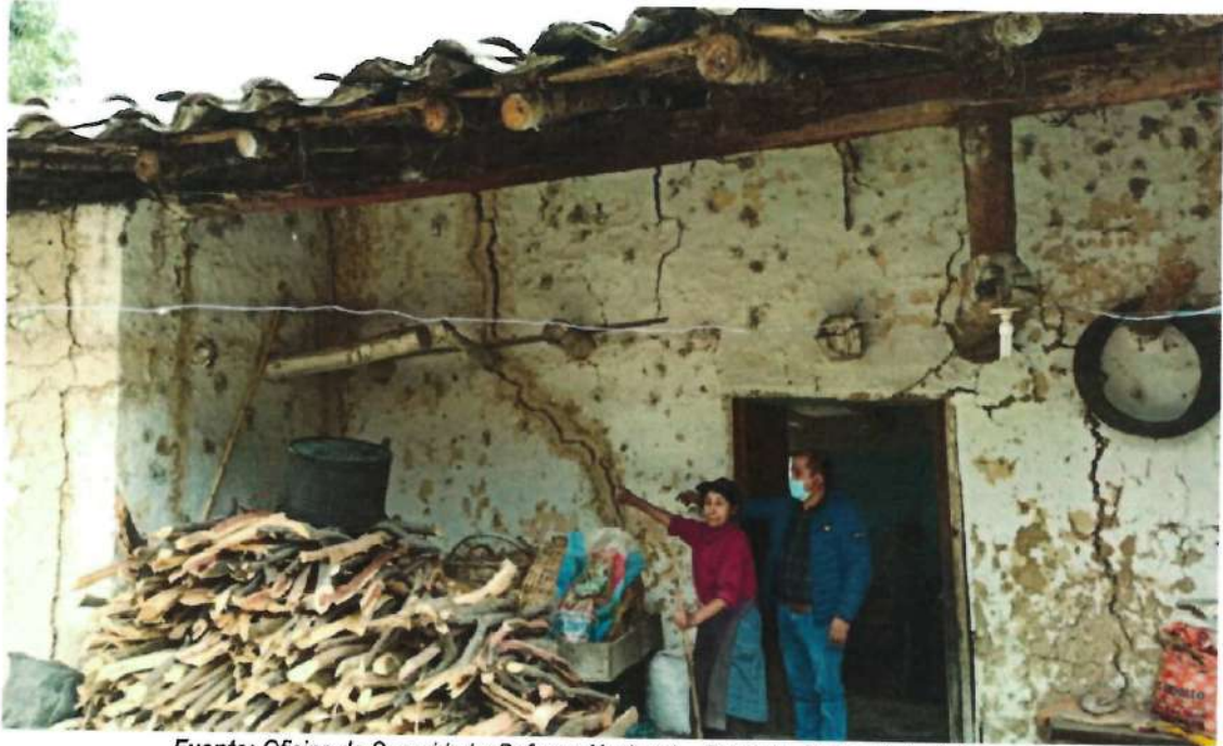
Fotografía 15. Vivienda afectada por el sismo del 3 de agosto en el poblado de la Colpa.
