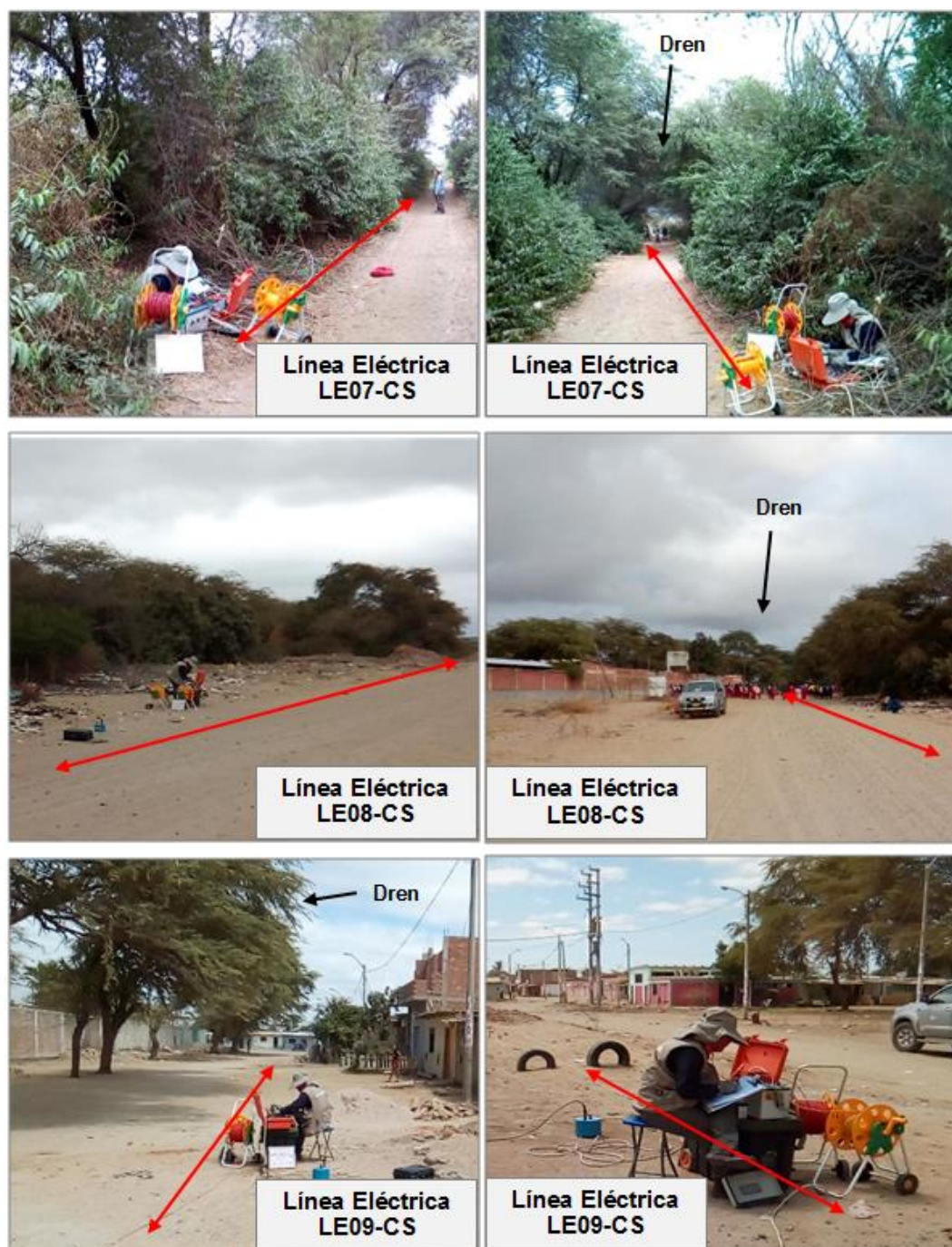
Figura 25: Vista de las líneas eléctrica LE07-CS, LE08-CS y LE09-CS.
