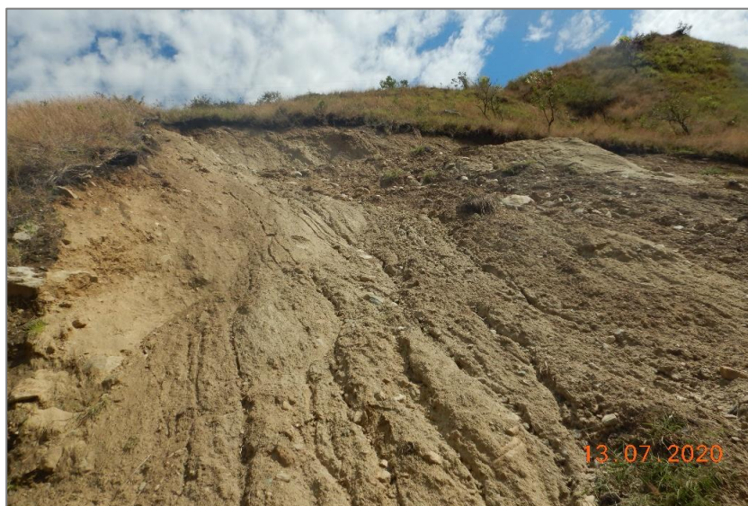
Fotografía 6. Vista de un deslizamiento en la ladera sur de la mesa El Potrero, debido a los cortes de talud.
