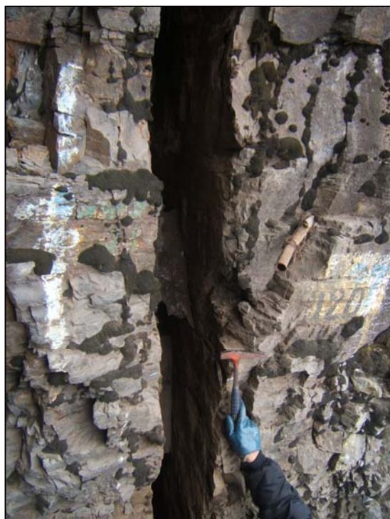
Foto 9.- Vista del fracturamiento y grieta en el macizo rocoso.
