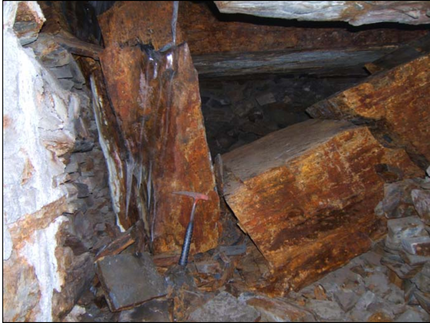
Foto 14. - Colapso del bloque rocoso en labor subterránea, por la ausencia del pilar.
