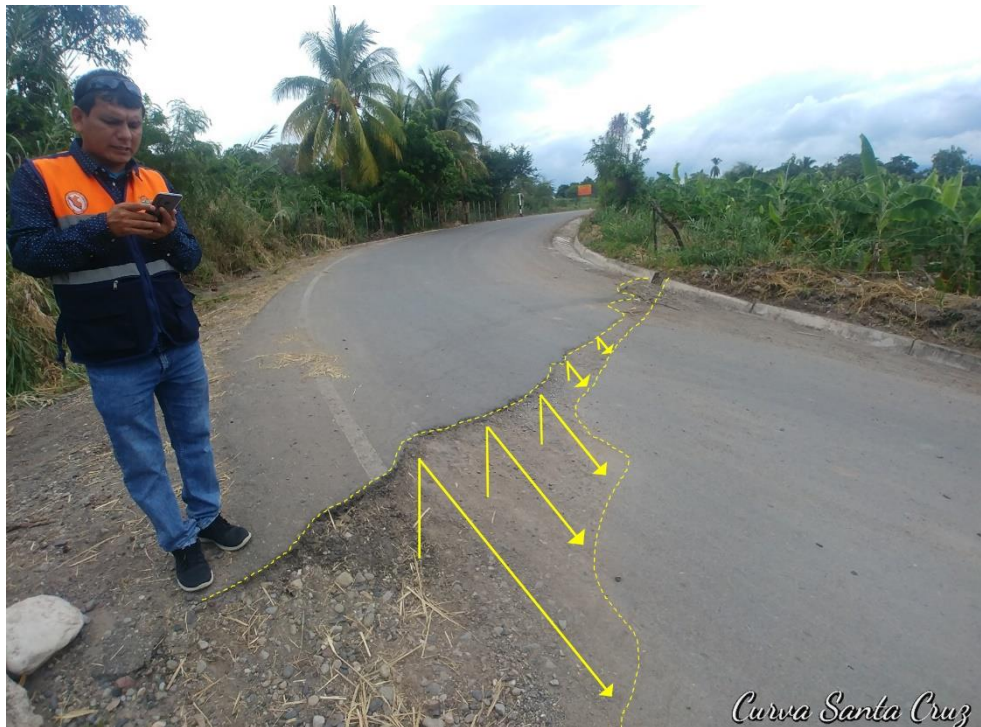
Figura 14. Grietas en la carretera, se observa el hundimiento de la misma en este sector, ubicado con coordenadas UTM WGS-84, Este: 789473 y Norte: 9363045.
