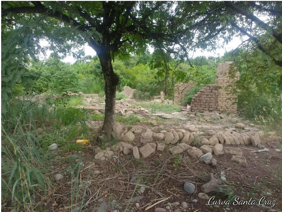
Fotografía 4. Vivienda destruida en la parte baja del deslizamiento, ubicada con coordenadas UTM WGS-84, Este: 789517 y Norte: 9363069.
