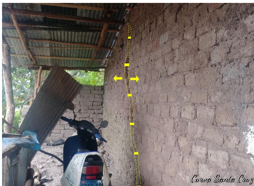
Figura 12. Se observa desplazamiento horizontal en grieta de pared de vivienda, con un promedio de 4 cm de desplazamiento.
