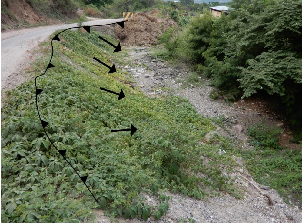
Figura 9. Escarpe del deslizamiento, destruyó la carretera, se puede observar el desplazamiento vertical de la carretera, la cual quedó destruida, ubicado con coordenadas UTM WGS-84, Este: 789692 y Norte: 9363131.
