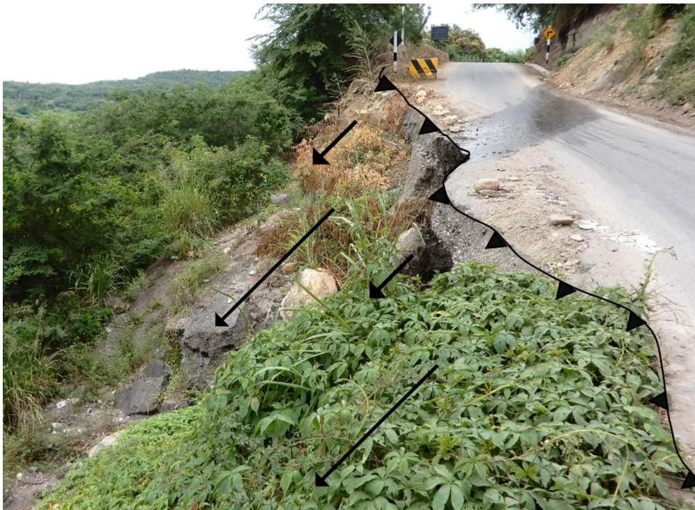
Figura 10. Escarpe del deslizamiento, destruyó la carretera, se puede observar socavamiento en el talud de relleno consecuencia del escurrimiento de agua en la plataforma debido a la colmatación de las cunetas, ubicado con coordenadas UTM WGS-84, Este: 789669 y Norte: 9363039.
