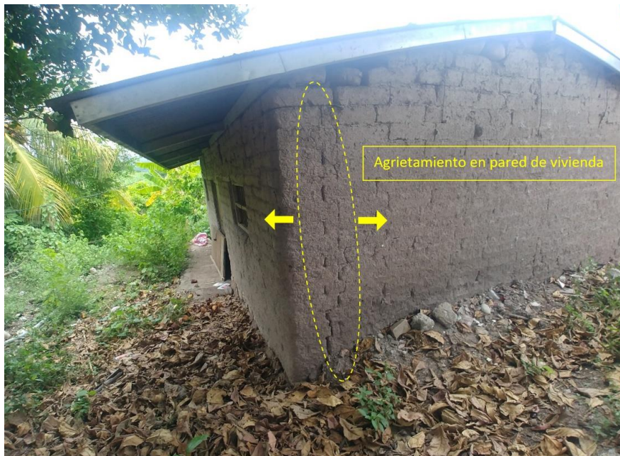
Figura 11. Se observa agrietamiento de pared de adobe de una vivienda del sector La Curva Santa Cruz, con un ancho promedio de 3 cm, ubicada con coordenadas UTM WGS-84, Este: 789608 y Norte: 9362870.
