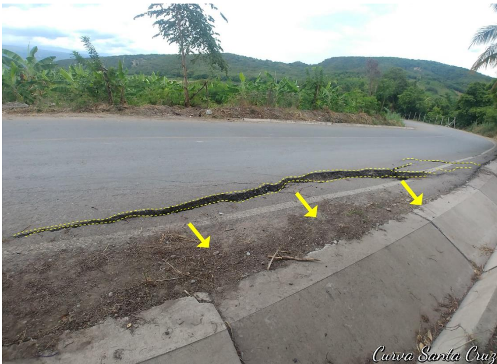
Figura 13. Grietas en la carretera, se observa el desplazamiento vertical hacia el talud de corte, ubicado con coordenadas UTM WGS-84, Este: 789502 y Norte: 9363069.
