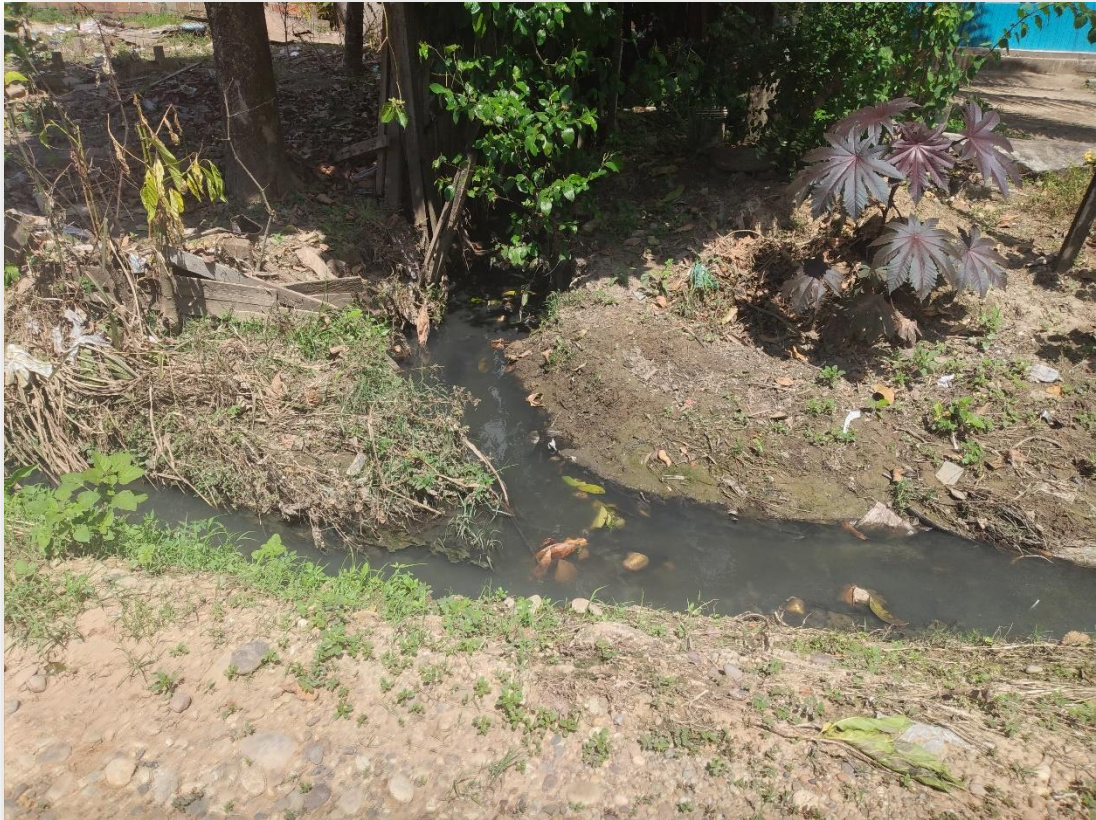
Fotografía N° 5. Cauce de la quebrada natural colmatado.
