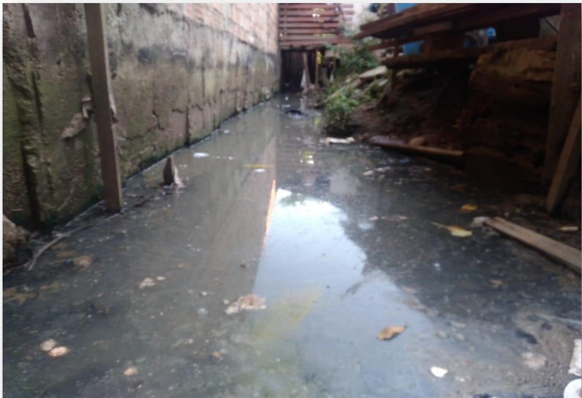
Fotografía N° 10. Quebrada natural colmatada y con el cauce reducido por construcciones.
