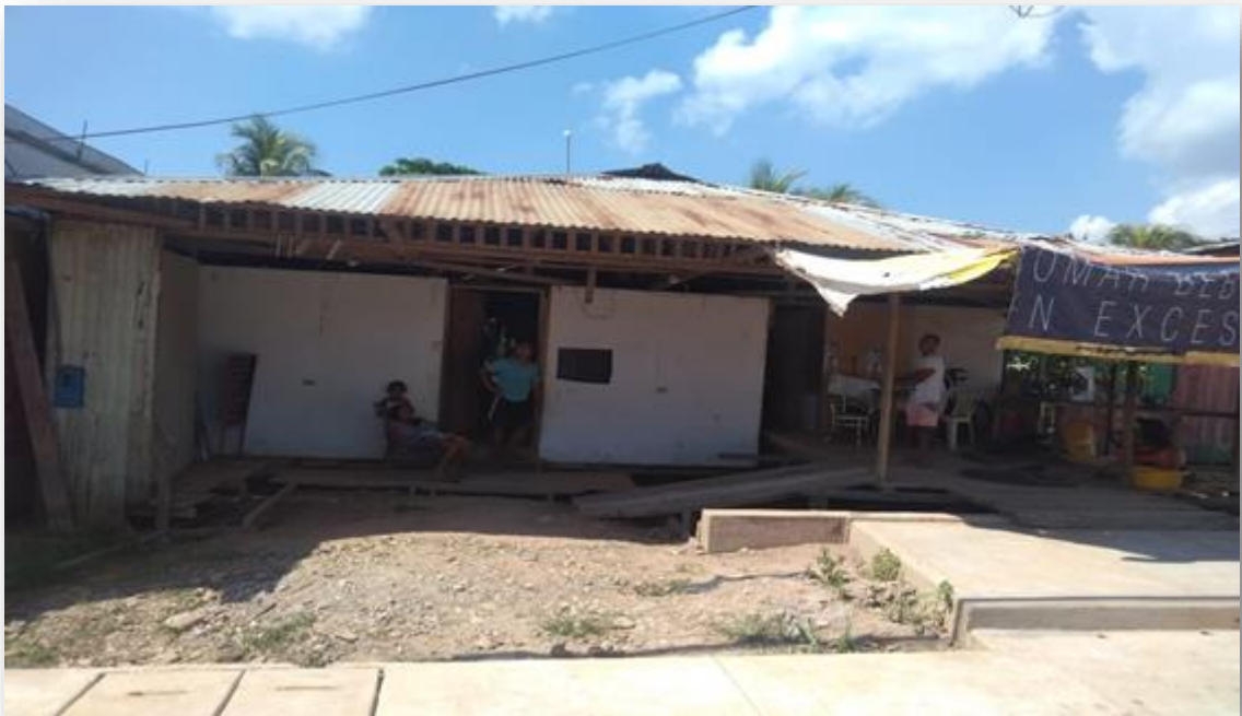
Fotografía N° 6. Vivienda construida sobre el cauce de la quebrada natural.
