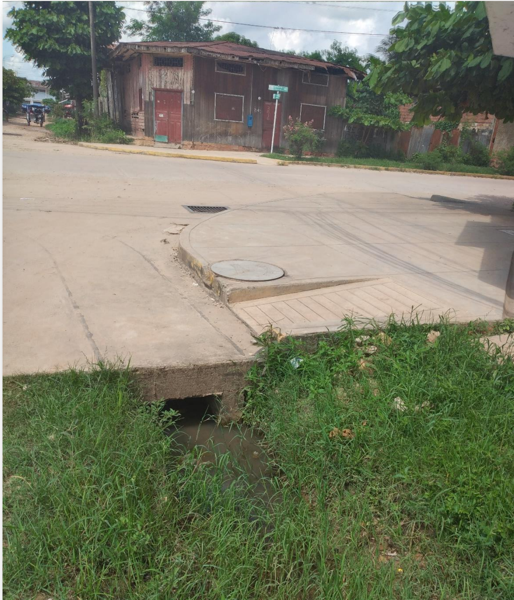
Fotografía N° 7. Canal subterráneo del cauce de la quebrada natural colmatado.
