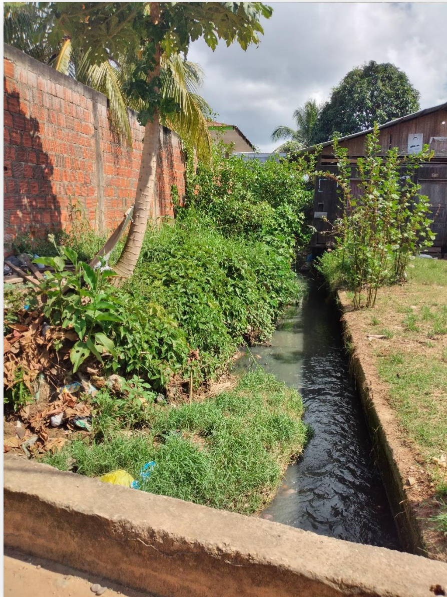
Fotografía N° 4. Cauce de la quebrada natural reducido por la vegetación y basura arrojada por los pobladores.
