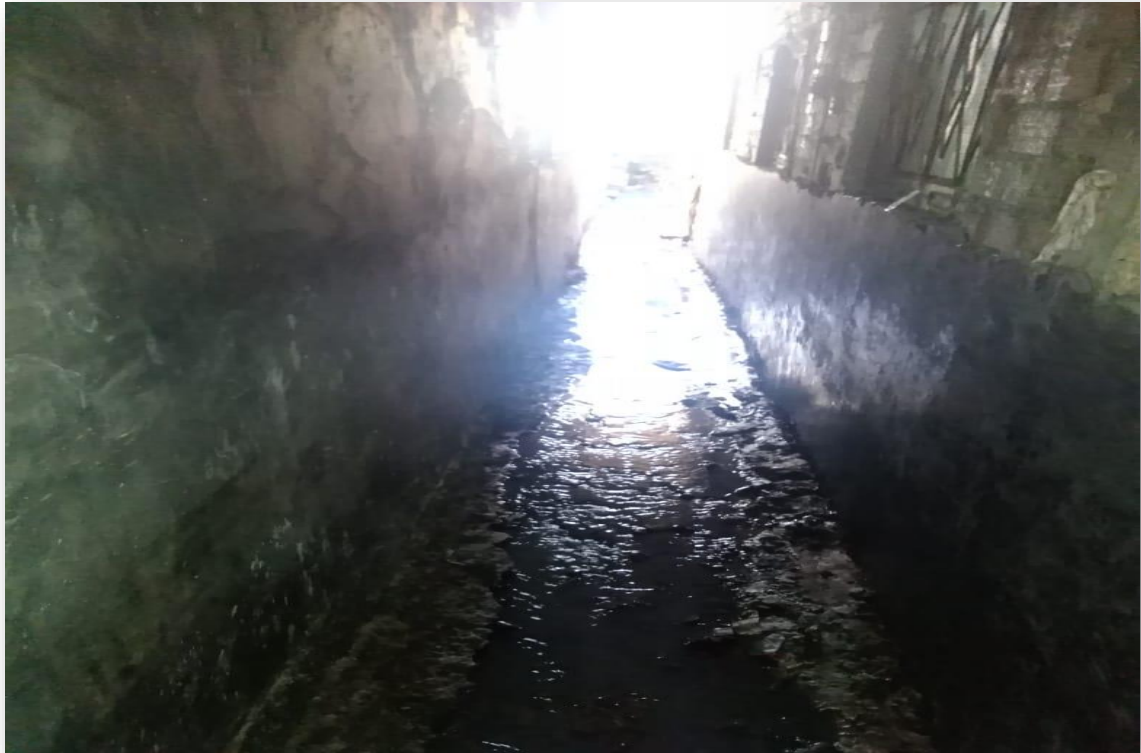
Fotografía N° 9. Cauce de la quebrada natural sobre el cual se ha construido una vivienda de material noble (dentro de la vivienda).
