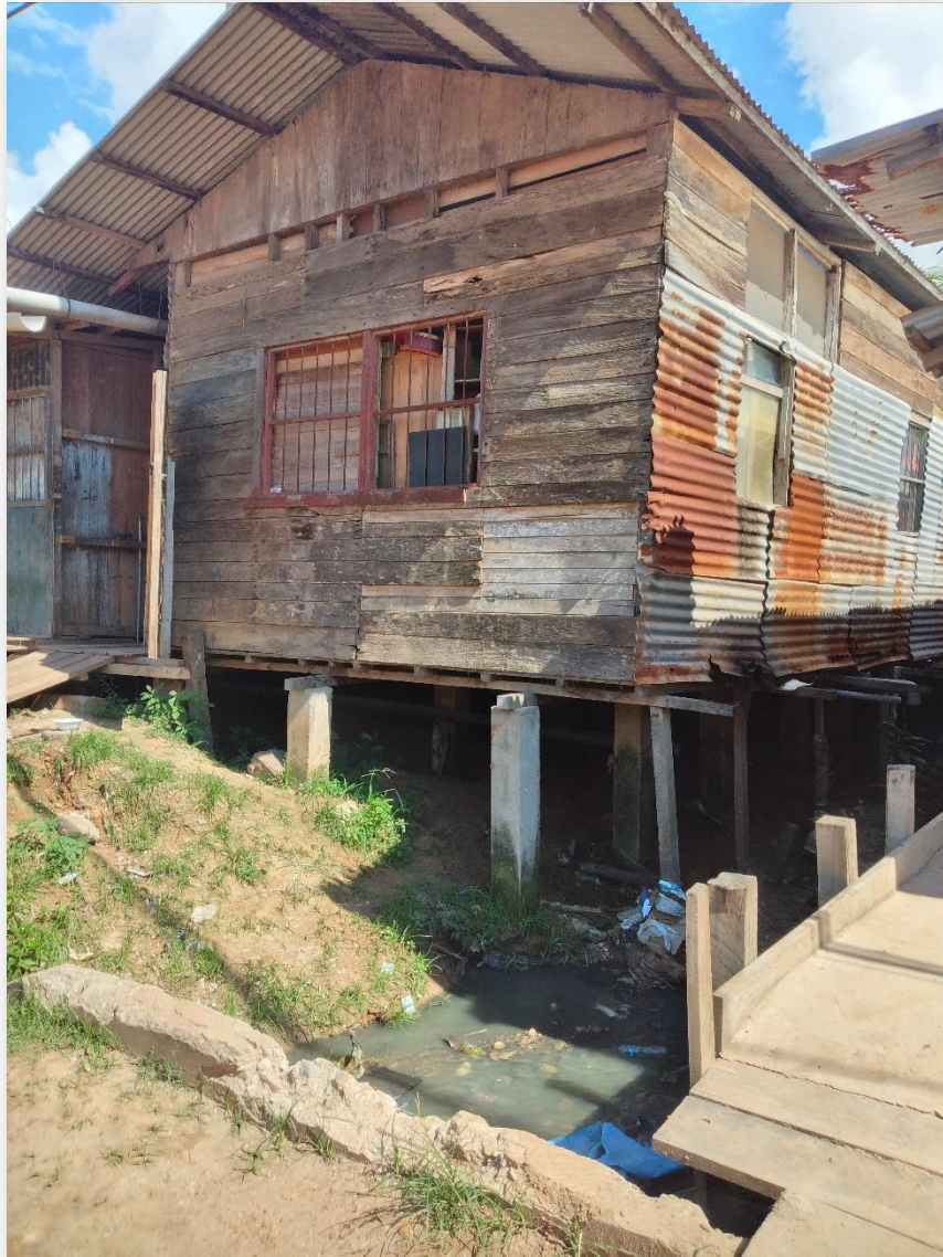
Fotografía N° 1. Vivienda ubicada sobre el cauce de la quebrada natural.
