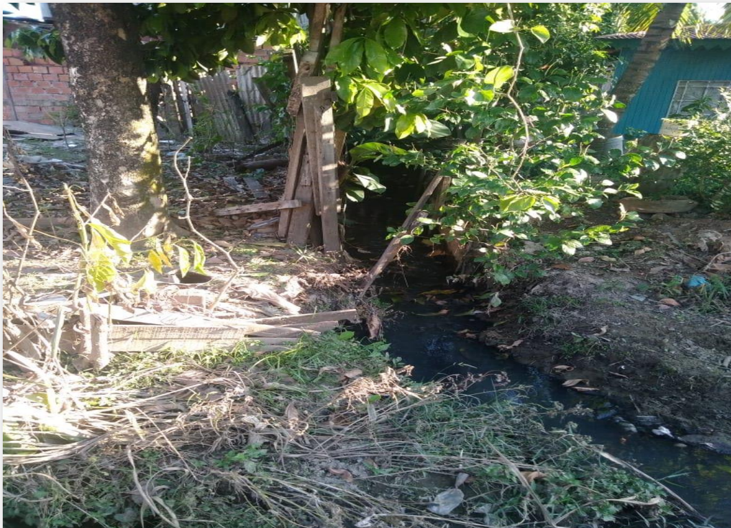
Fotografía N° 12. Cauce de la quebrada natural colmatado con vegetación.
