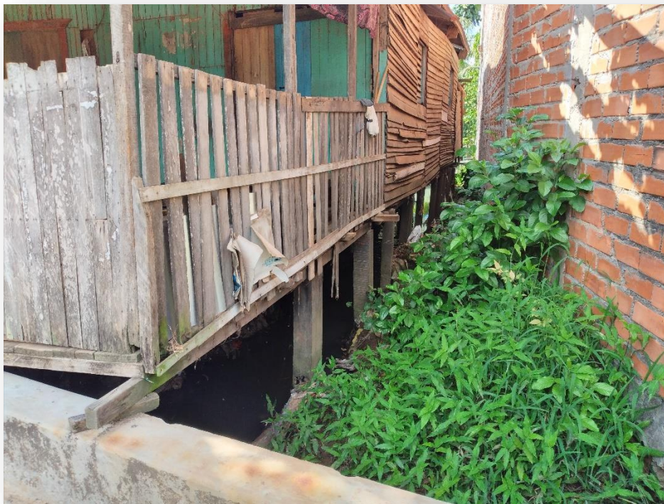
Fotografía N° 3. Vivienda ubicada sobre el cauce de la quebrada natural.
