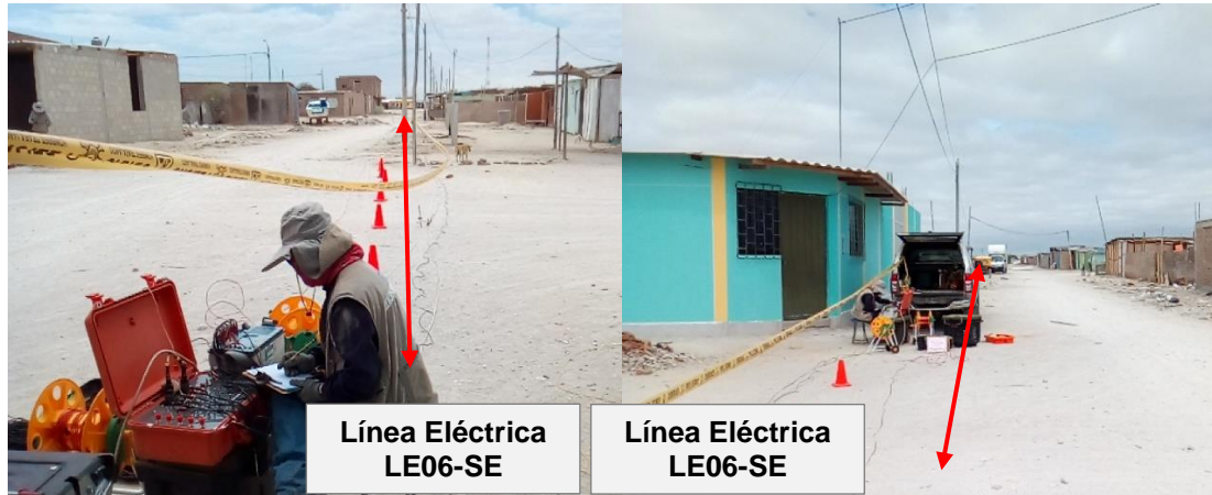
Figura 30: Vista de la línea eléctrica LE06-SE.
