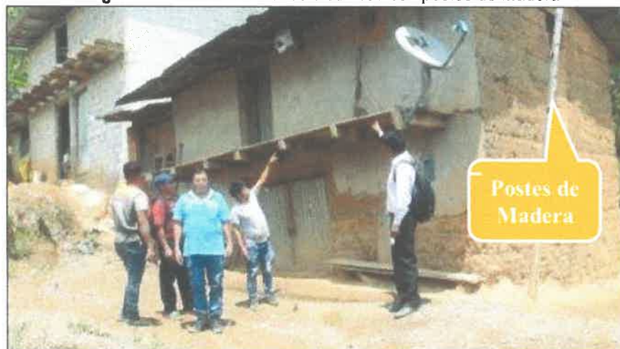
magen N° 2.10: Instalaciones eléctricas con postes de madera
