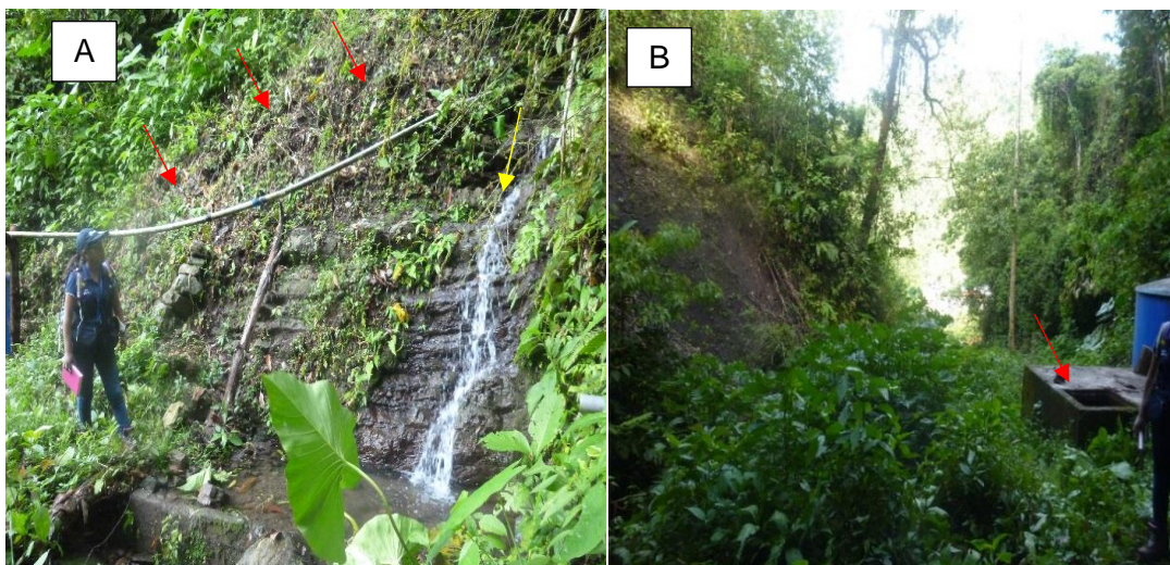
Figura 16. Erosión de ladera en la quebrada Remal, infiltración de agua que discurre de la parte alta, se observa reservorio de agua a la margen derecha aguas arriba de la quebrada, para el consumo de la población del puente Inambari.
