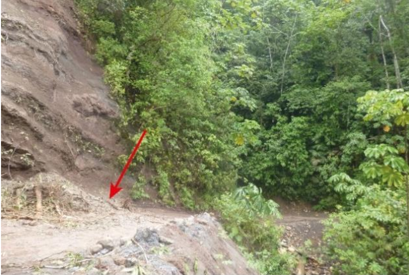
Figura 22. Se observa un derrumbe activo en el corte del talud de la carretera.
