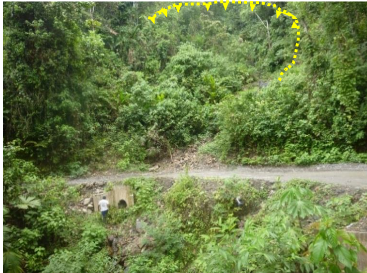
Figura 20. Vista con dirección suroeste, se observa un deslizamiento que cubrió la quebrada escuela ubicado a la margen izquierda del río Inambari.
