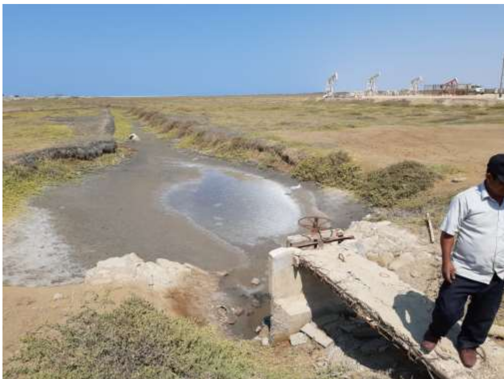
Ilustración 8: Daño a la infraestructura del dique en la desembocadura del rio chira, sector la bocana de Colan
