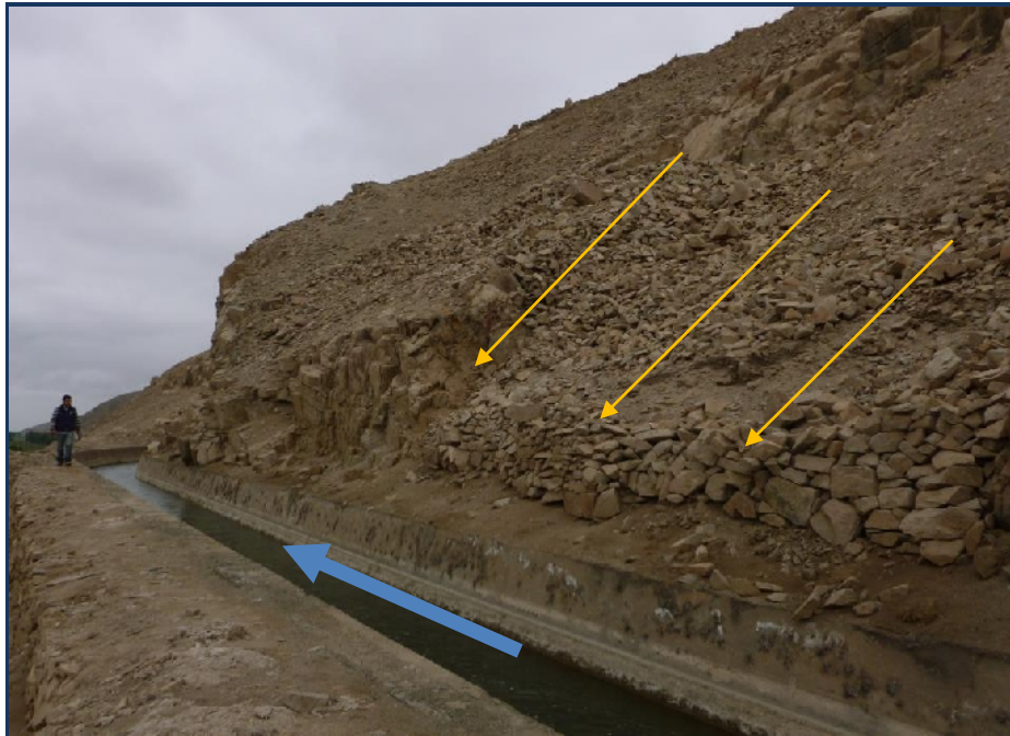
Figura 44: Cerro Yamayo y desprendimiento de rocas fracturadas dentro del canal de regadío
