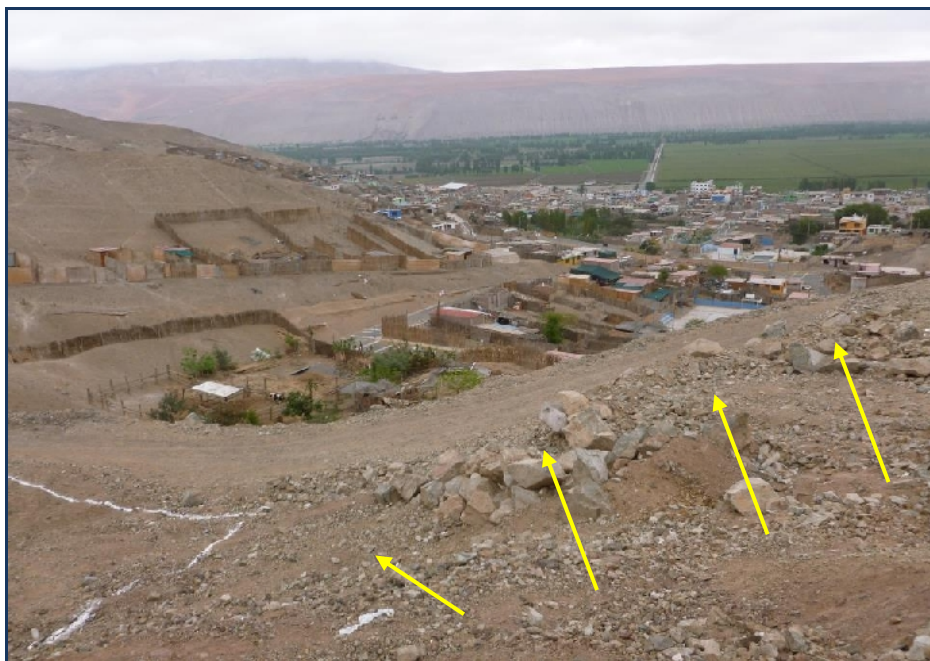
Figura 45: Las líneas indican la dirección de los derrumbes que ponen en riesgo a la Asoc. San Isidro.
