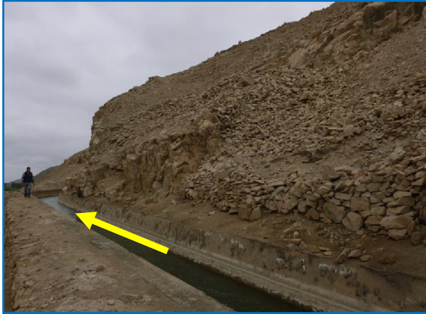
Figura 35: Canal de agua afectado continuamente por caída de rocas
