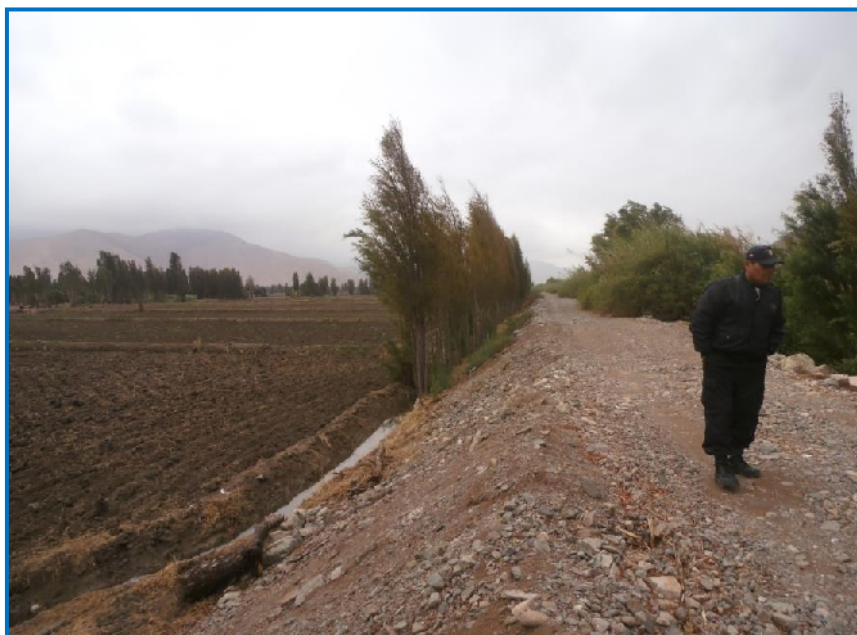
Figura 48: Margen derecha del río Tambo con defensas ribereñas que no alcanzan más de 2.5 metros de altura; por tanto, son proclives al desborde.
