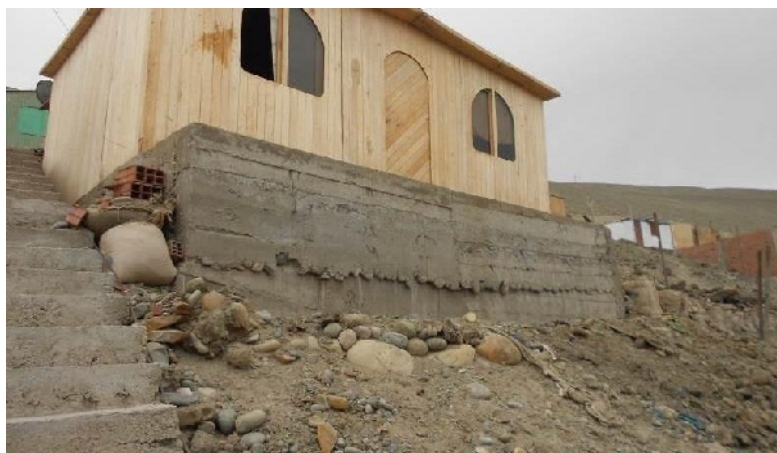
Figura 44: Viviendas autoconstruidas sobre el talud inestable, AAHH Alto Túpac.
