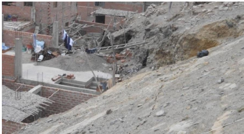
Figura 43: Escombros vertidos sobre las viviendas ubicadas en la parte baja del AAHH Alto Túpac. En las laderas se puede observar la presencia de grietas de hasta 5 cm de ancho.
