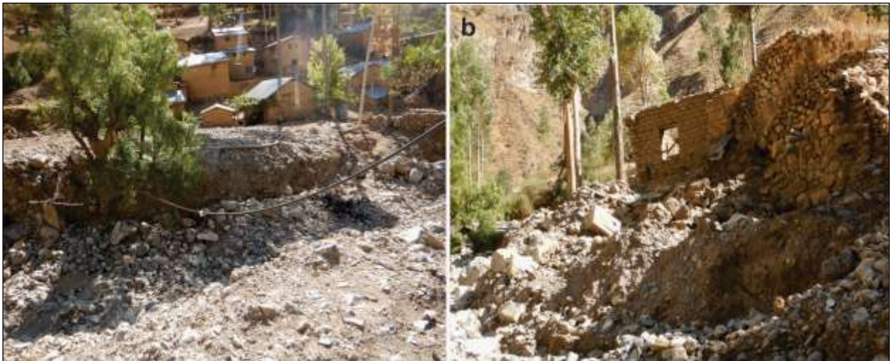
Figura 14. Vista donde se observa: a) tubería del agua potable, que actualmente fue repuesta; b) tapa de concreto de desagüe destruida.
