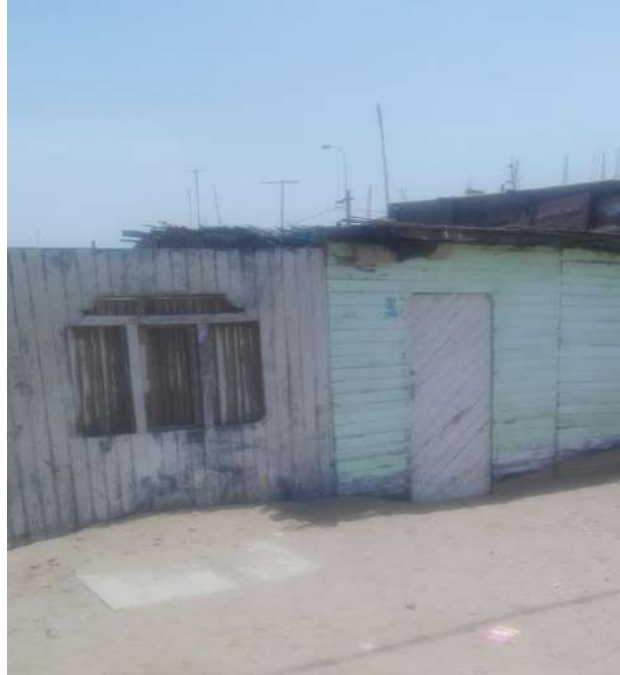
Fotografía N° 7. Vivienda de material precario, no tienen cimiento fijo.
