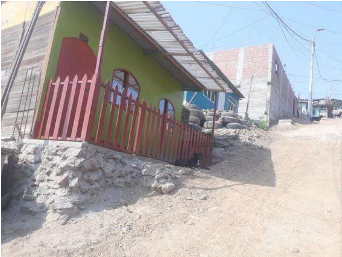
Fotografía N° 4. Viviendas construidas sin control técnico, al fondo se observa una construcción de material noble que no tiene continuidad de sus elementos estructurales verticales (columnas). Asimismo, no cuenta con arriostamiento entre viga y columna, éste que frente a un sismo de gran magnitud colapsaría.
