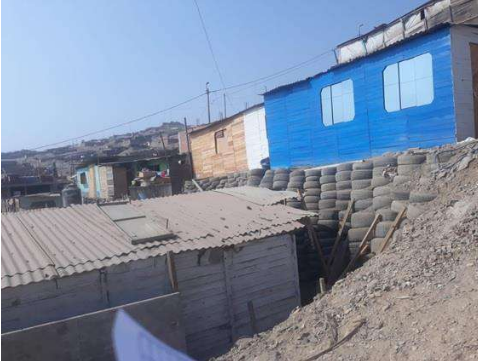
Fotografía N° 5. Viviendas de material precario, con cimiento de llantas.
