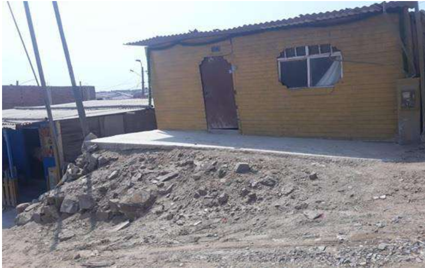
Fotografía N° 1. Vivienda de material precario, se encuentra inclinada.
