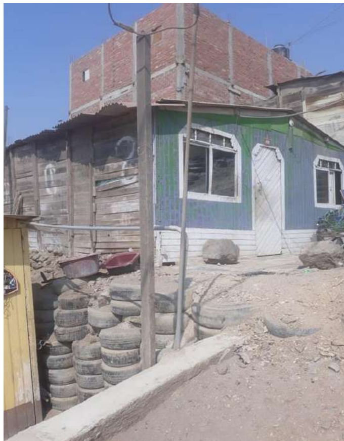
Fotografía N° 6. Viviendas de material precario, con base de llantas y arena.
