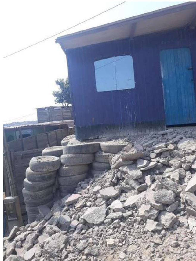
Fotografía N° 2. Viviendas de material precario, con cimiento de llantas.
