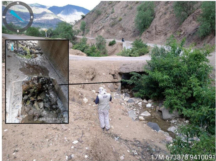
Fotografía 11: Pontón ubicado en la vía Sondorillo - Huancabamba que ha sido erosionada en la base de dicha estructura.
