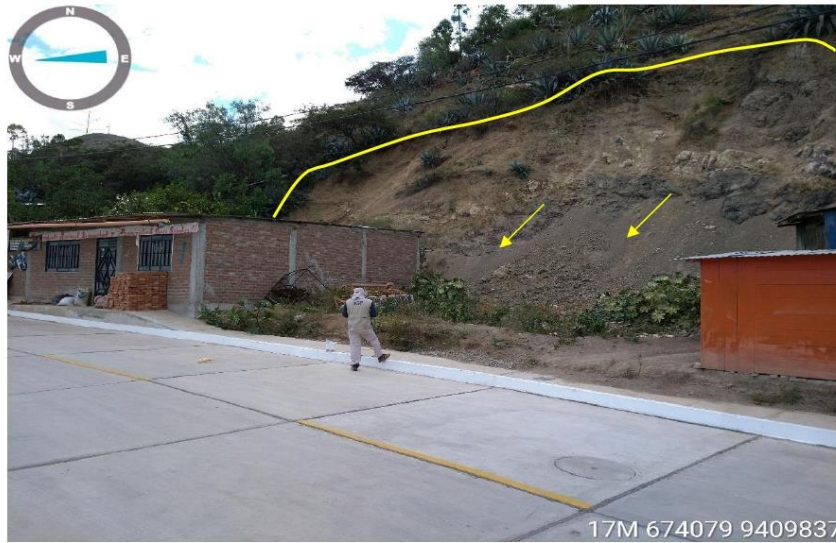
Fotografía 6: Derrumbes de materiales coluviales y afloramientos dacíticos ubicados sobre taludes modificados para el emplazamiento de viviendas. Los materiales desprendidos se ubican detrás de viviendas existentes.
