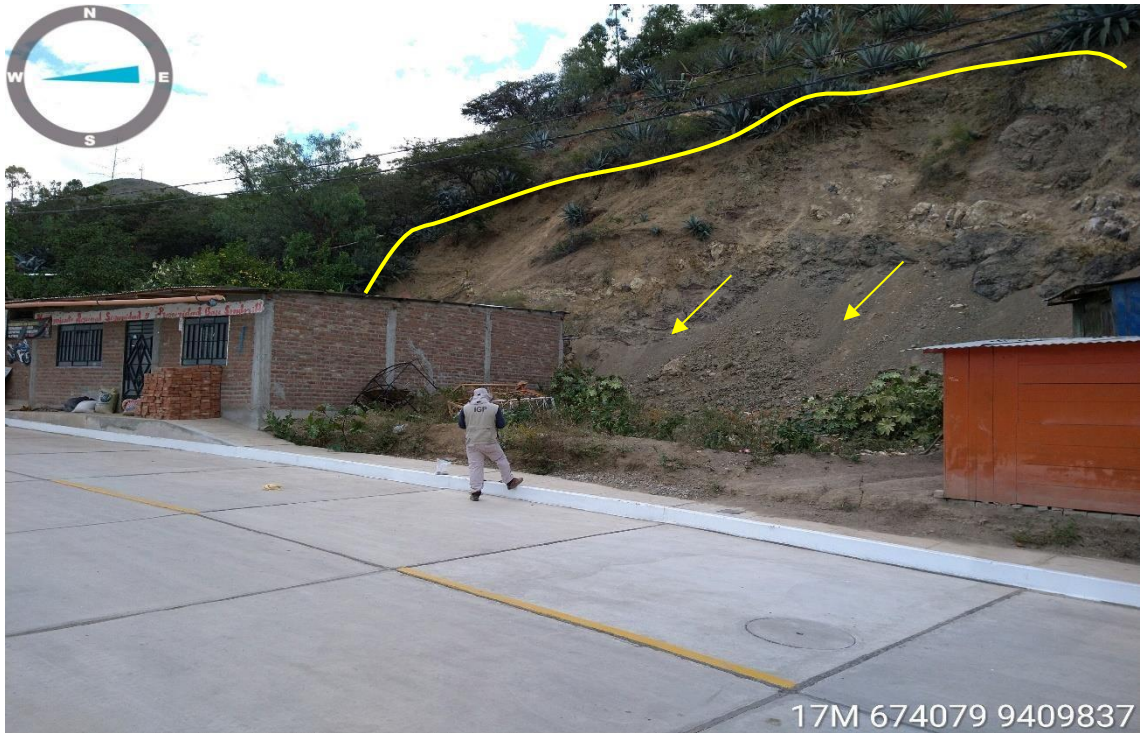
Fotografía 02: Derrumbes de materiales coluviales y afloramientos dacíticos ubicados sobre taludes modificados para el emplazamiento de viviendas. Los materiales desprendidos se ubican detrás de viviendas existentes.
