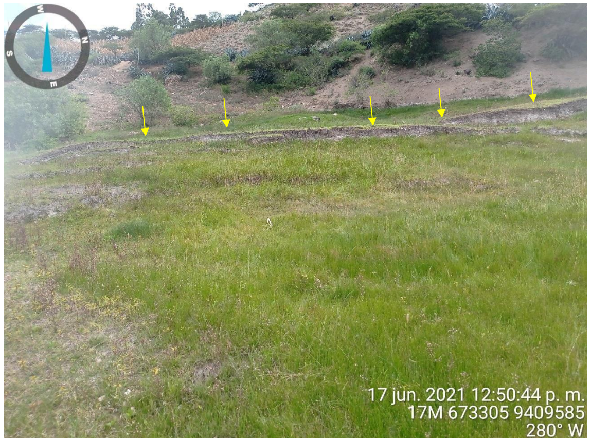
Fotografía 04: Ladera afectada por reptación de suelos en la cual se ha identificado grieta (debajo de flecha amarilla) en el suelo de 10 cm de salto en zonas saturadas por flujos de agua.
