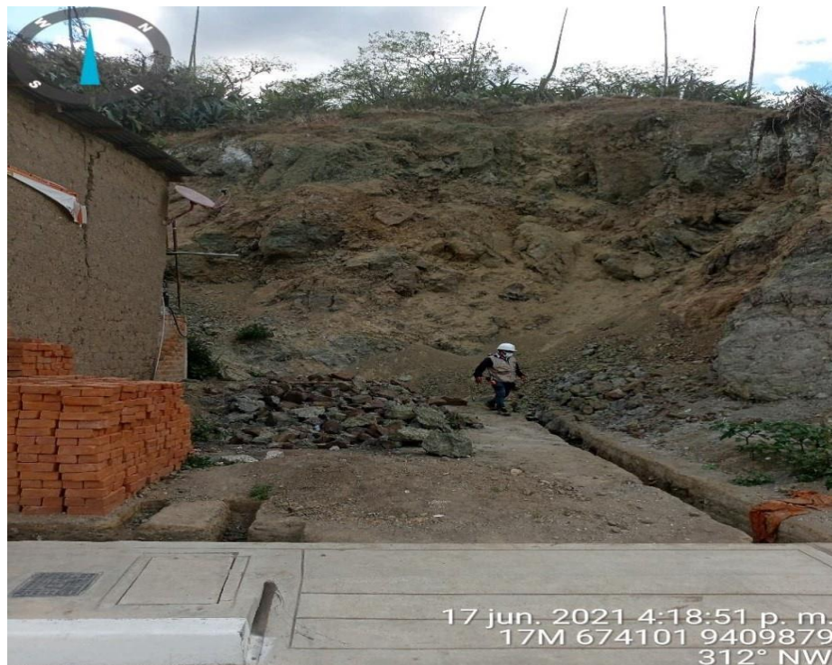
Fotografía 03: Caída de rocas (piroclastos andesíticos y dacíticos) que conforma taludes inestables que podrían afectar viviendas.
