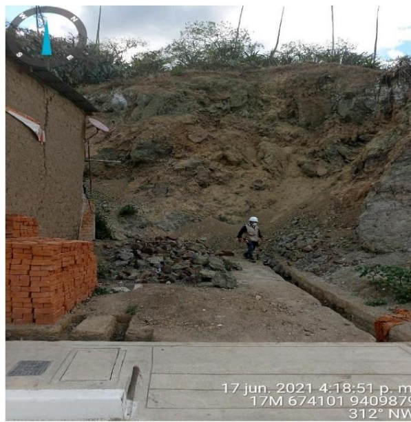
Fotografía 7: Caída de rocas (piroclastos andesíticos y dacíticos) que conforman taludes inestables que podrían afectar viviendas.
