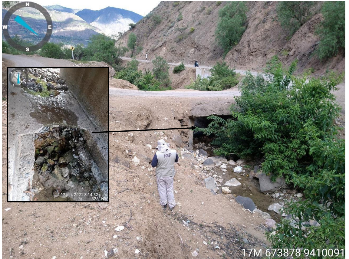
Fotografía 07: Pontón ubicado en la vía Sondorillo – Huancabamba que ha sido erosionada en la base de dicha estructura.
