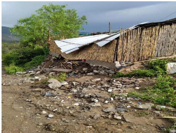
fotografía 02: vivienda afectada por deslizamiento, debido a las lluvias intensas en el Distrito de Sondorillo.
