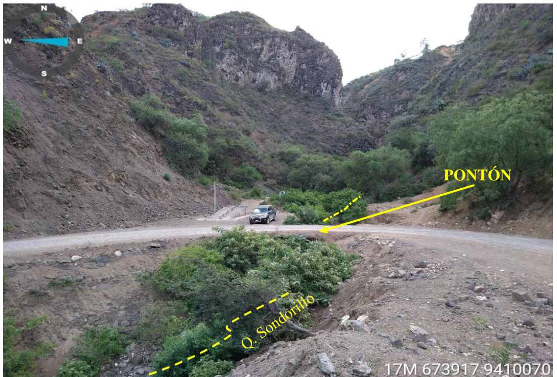
Fotografía 06: Cauze de la quebrada Sondorillo que fluye oeste a este, durante su recorrido se encuentra erosionando el pontón ubicado debajo de la vía Sondorillo – Huancabamba.
