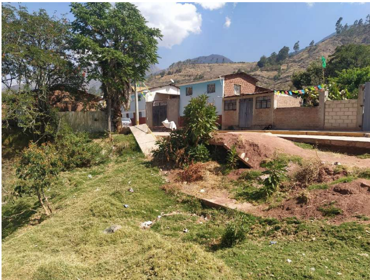
Fotografía 3. 05 metros de veredas colapsadas por erosión de aguas en la base de la infraestructura.
