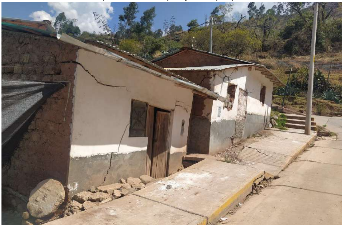
Fotografía 2. Viviendas agrietadas e inhabitables en el sector de Pajchicucho.
