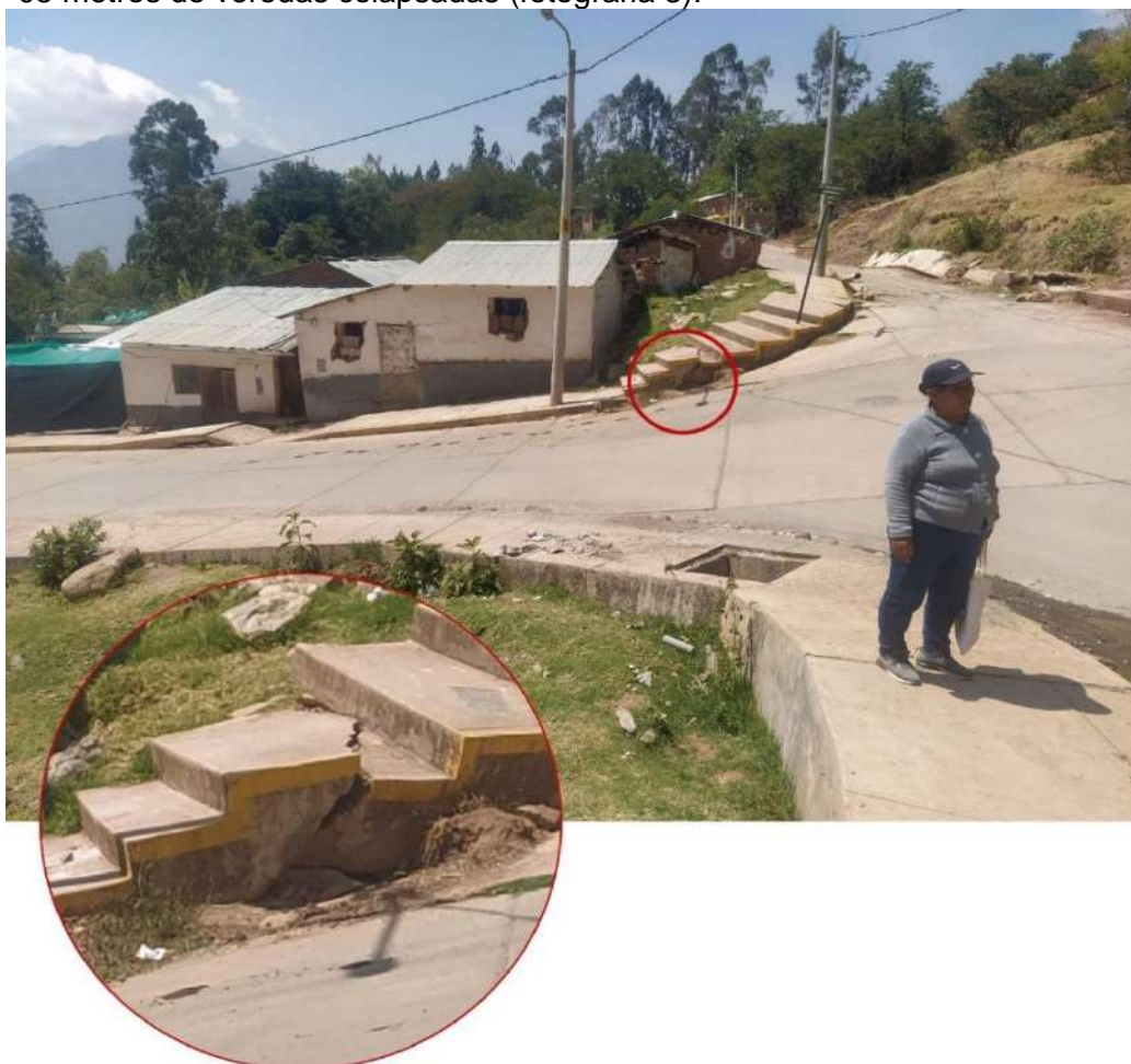
Figura 29. Se observan dos viviendas agrietadas, daños en la vía principal y veredas en el sector de Pajchicucho.
