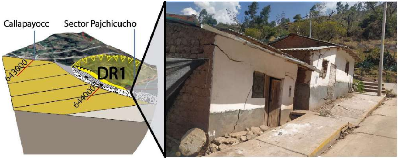
Viviendas inhabitables en el pie del deslizamiento reactivado
