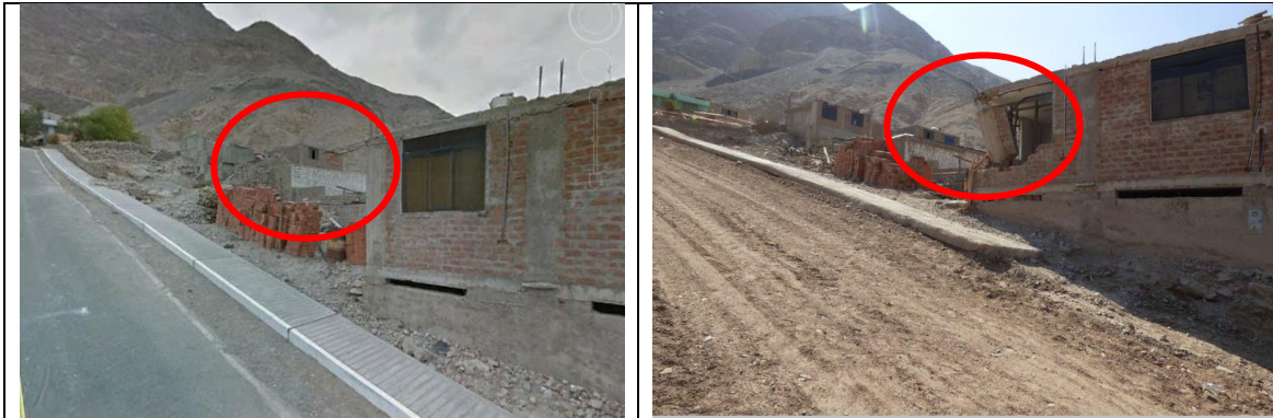
Imagen 68: Vivienda afectada por el flujo de detritos. Izquierda, vista de la derecha correspondiente al año 2014.
