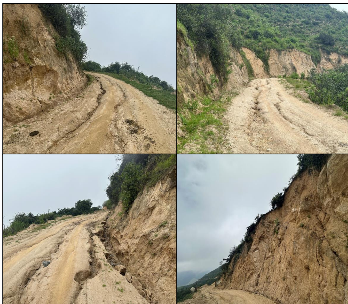
Figura 64. Afectaciones en la Carretera AN-1077 Tramo 1
