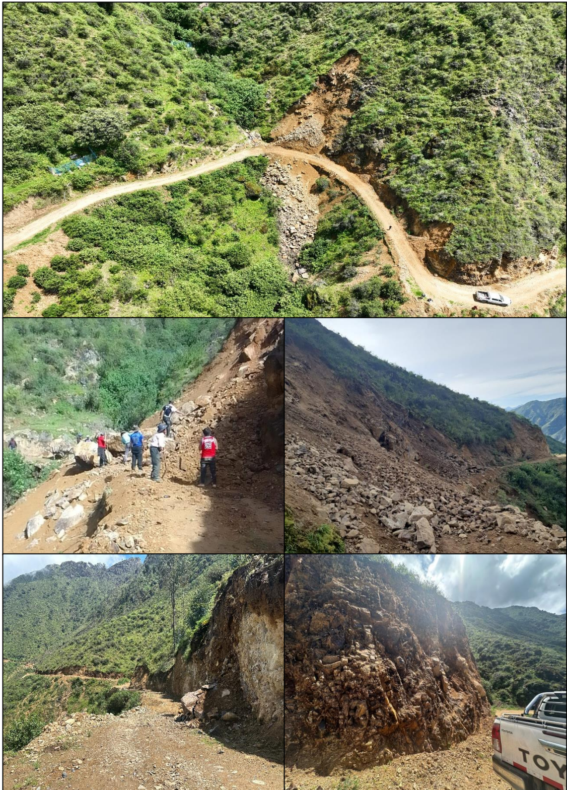
Figura 56. Talud más crítico y afectación de accesos – taludes intensamente alterados y fracturados
