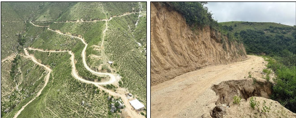
Figura 83. Carreteras y accesos expuestos a movimientos en masa
