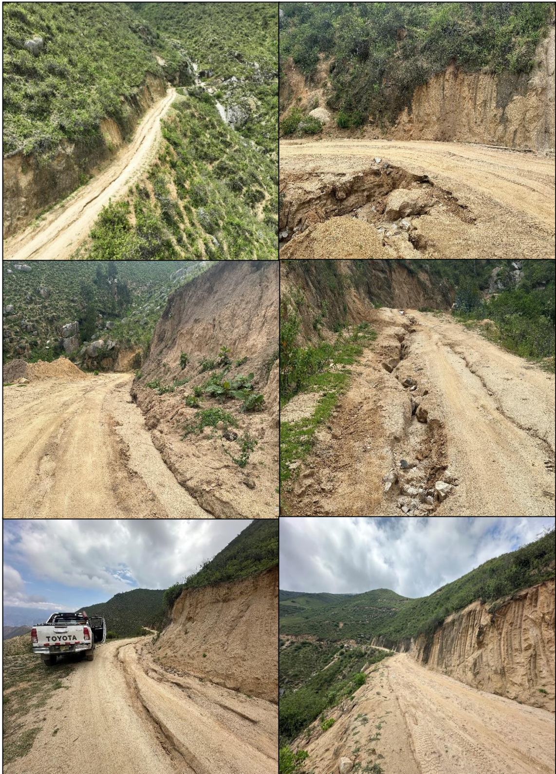
Figura 68. Afectaciones en la Carretera AN-1077 Tramo 3
