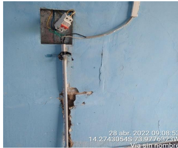
Ilustración 3: conexiones eléctricas en el distrito de Aucará
