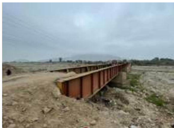
CP. Pirca – Deslizamiento – reptación de suelo
