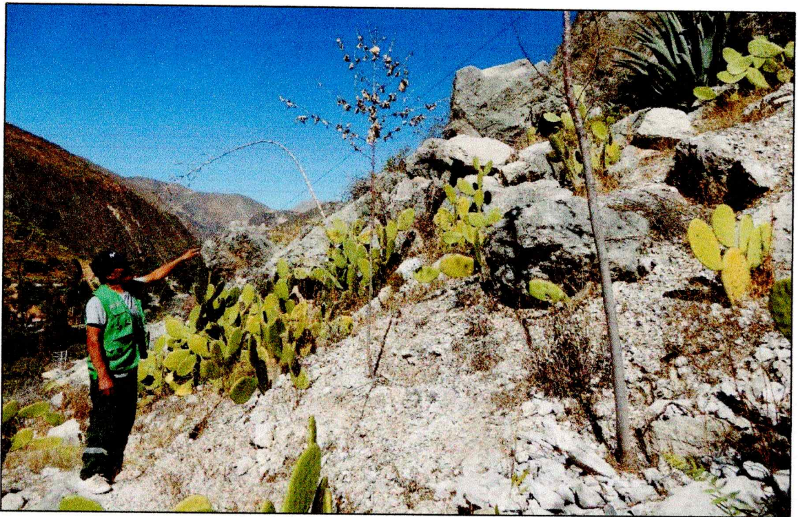
FOTOGRAFIA 4: VISTA DE DEPÓSITO COLUVIAL (Q-C), FORMADO POR BLOQUES DE ROCA DE HASTA 2.0 M DE DIÁMETRO, CONFORMAN TALUDES DE REPOSO POCO ESTABLES. COORDENADAS REFERENCIALES UTM WGS-84, 18S: E: 500408; N: 8617972
