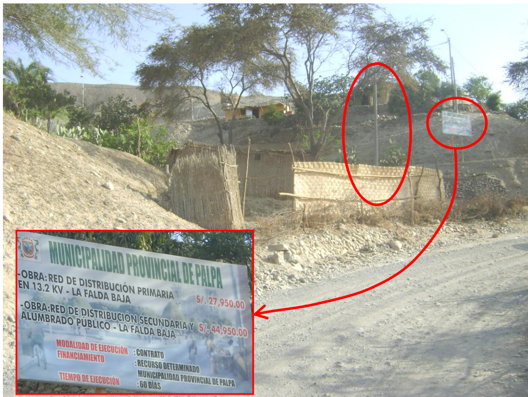
Se observa un cerco construido en el cauce de la quebrada, cerrando el flujo. Además se observa un poste de luz en la mitad del cauce.
