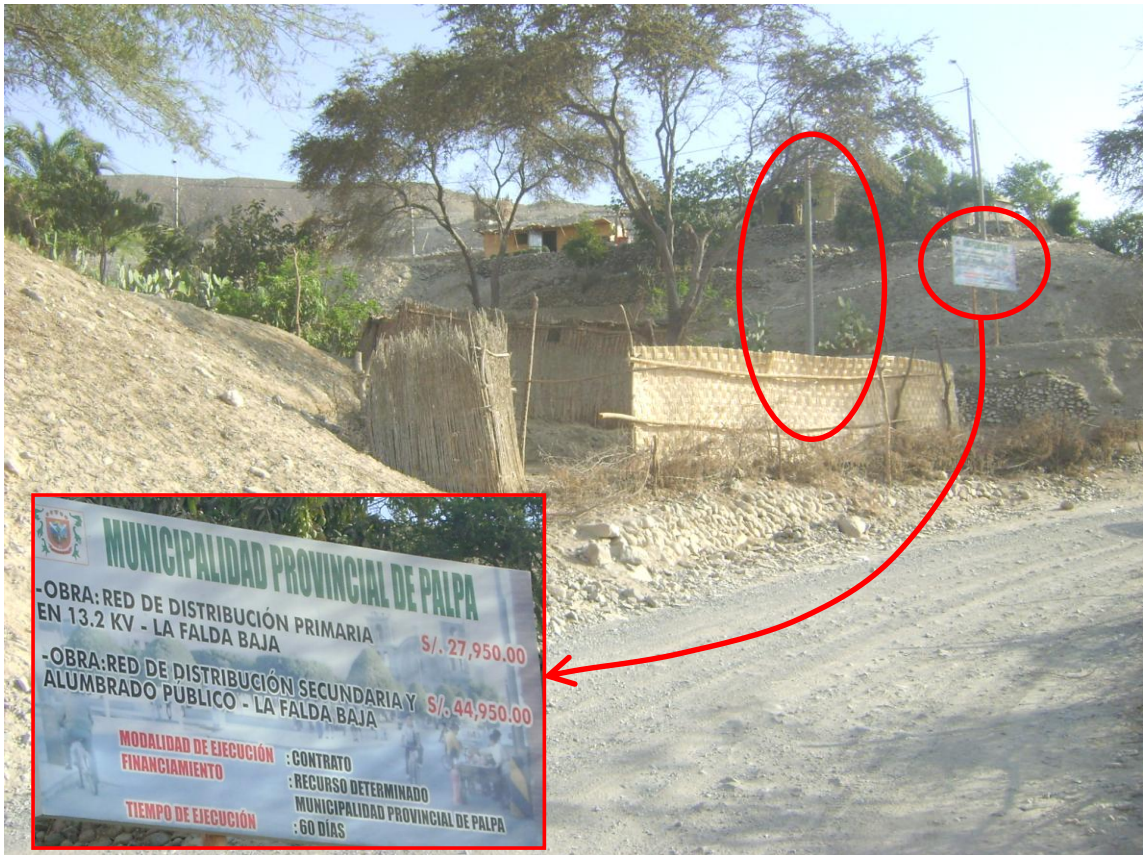
Se observa un cerco construido en el cauce de la quebrada, cerrando el flujo. Además se observa un poste de luz en la mitad del cauce.
