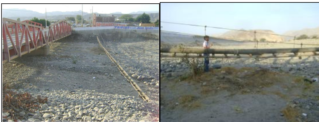
En las dos imágenes se muestra el cauce del río Viscas. Izquierda, se observa el Puente Vehicular de la Panamericana Sur, en la misma foto a la derecha se muestra una tubería que corresponde al emisor de aguas servidas, proveniente de los AA. HH. San Ignacio y La Falda. Derecha, se muestra la altura por encima del cauce, a la que se encuentra el emisor (Aproximadamente 0.50 m), constituyendo un peligro inminente de colapso.
