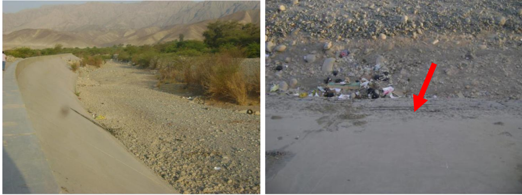
Izquierda, se muestra la defensa ribereña sobre de concreto armado en la margen derecha del río Viscas, aguas arriba de la Panamericana. Derecha, se muestra una imagen focalizada de los daños de erosión y abrasión de la defensa ribereña. Estos daños deben ser reparados a la brevedad del caso para preservar la defensa.
